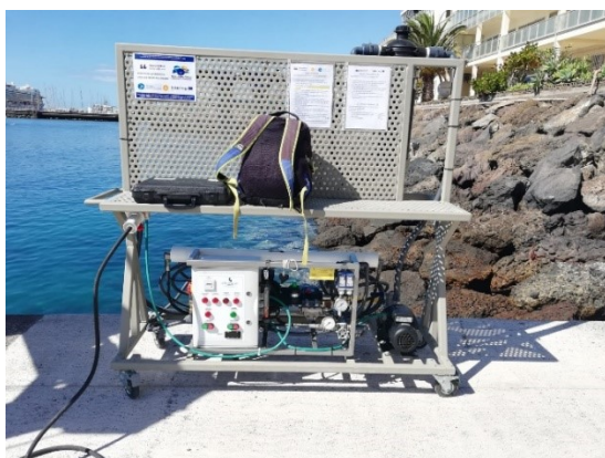
Imagen 4.4. Planta ósmosis inversa
