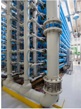
Figura 22. Sala de màquines de la IDAM de Sant Antoni, a Eivissa
