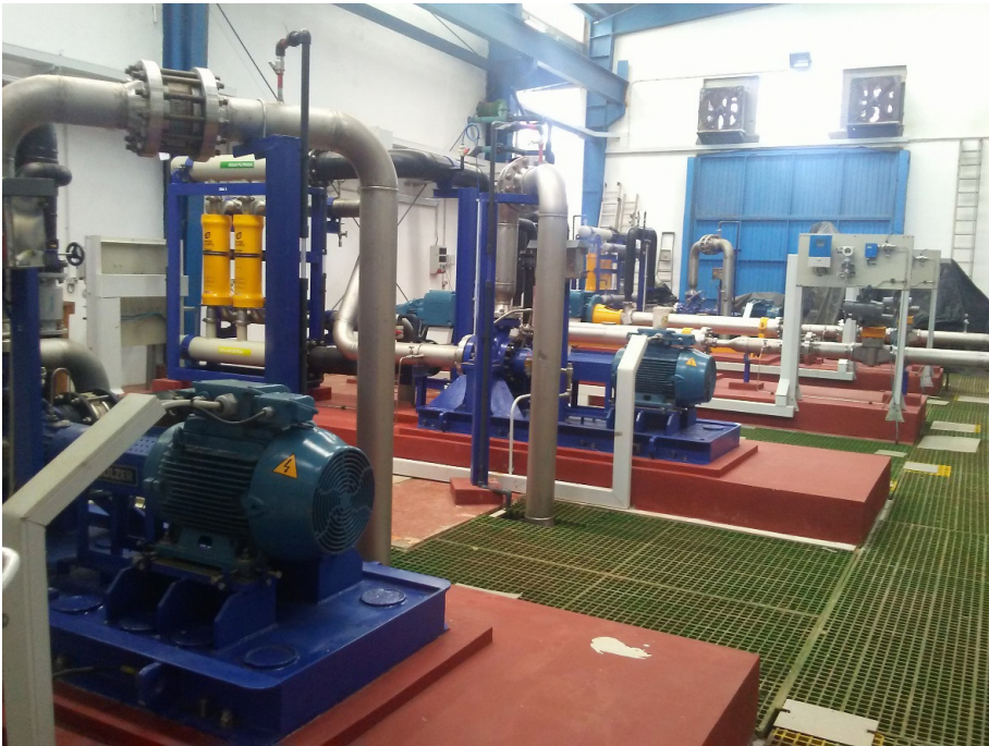
Figura 24. Sala de màquines de la IDAM de Formentera
