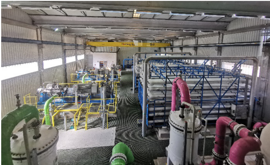
Figura 13. Sala de màquines de la IDAM d'Alcúdia
