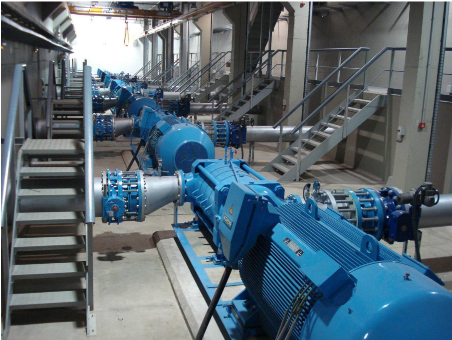
Figura 25. Sala de màquines del bombament de sa Costera
