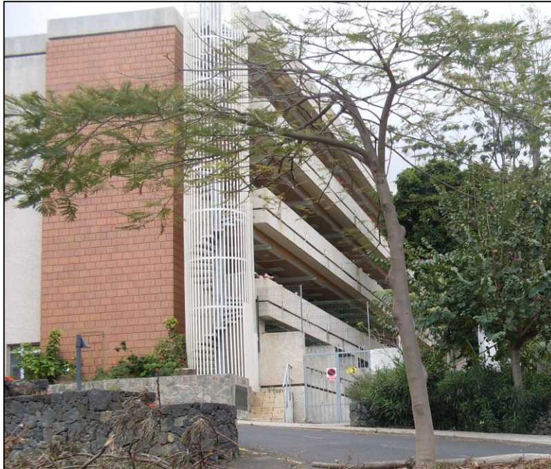
Imagen 15. Escalera de evacuación del Hotel LTI Chiripa Garden
