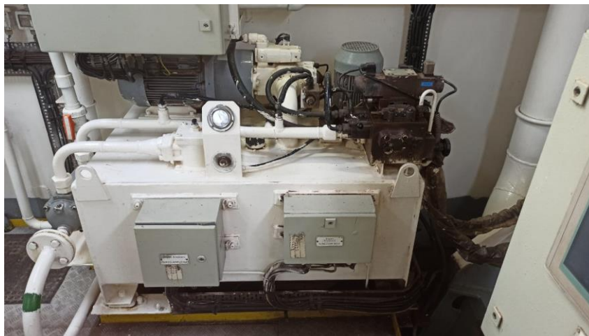
Ilustración 25. Central de Hidráulica de Estabilizadores. Fuente: Trabajo de Campo
