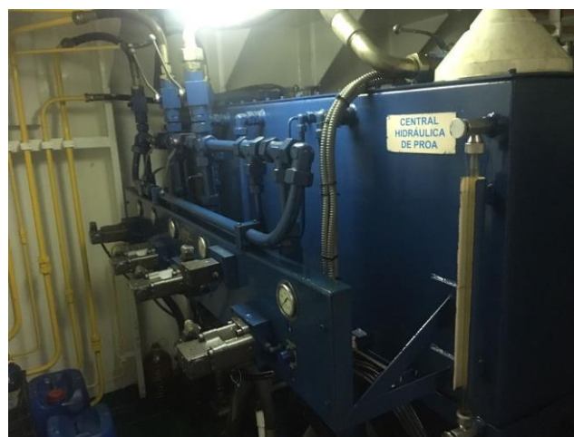
Ilustración 40. Central Hidráulica de Proa. Fuente: Trabajo de Campo
