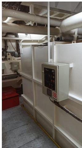
Ilustración 28. Planta Séptica. Fuente: Trabajo de Campo
