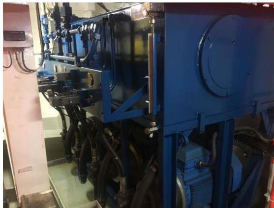
Ilustración 41. Central Hidráulica de Popa. Fuente: Trabajo de Campo
