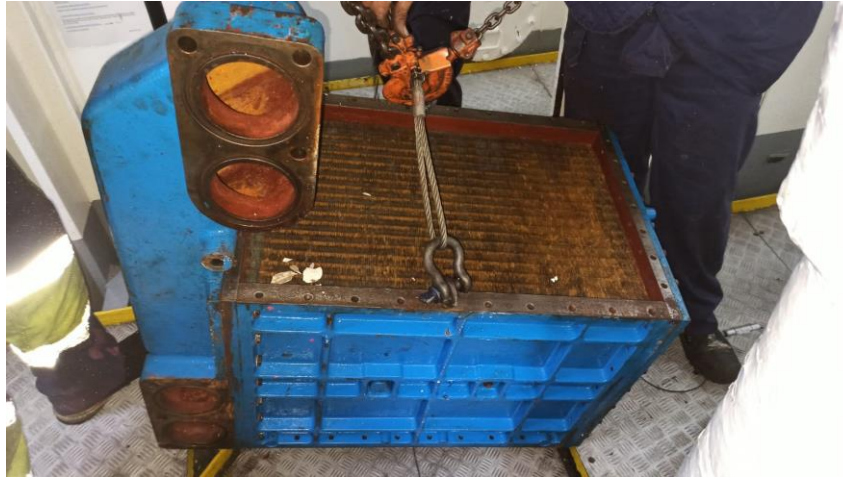
Ilustración 84. Enfriador Reparado. Fuente: Trabajo de Campo
