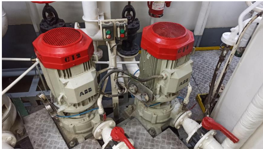
Ilustración 22. Bombas C.I. Fuente: Trabajo de Campo
