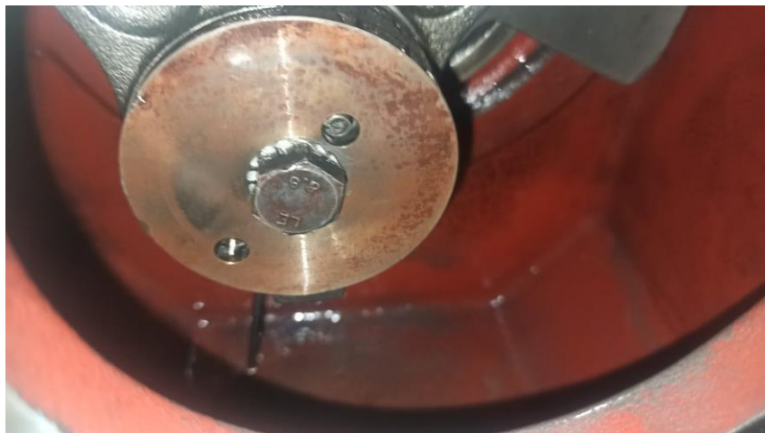
Ilustración 66. Inspección Carter compresor. Fuente: Trabajo de Campo
