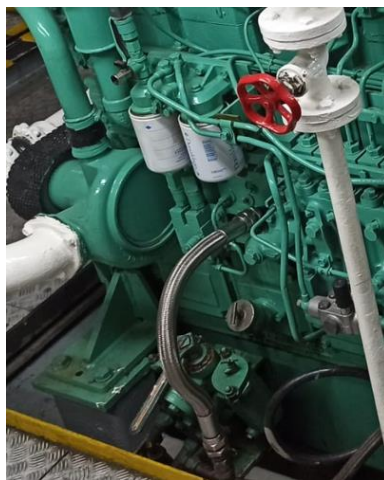
Ilustración 60. Filtros de Combustible del Motor Auxiliar. Fuente: Trabajo de Campo
