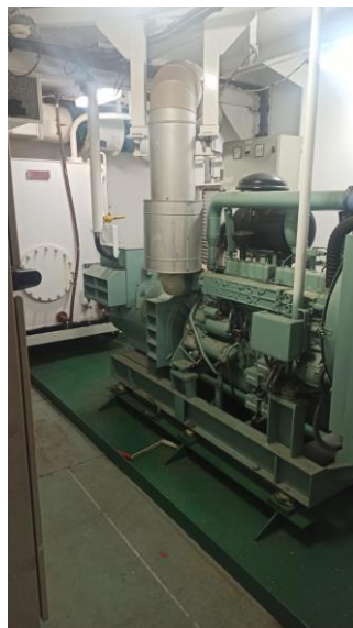
Ilustración 38. Motor de Emergencia. Fuente: Trabajo de Campo
