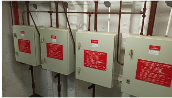
Ilustración 37. Cajas de Distribución de Co2. Fuente: Trabajo de Campo
