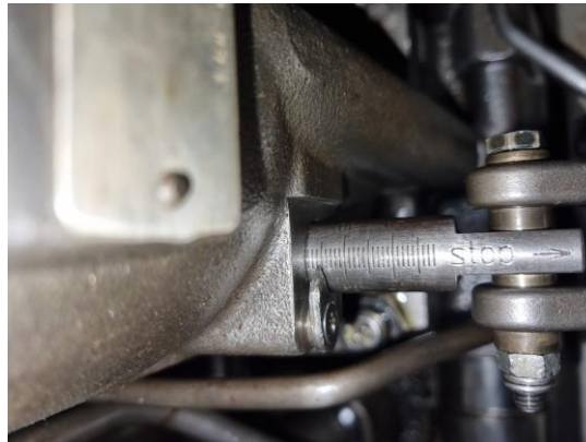
Ilustración 82. Medición de Cremalleras. Fuente: Trabajo de Campo
