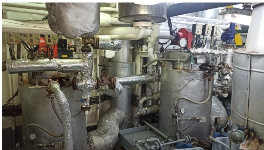
Ilustración 15. Calderas. Fuente: Trabajo de Campo
