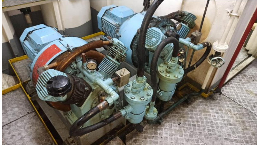
Ilustración 23. Compresores de Aire Comprimido. Fuente: Trabajo de Campo
