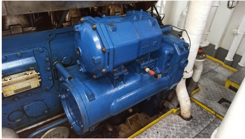
Ilustración 19. Filtro Automático y Enfriador de Aceite. Fuente: Trabajo de Campo
