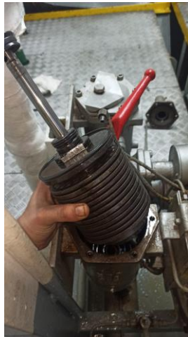
Ilustración 68. Filtro de Disparo Automático. Fuente: Trabajo de Campo
