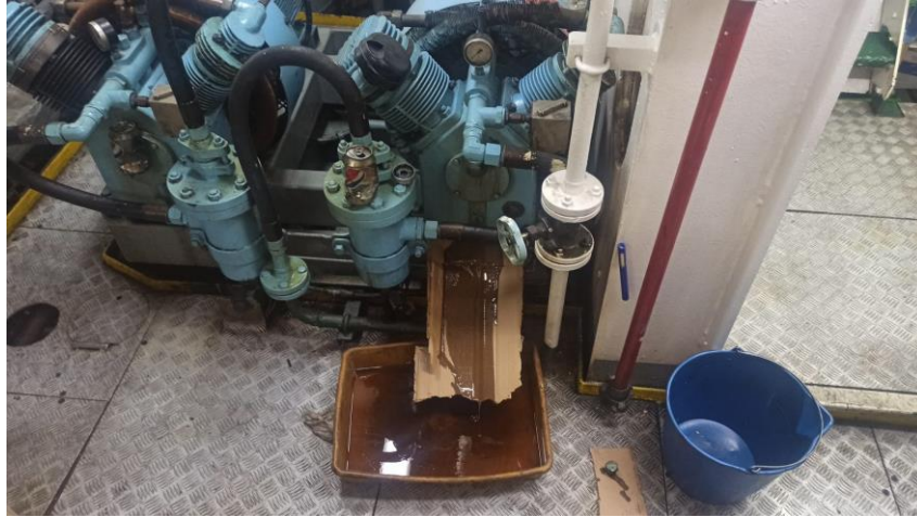
Ilustración 65. Cambio de Aceite Compresor. Fuente: Trabajo de Campo
