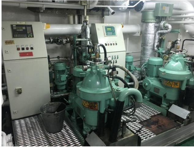
Ilustración 29. Depuradora de Fuel. Fuente: Trabajo de Campo
