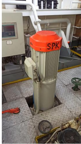
Ilustración 27. Bomba de Sprinklers. Fuente: Trabajo de Campo
