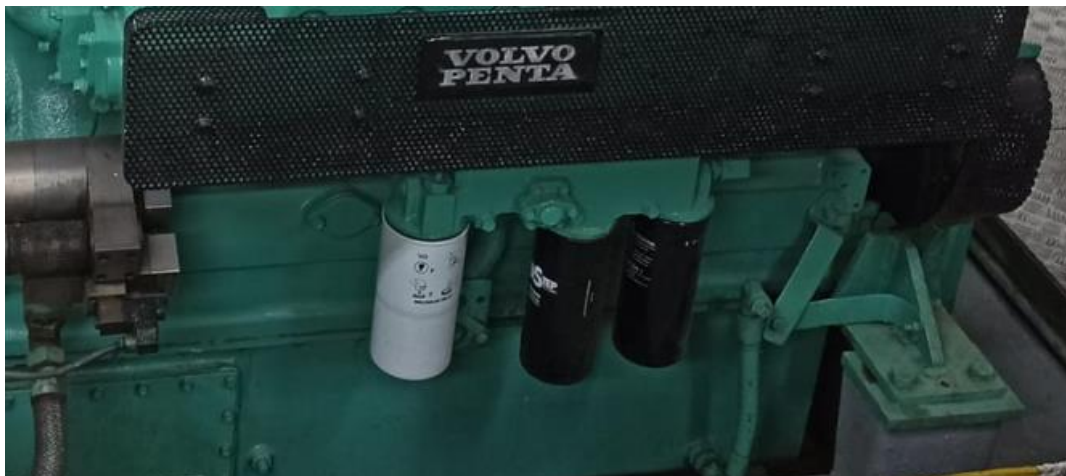
Ilustración 59. Filtro de Aceite del Motor Principal. Fuente: Trabajo de Campo
