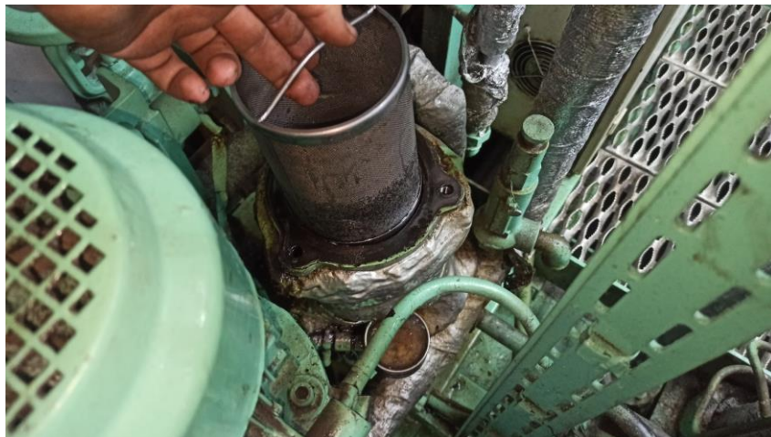
Ilustración 67. Filtros Módulo de Combustible. Fuente: Trabajo de Campo
