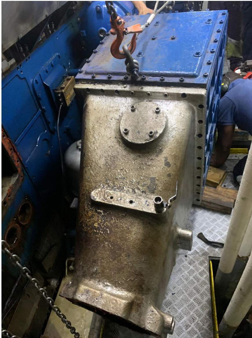
Ilustración 85. Enfriador Retirado. Fuente: Trabajo de Campo
