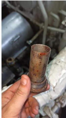
Ilustración 74. Filtros Pre calentadores. Fuente: Trabajo de Campo
