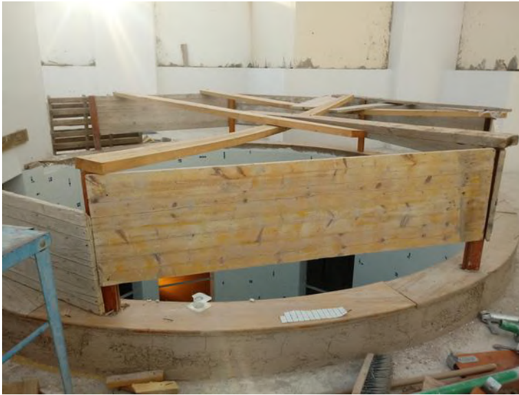
Fig 50 Vallados en cubierta hacia patio interior Fuente:propia
