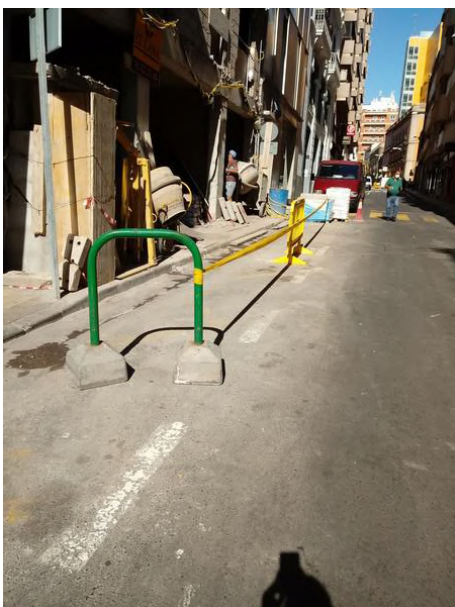
Fig 58 Señalización y vallado insuficientes Fuente:propia
