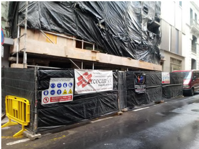
Fig 59 Vallado de obra con señalización. Fuente:propia
