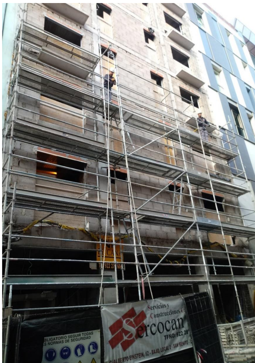
Fig 21 Andamio metálico Fuente: propia
