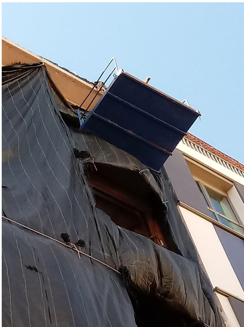
Fig 13 Plataforma de Descarga Fuente: propia
