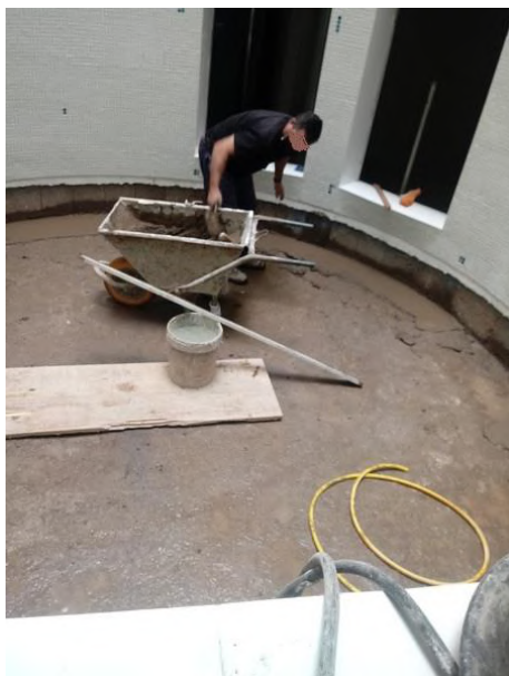
Fig 54 Operario sin casco ni guantes de seguridad Fuente:propia
