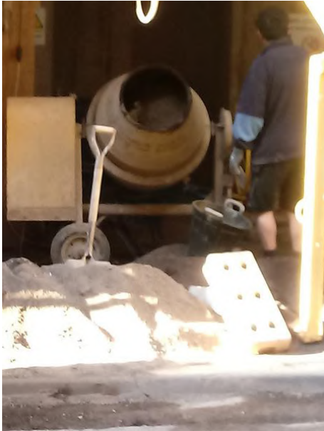
Fig 63 Acopios de arena que impiden el paso junto a un operario sin protecciones. Fuente:propia
