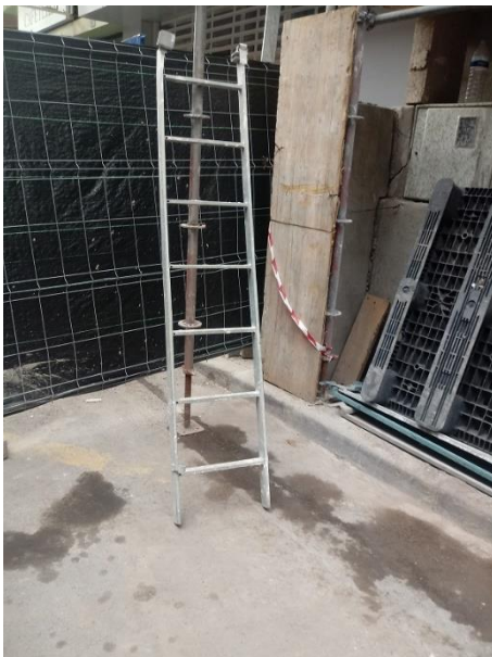
Fig 56 Escalera de mano sin zapatas antideslizante Fuente:propia
