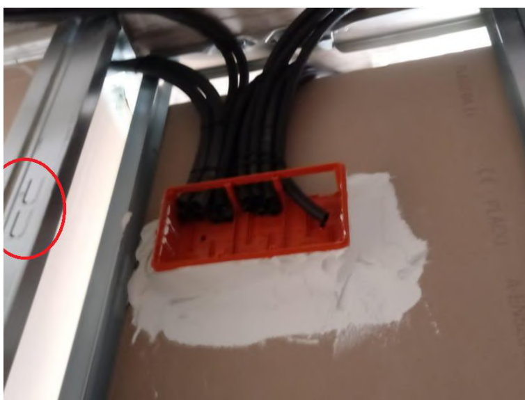
Fig 29 Montante colocado al revés
