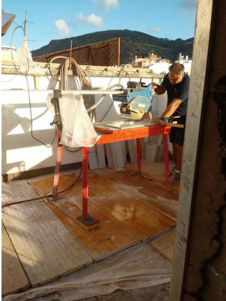
Fig 55 Operario haciendo uso de maquinaria de corte sin guantes ni protección auditiva Fuente:propia
