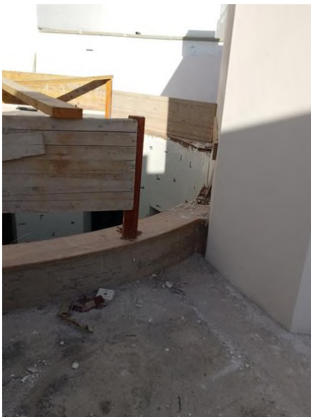
Fig 51 Ausencia de vallado Fuente:propia
