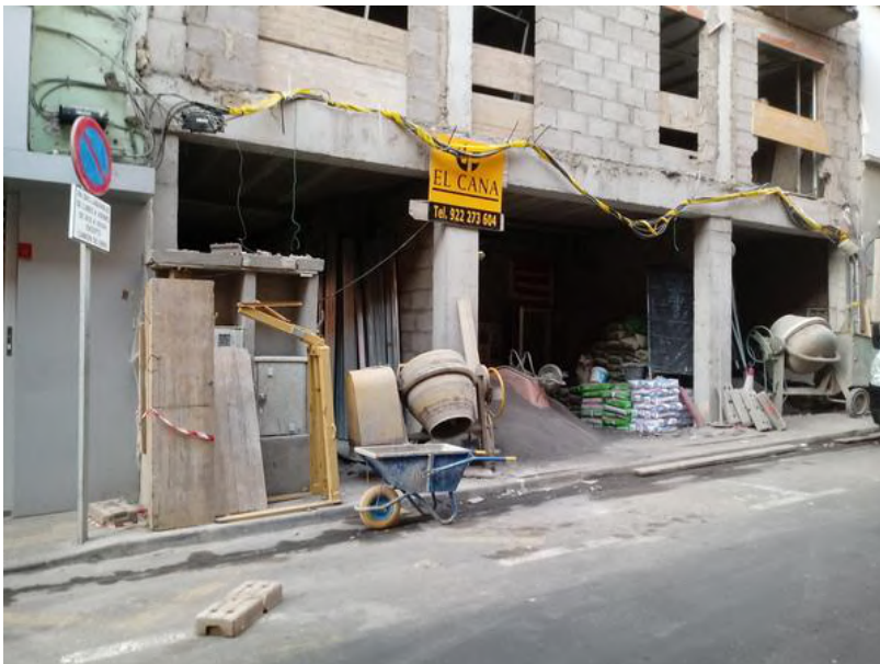
Fig 57 Ausencia de vallado en la obra Fuente:propia
