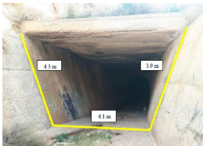
Figura 9. Solera y paredes del canal trapezoidal en el comienzo del soterramiento del cauce.
