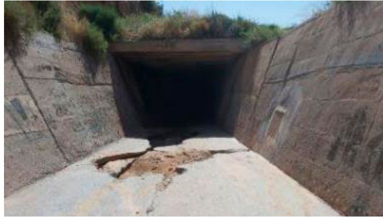
Figura 11. Erosión y desgaste de la solera del canal de sección trapezoidal antes de dar comienzo al entubado de la rambla del Castellar.
