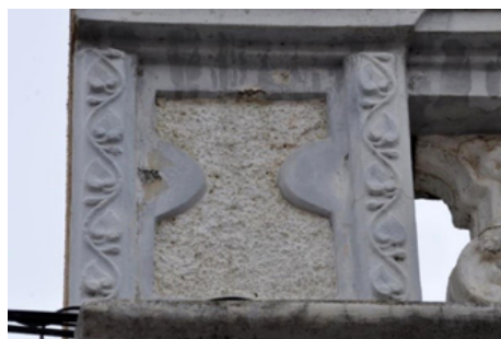
Figura 2. Molduras en el antepecho de cubierta del edificio n.º 14 de la calle Nueva de La Guancha. Foto: el autor.
