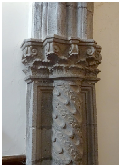
Detalle de una de las pilastras de la ermita de San Felipe Neri, La Orotava, 1665.
