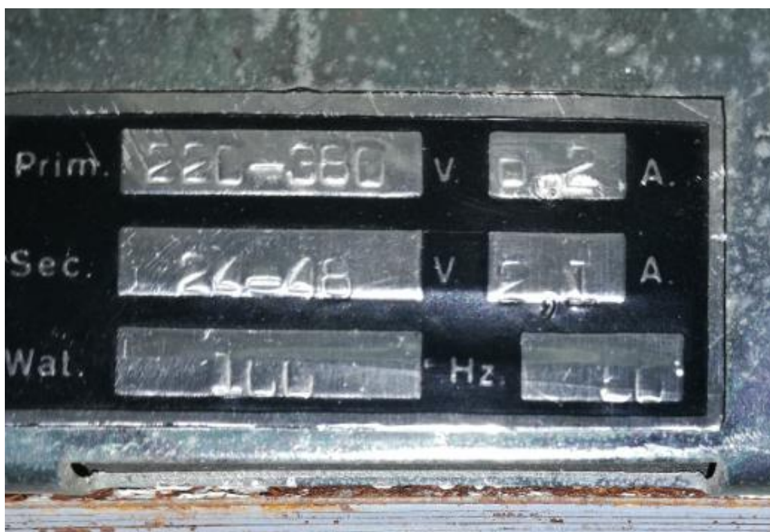
Figura 5-12. Placa de características del transformador de alimentación del circuito de mando
