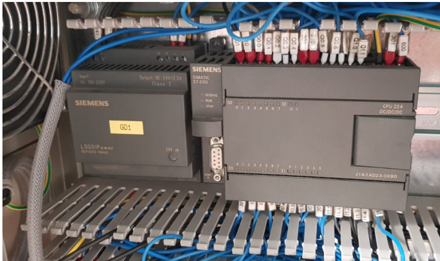
Figura 6.6: Autómata Siemens S7-224 y fuente de alimentación Siemens 6EP1332-1SH42 LOGO dentro del cuadro eléctrico de la acolchadora.
