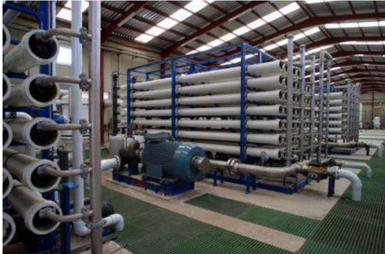
Fig. 18: Desaladora industrial de osmosis inversa [19].
