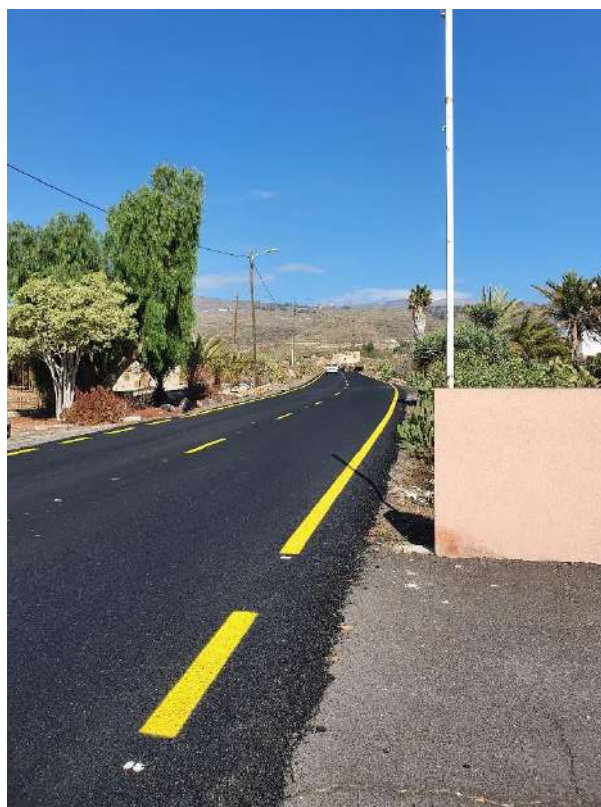
Ilustración 1. Estado actual TF-565.
