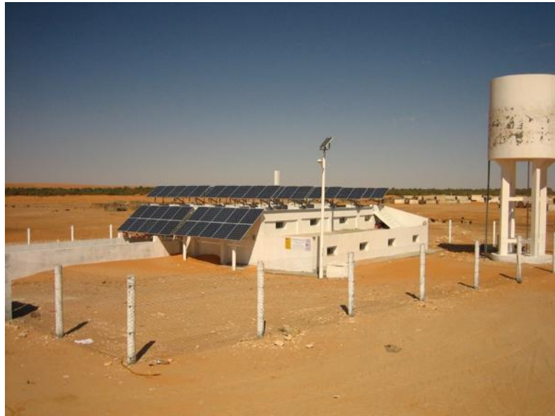
Figura 32. Sistema Dessol para la desalación de agua de mar o salobre (ITC).
