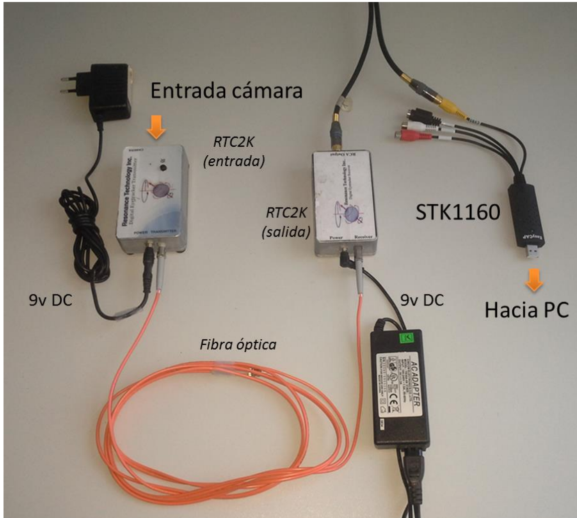
Figura mostrando la interconexión de componentes para transmisión de imágenes de video desde habitación de MR hacia sala de control
