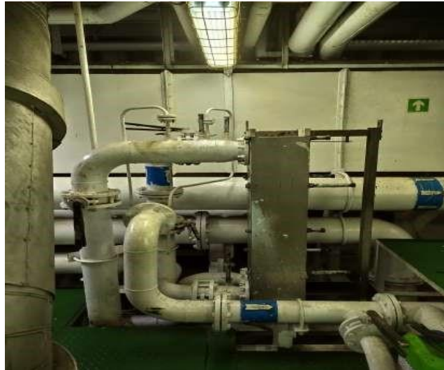
Figura 30: Enfriador de HT del buque M/V OPDR CANARIAS Fuente: [6]
