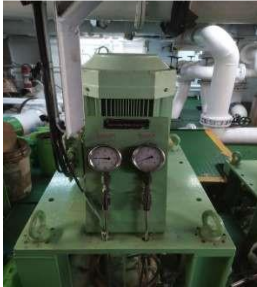
Figura 35: Bombas de agua salada del buque M/V OPDR CANARIAS Fuente: [6]
