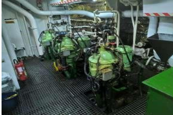
Figura 25: Cuarto de depuradoras del buque M/V OPDR CANARIAS Fuente: [6]
