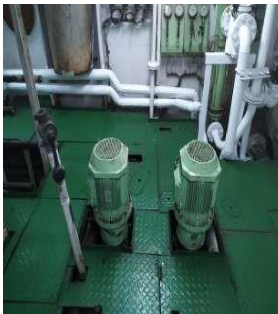
Figura 36: Bomba de trasiego de F.O y gasoil del buque M/V OPDR CANARIAS Fuente: [6]
