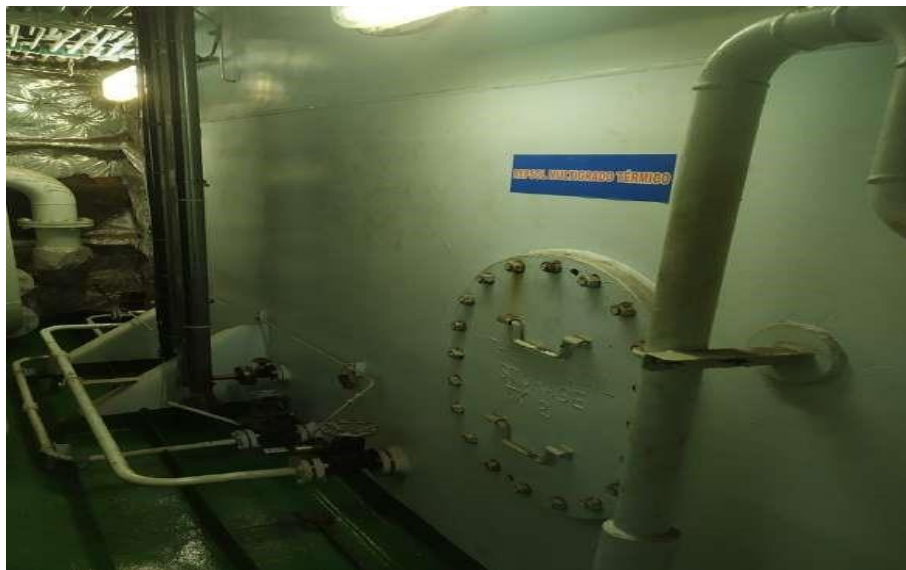
Figura 54: Tanque de almacén
