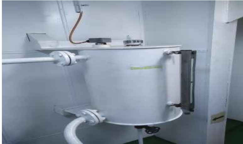
Figura 16: Tanque compensación de bocina del buque M/V OPDR CANARIAS Fuente: [6]
