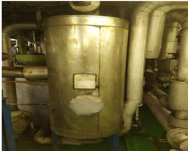
Figura 51: Tanque desaireador Fuente: [6]
