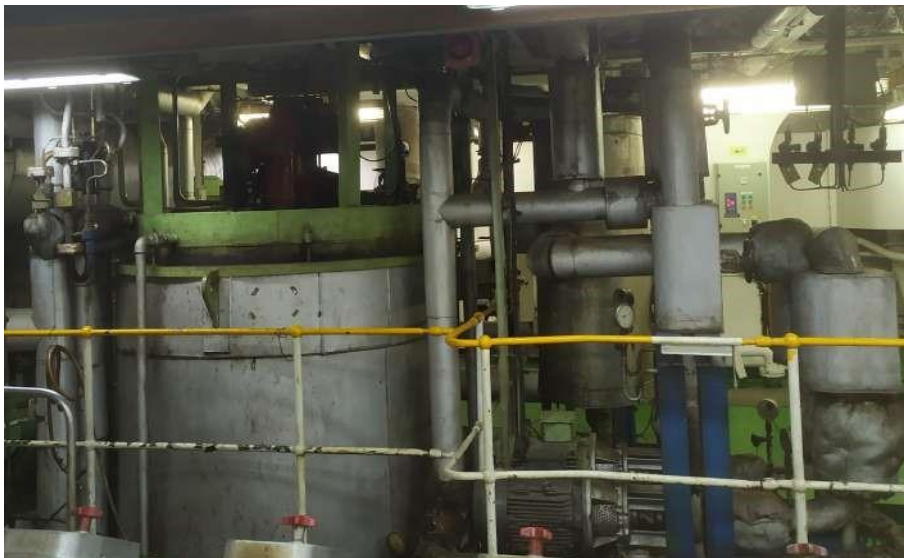
Figura 45: Caldera de aceite térmico
