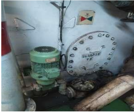
Figura 31: Bomba de alimentación de la depuradora de fueloil del buque M/V OPDR CANARIAS
