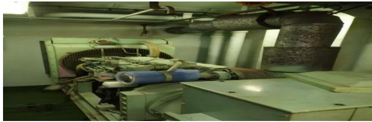
Figura 17: Generador de emergencia del buque M/V OPDR CANARIAS Fuente: [6]
