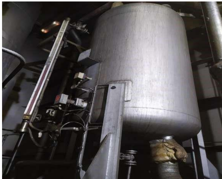
Figura 53: Tanque de expansión Fuente: [6]
