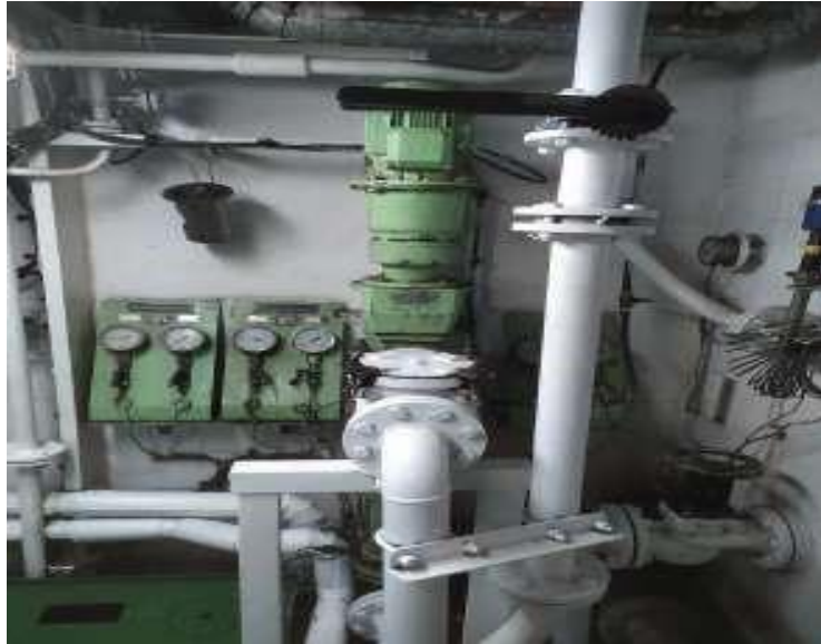
Figura 37: Bomba de trasiego de lodos del buque M/V OPDR CANARIAS Fuente: [6]
