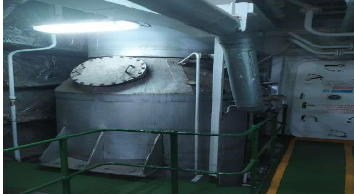
Figura 48: Caldera de recuperación
