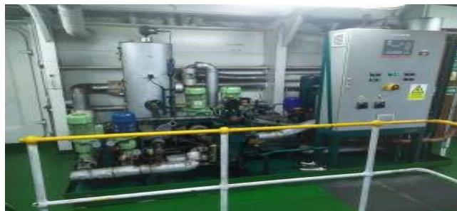
Figura 26: Módulo de combustible del buque M/V OPDR CANARIAS Fuente: [6]
