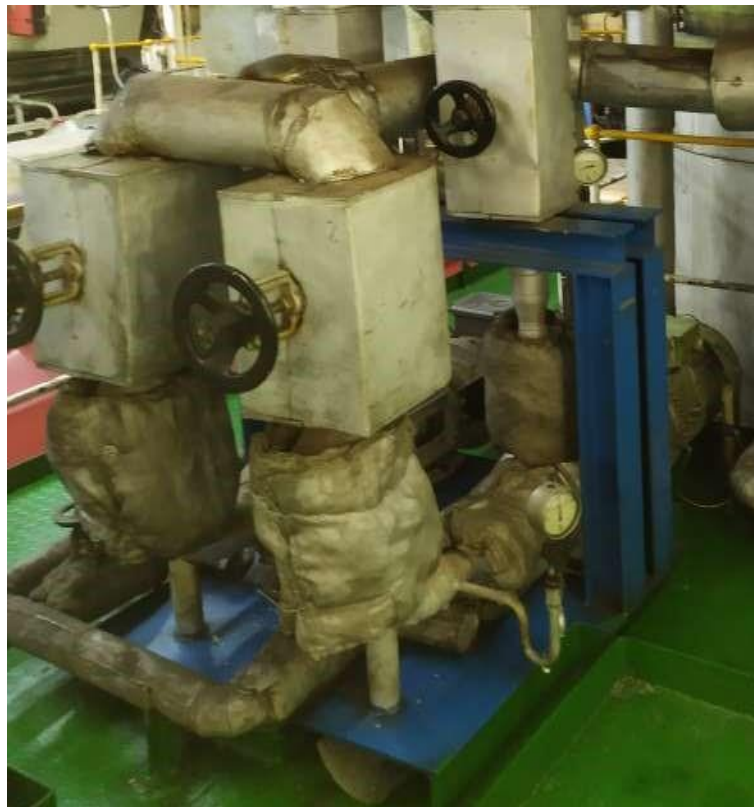
Figura 52: Bomba de circulación Fuente: [6]
