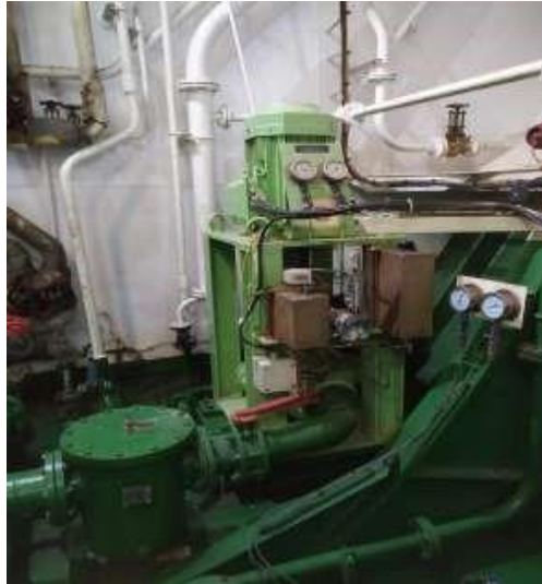
Figura 33: Bomba de contra incendios del buque M/V OPDR CANARIAS Fuente: [6]
