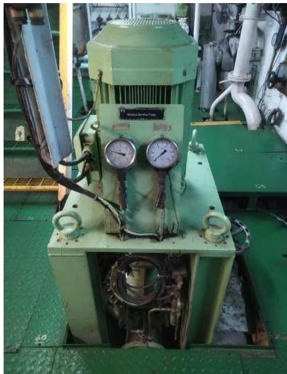
Figura 32: Bomba de servicio generales del buque M/V OPDR CANARIAS
