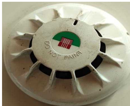
Ilustración 36: Detector de calor.
