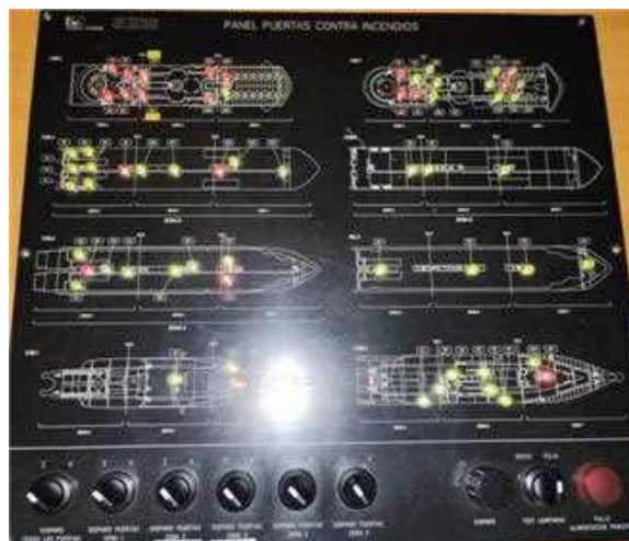
Ilustración 41: Panel de puertas contra incendios del buque.
