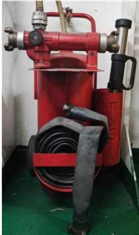
Ilustración 18: Dispositivo lanza espuma ubicado en bodega.
