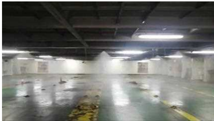
Imagen 13: Aspersión de agua por rociadores en cubiertas de carga.
