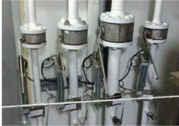
Ilustración 30: Zona de apertura de válvulas de distribución.
