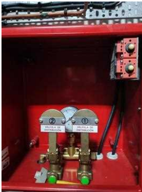
Ilustración 29: Armario disparador de una zona protegida del sistema.
