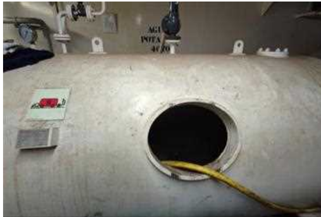
Ilustración 45: Limpieza del tanque de almacenamiento de agua dulce del sistema de “sprinkler”.
