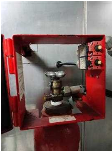
Ilustración 32: Caja de disparo del CO 2 ubicada en cocina.
