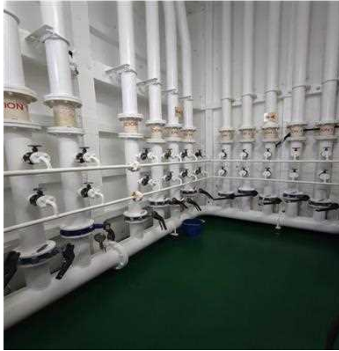
Ilustración 14: Local de válvulas de rociadores.
