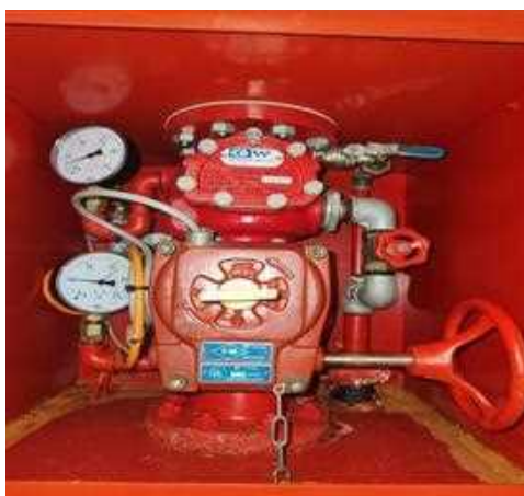
Ilustración 12: Válvula de diluvio del sistema de “sprinkler” del Volcán de Timanfaya.
