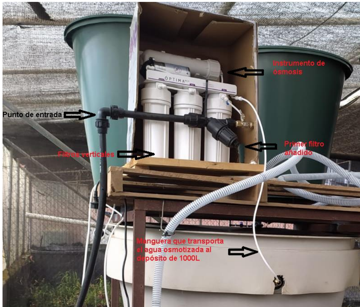
Figura 8. Planta de ósmosis y sus partes.
