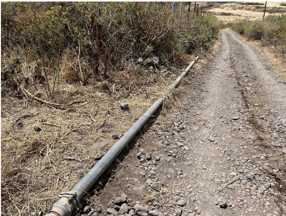
Fotografía 4. 1. Tubería de abastecimiento
