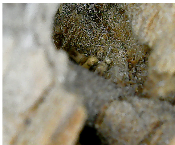
Fig.10.33. Vista de la rotura de una de las cuerdas.
