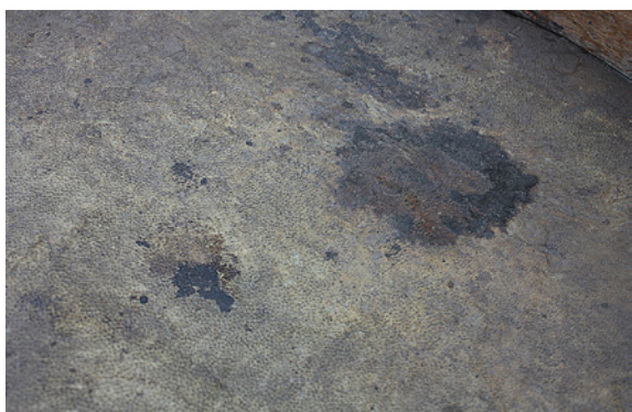
Fig.12.11. Suciedad y presencia de moho.
