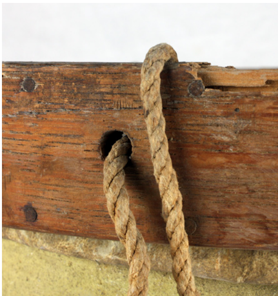
Fig. 12.1. Falta de soporte, oxidación en clavos y manchas.
