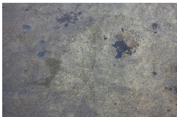
Fig.12.12. Suciedad y presencia de moho.
