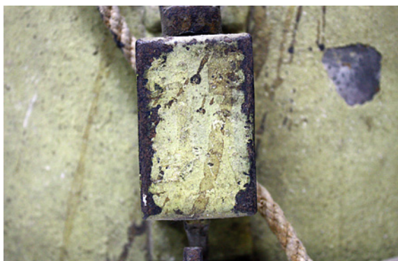
Fig. 12.5. Manchas y oxidación.
