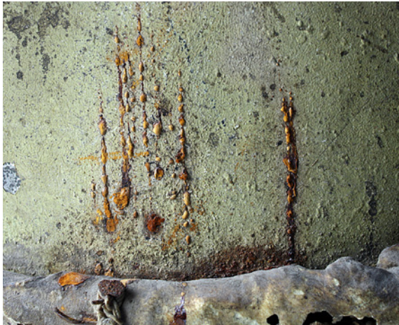
Fig.10.5. Detalle con luz rasante, oxidación del metal.
