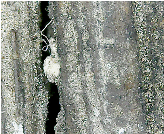
Fig.10.19. Suciedad en la madera y caverna con restos de excremento xilófago.
