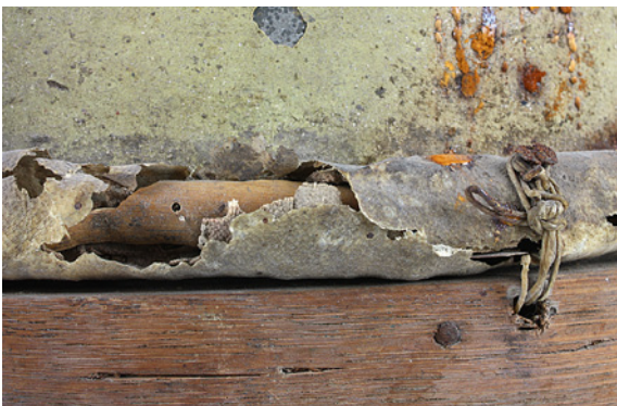
Fig.12.9. Falta de soporte, suciedad y ataque xilófago.
