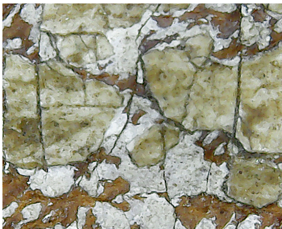
Fig.10.25. Manchas situadas en algunos de los tensores.
