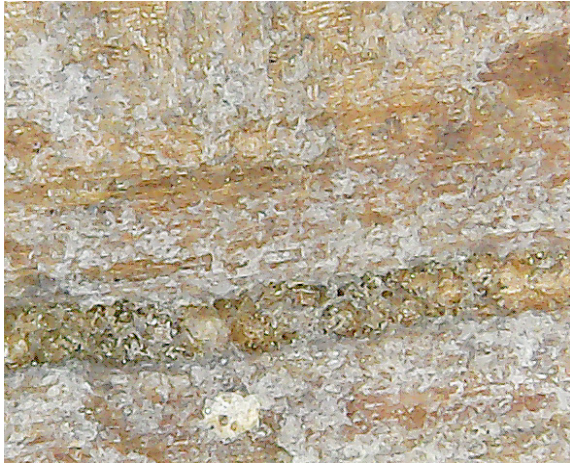
Fig.10.17. Suciedad en la madera y caverna con restos de excremento xilófago.
