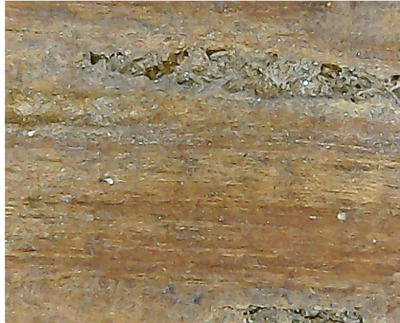
Fig.10.18. Suciedad en la madera y caverna con restos de excremento xilófago.
