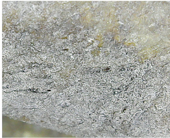
Fig.10.30. Suciedad superficial en la piel.
