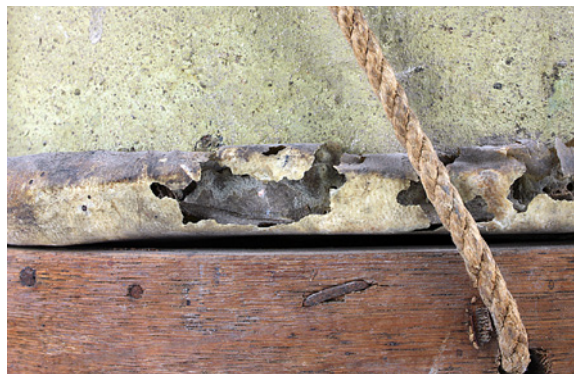
Fig.12.10. Falta de soporte, suciedad y ataque xilófago.
