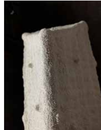
Fig. 158 Grieta producida por el descere
