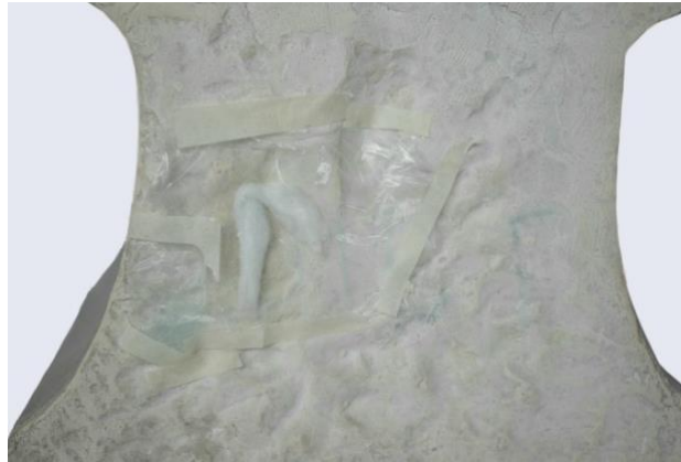
Fig. 44 Retirada de vandalismo con empaques de acetona cubierto con plástico en el macho cabrío
