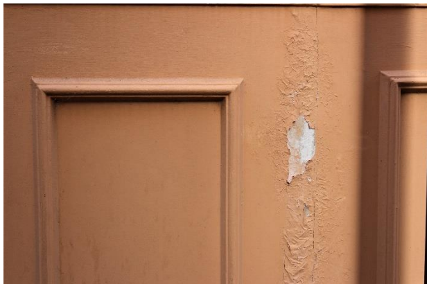
Figura 108. Abolsamiento y pérdida de revestimiento en zócalo.
