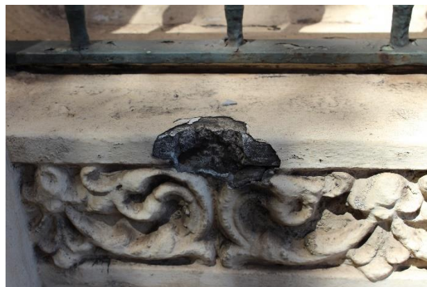
Figura 41. Carbonatación en detalle ornamental.
