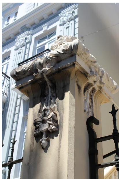
Figura 42. Manchas por escorrentía.
