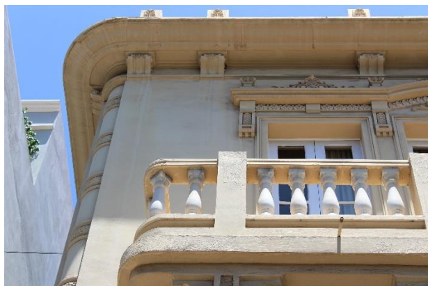
Figura 44. Suciedad y manchas por escorrentía.
