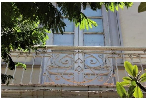
Figura 57. Oxidación de rejería en balcón volado.
