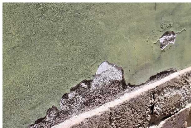
Figura 81. Caleo y desprendimiento.
