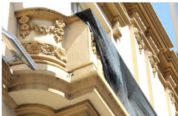
Figura 25. Peligro de desprendimiento en balcón.
