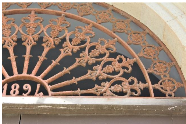
Figura 91. Suciedad y oxidación leve en hierro forjado.
