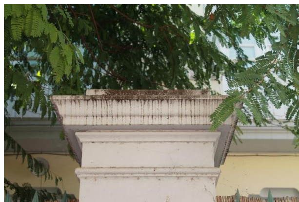
Figura 55. Deposición de suciedad y manchas por escorrentía en remate de columna.
