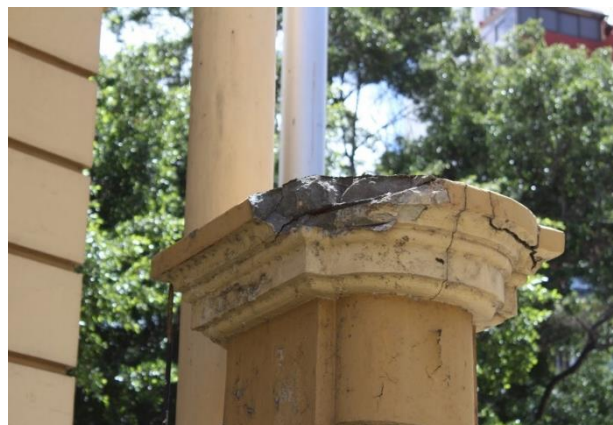
Figura 20. Carbonatación y falta volumétrica en columna de acceso principal.
