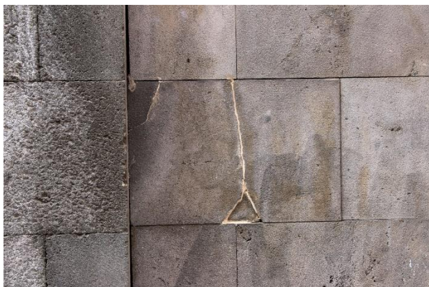
Figura 121. Grieta en material pétreo.
