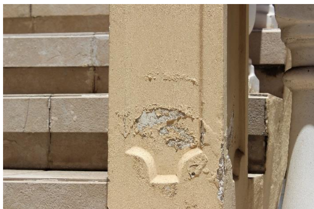
Figura 47. Caleo en acceso a escalera.
