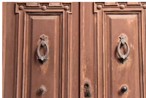
Figura 143. Carpintería en desgaste y oxidación de aldabas.
