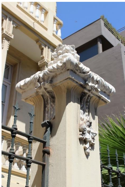
Figura 40. Deposition de suciedad en remate de columna.
