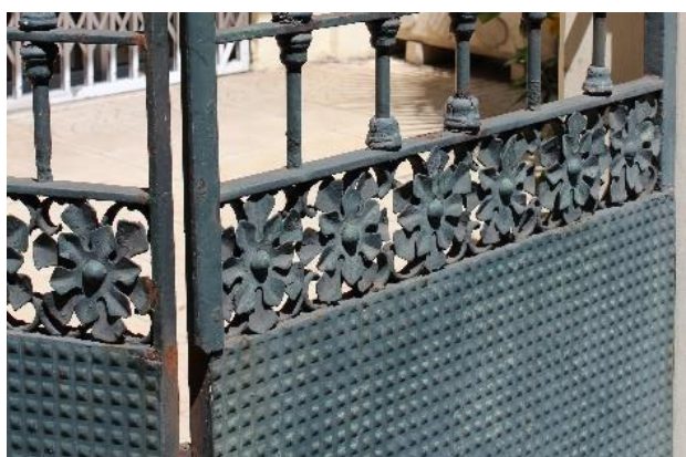
Figura 49. Rejería en estado de oxidación.
