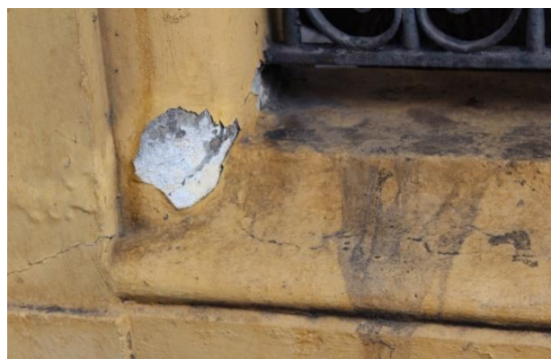
Figura 26. Suciedad y desprendimiento.
