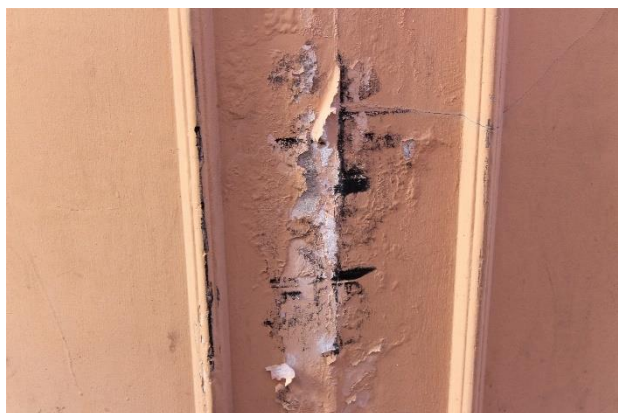
Figura 111. Grieta y craquelados en esquina de zócalo.
