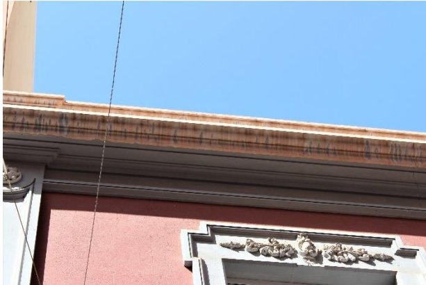
Figura 126. Manchas por escorrentía en cornisa de remate.
