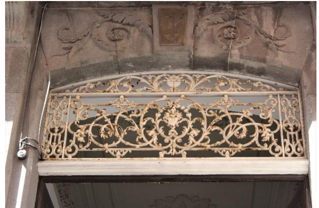
Figura 128. Oxidación en rejería de dintel.
