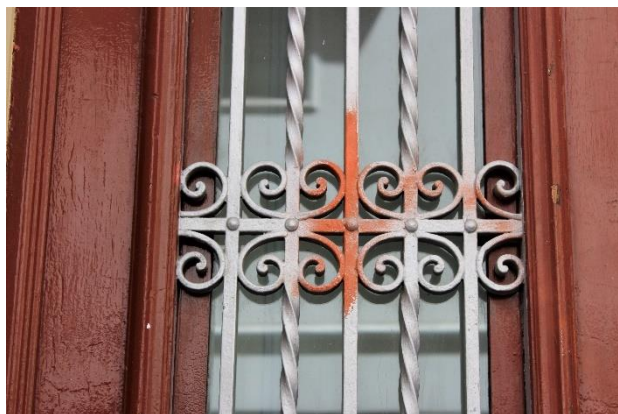
Figura 114. Repinte en herrería de puerta principal.
