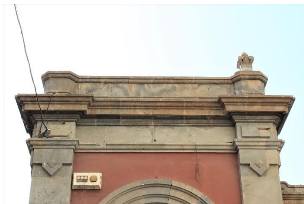
Figura 129. Falta volumétrica en remate izquierdo.
