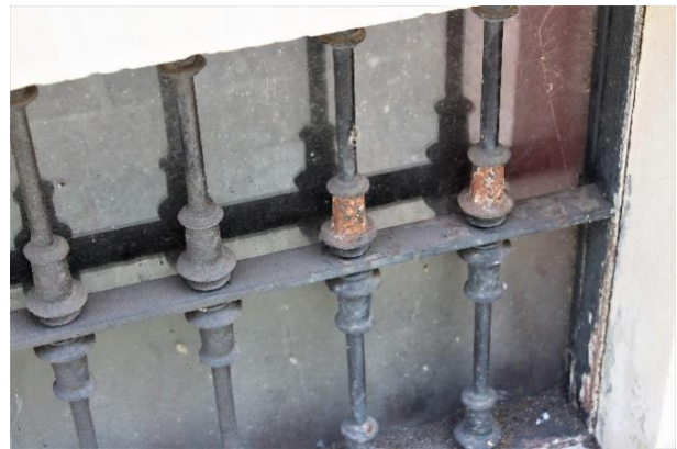
Figura 66. Oxidación de cerramiento bajo.
