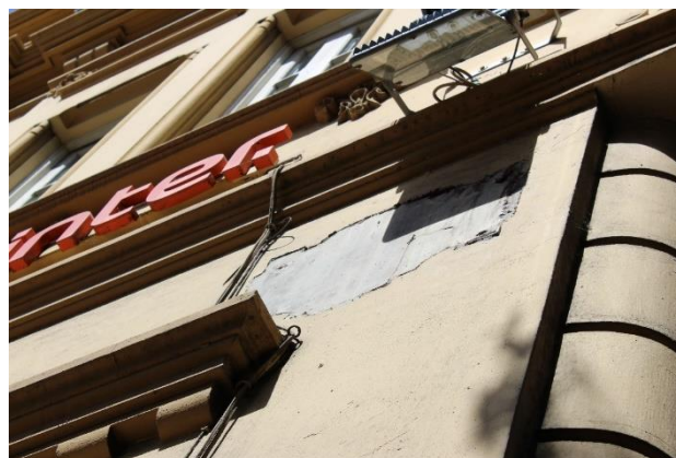
Figura 21. Ausencia de revestimiento.
