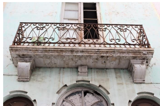
Figura 103. Peligro de desprendimiento de balcón volado.
