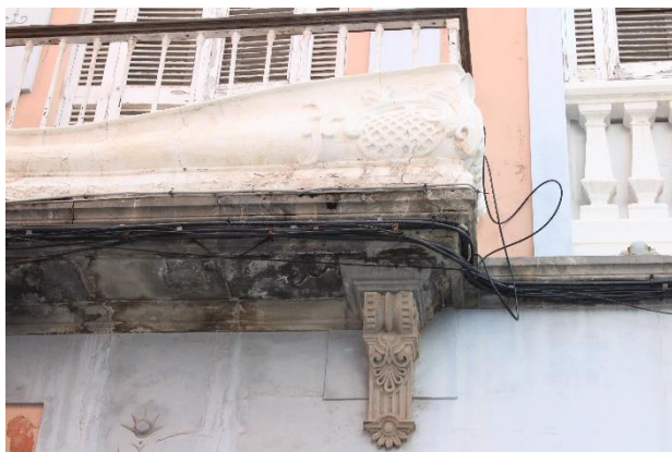
Figura 141. Daño por humedad en base de elemento decorativo de balcón.
