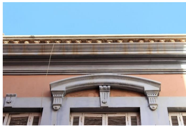
Figura 140. Manchas por escorrentía en cornisa de remate.
