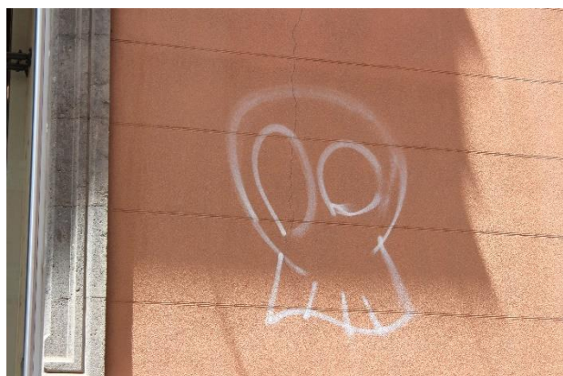
Figura 96. Daño por vandalismo.
