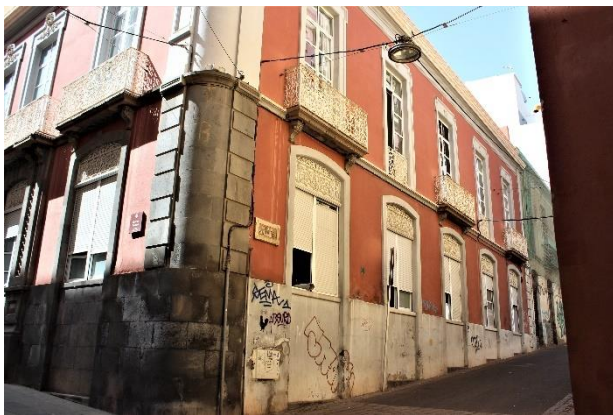
Figura 127. Zona lateral del inmueble en mal estado.
