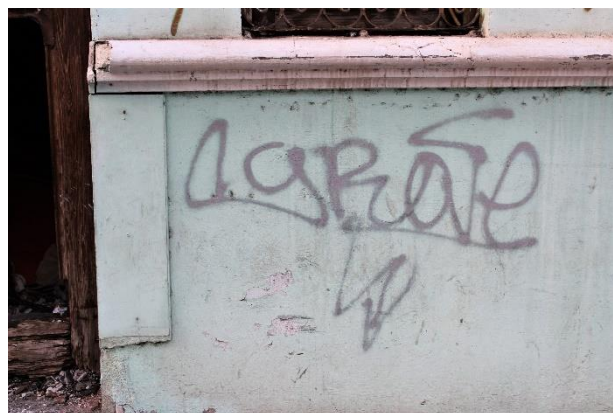
Figura 100. Daños de tipo vandálico.
