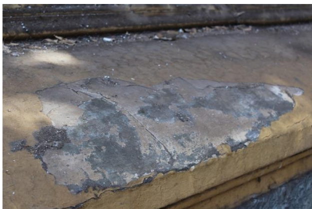
Figura 17. Falta de revestimiento en antepecho.
