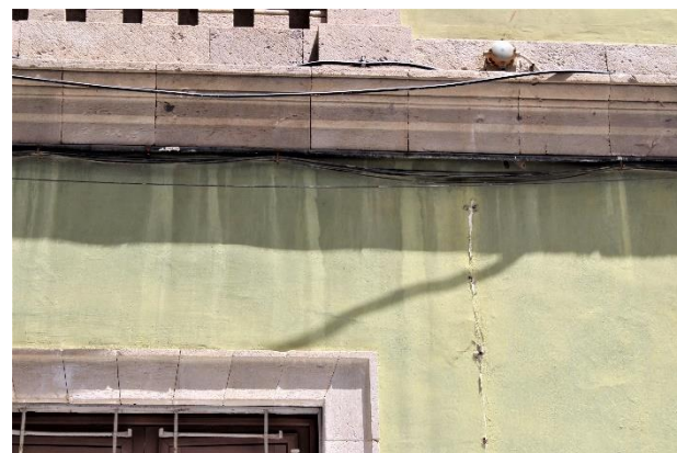
Figura 82. Manchas por escorrentía bajo cornisa.
