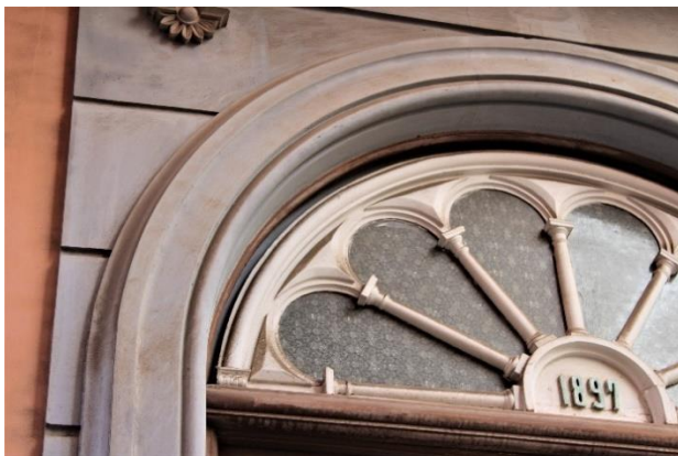
Figura 144. Deposición de suciedad en dintel de puerta principal.
