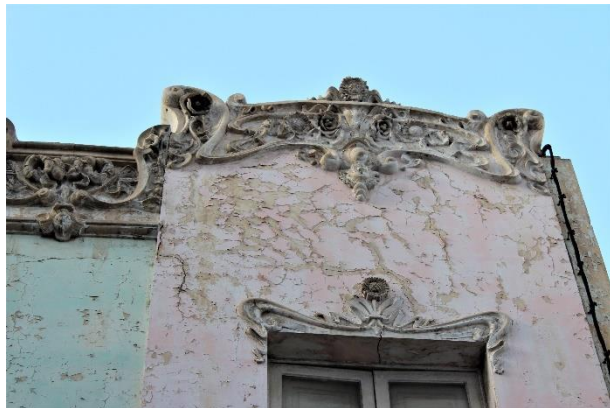
Figura 105. Craquelado y pérdida de plasticidad en pintura.
