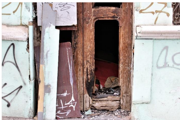
Figura 98. Falta importante de carpintería.
