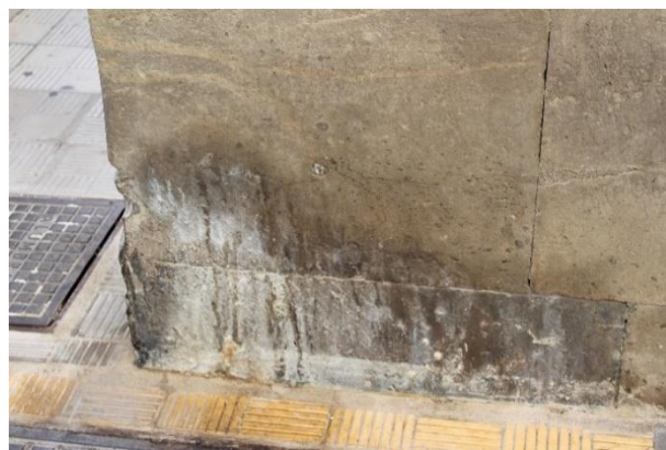
Figura 133. Eflorescencias en base de inmueble.
