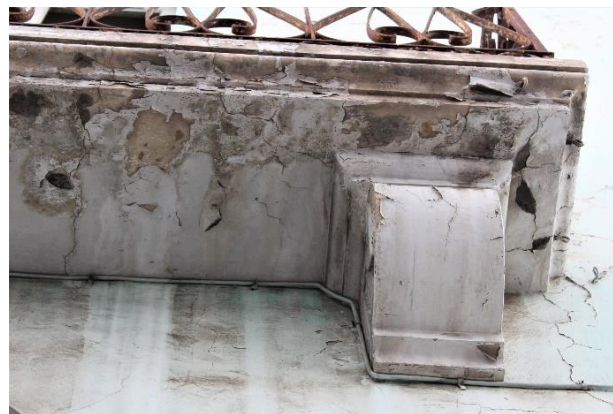
Figura 107. Daños por humedad en base de balcón.
