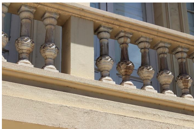
Figura 45. Balastrada con manchas por escorrentía.
