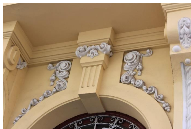
Figura 119. Deposición de suciedad leve en elementos decorativos.
