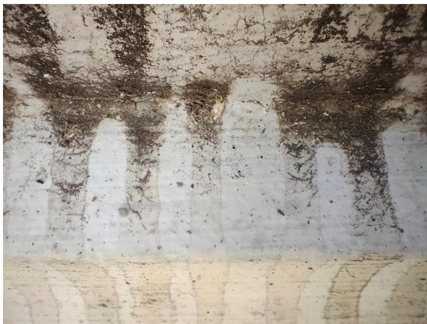
Figura 148. Escorrentía en macrofotografía, "Casa Foronda", ficha 5.
