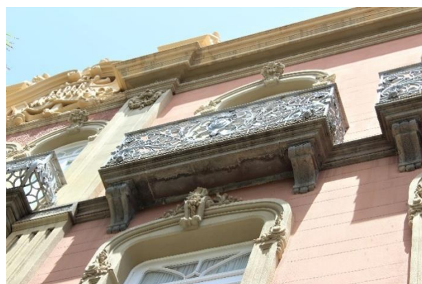
Figura 97. Alteración por humedad en base de balcón.
