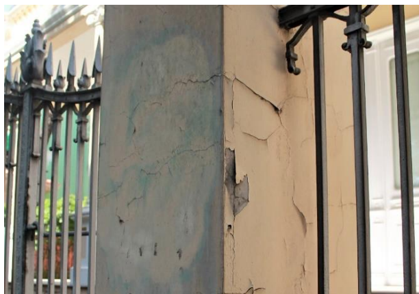
Figura 32. Daño vandálico y craquelados en columna central.
