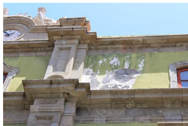
Figura 88. Gran falta de material constructivo.
