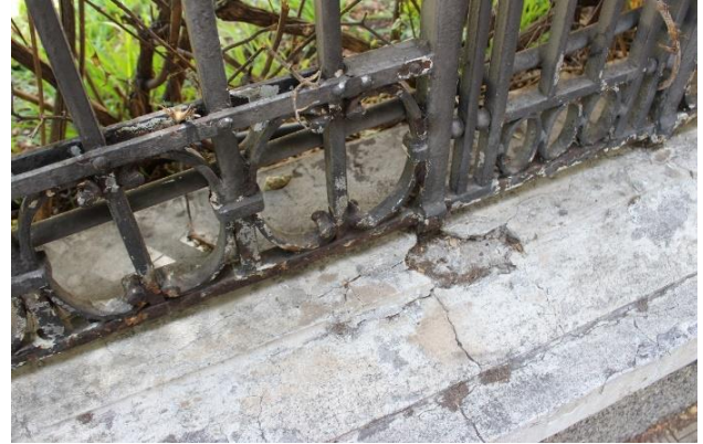
Figura 38. Levantamientos y grietas en muro que acompaña rejería.
