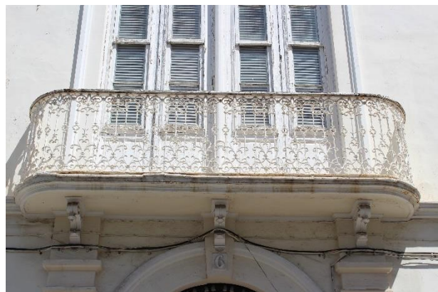
Figura 61. Oxidación general de balcón volado.
