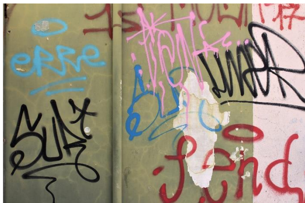
Figura 80. Diversos daños por vandalismo.
