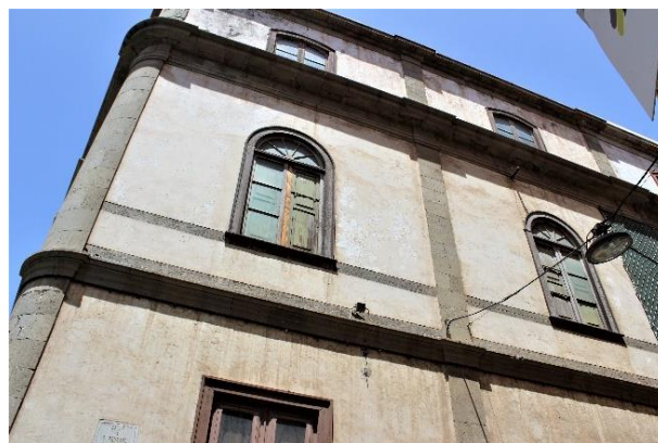
Figura 90. Zona lateral del inmueble en mal estado.
