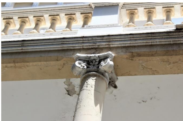
Figura 35. Daños por humedad en el capitel del pilar.
