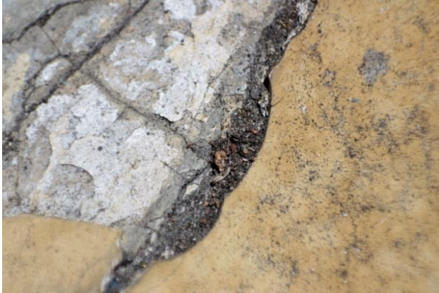
Figura 28. Macrofotografía desprendimiento con suciedad.
