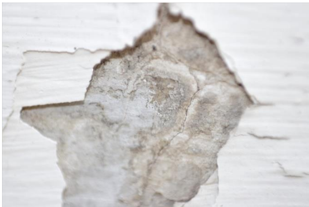
Figura 69. Macrofotografía falta de revestimiento.
