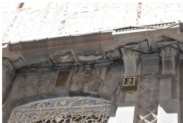
Figura 125. Daño por humedad en base de balcón.
