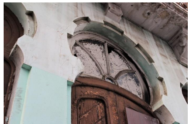
Figura 102. Manchas por escorrentía y deposición de suciedad grave.
