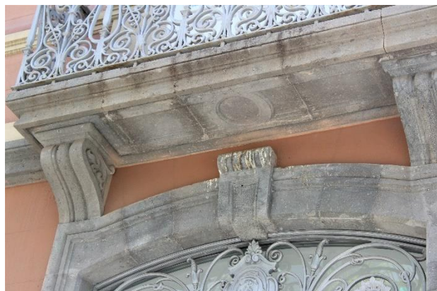
Figura 94. Presencia de deyecciones en dintel.
