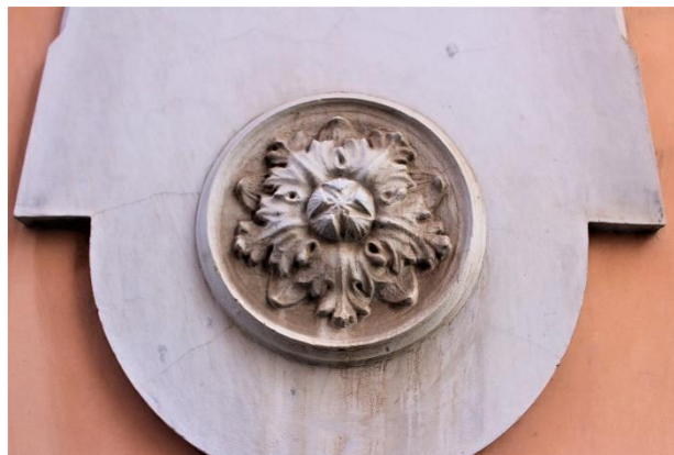
Figura 136. Suciedad acumulada en rosetón.
