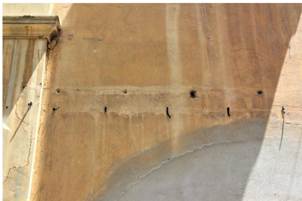
Figura 70. Manchas por escorrentía y perforaciones.
