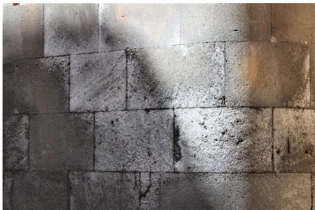
Figura 120. Eflorescencias y espectros en zócalo.
