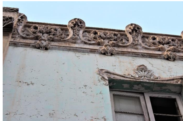
Figura 104. Suciedad y diferencia de tonalidades en coronación.
