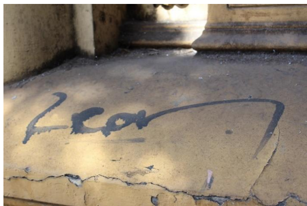
Figura 18. Daño vandálico y grieta en antepecho.
