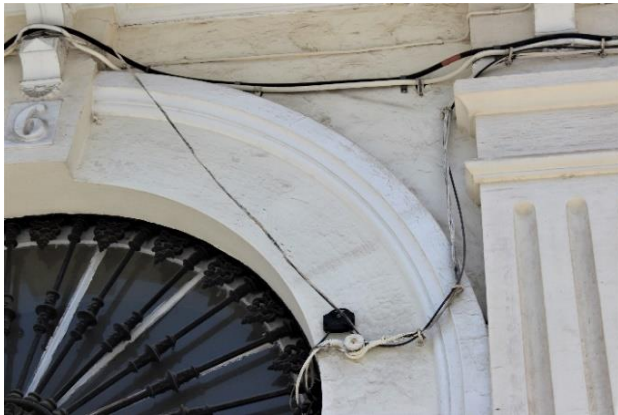
Figura 67. Tendido eléctrico y suciedad en dintel.
