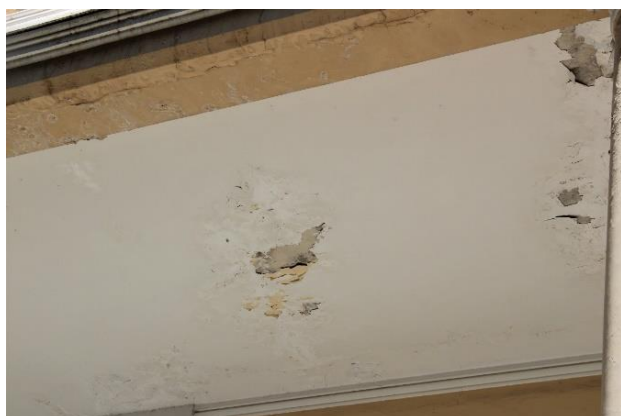
Figura 30. Eflorescencia y desprendimiento por humedad.
