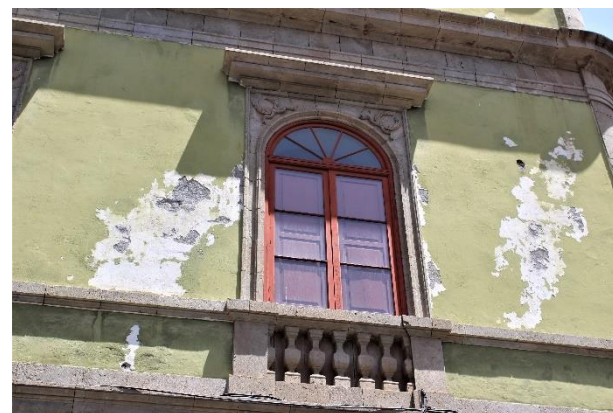
Figura 84. Grandes faltas de revestimiento.
