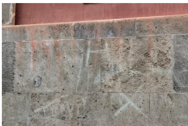
Figura 132. Manchas por escorrentía y vandalismo.
