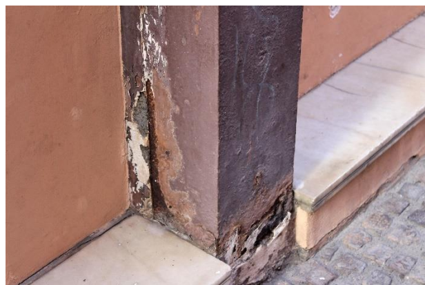
Figura 112. Oxidación en zona baja de jamba.
