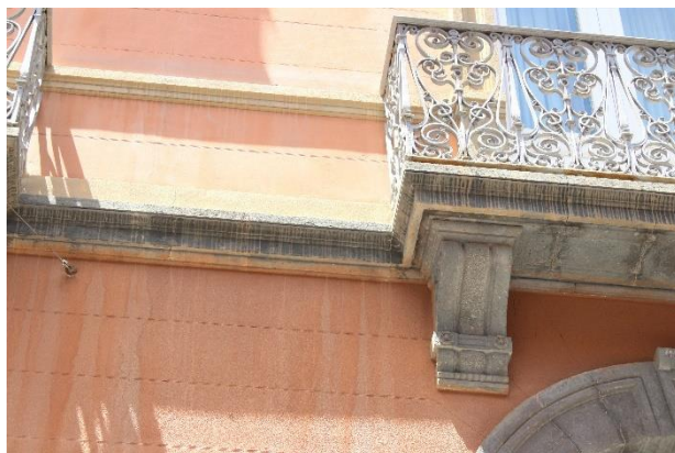
Figura 95. Manchas por escorrentía leves.
