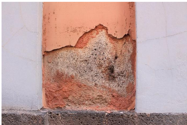
Figura 135. Falta volumétrica y de revestimiento.
