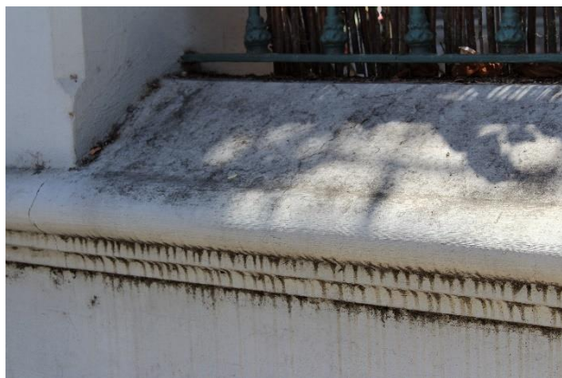
Figura 54. Manchas por escorrentía y suciedad en cornisa.
