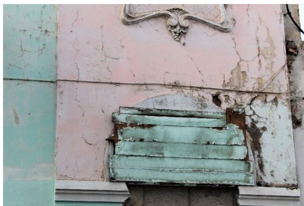
Figura 106. Tendido eléctrico, faltas de revestimiento y tapiado de dintel.
