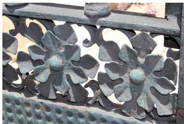
Figura 50. Detalles de oxidación en elementos decorativos.
