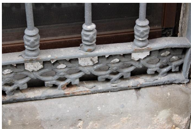
Figura 131. Oxidación de cerramiento bajo.
