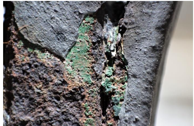
Figura 39. Macrofotografía de rejería oxidada.
