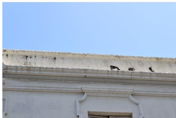
Figura 63. Presencia de manchas por escorrentía y moho negro.
