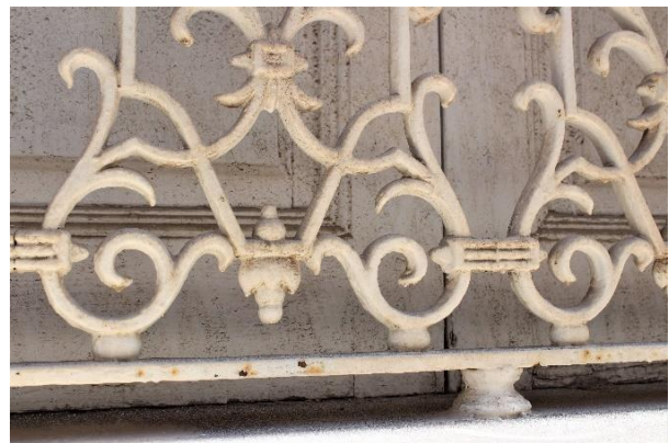
Figura 68. Exceso de pintura en rejería.
