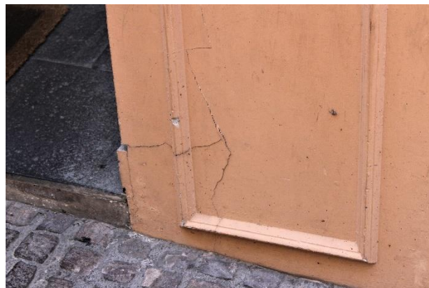
Figura 109. Grieta en zócalo.
