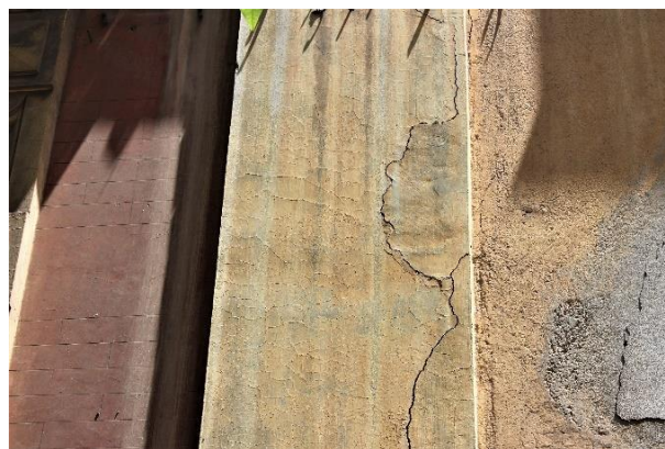
Figura 76. Grieta y manchas por escorrenfía.
