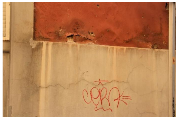
Figura 124. Daños vandálicos, grietas y abolsamientos.
