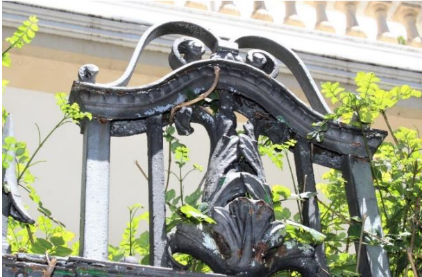
Figura 36. Oxidación en elemento decorativo en hierro forjado.
