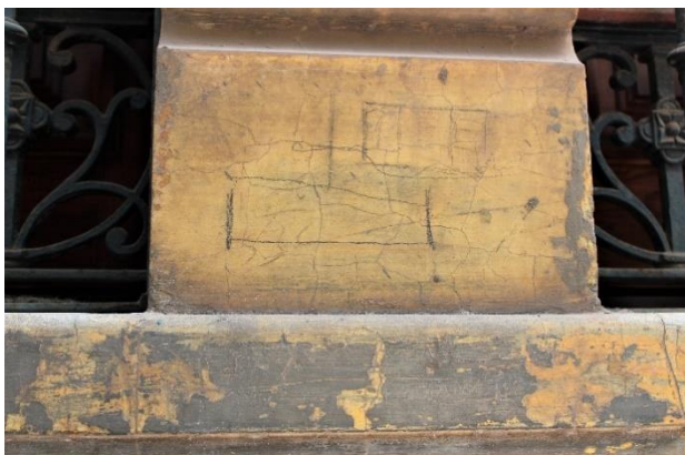
Figura 73. Daño vandálico en separación de vanos.
