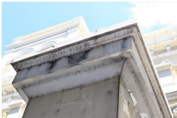
Figura 31. Presencia de moho negro y suciedad.
