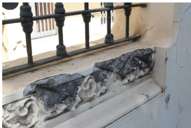
Figura 43. Falta volumétrica en detalle ornamental.
