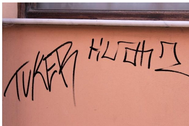
Figura 110. Daño por vandalismo en zócalo.
