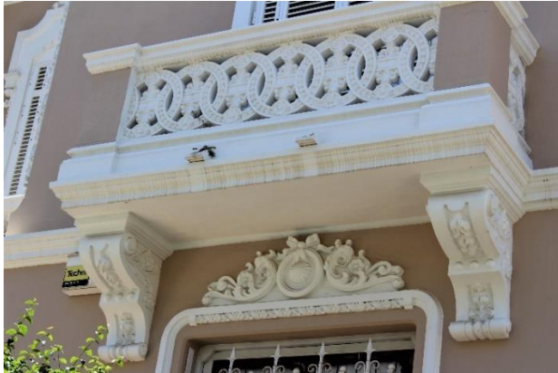
Figura 51. Leves manchas por escorrentía en balcón.
