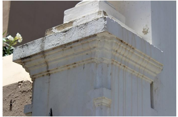
Figura 52. Manchas por escorrentía en columna que acompaña la rejería.
