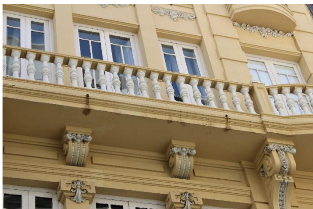
Figura 116. Manchas por escorrentía leves.
