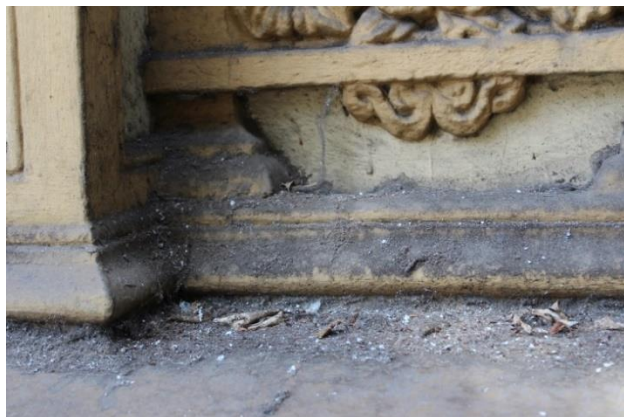
Figura 16. Acumulación excesiva de suciedad y elementos arbóreos.
