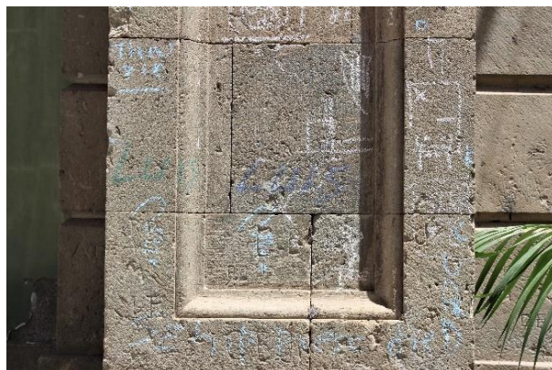
Figura 86. Daño vandálico en material pétreo.
