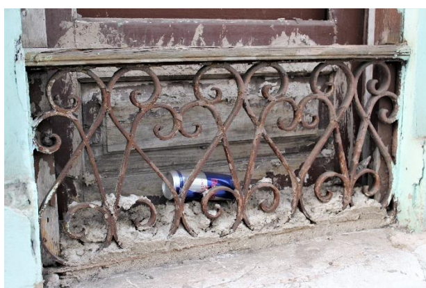
Figura 101. Suciedad acumulada, oxidación de rejería y solapamiento con material constructivo.
