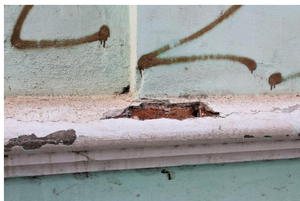
Figura 99. Falta volumétrica en cornisa.
