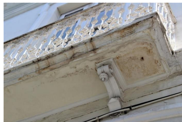
Figura 64. Alteración por humedad en base de balcón.
