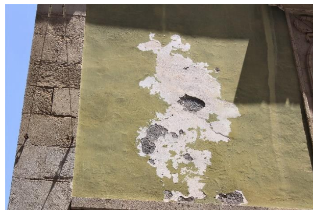
Figura 85. Falta de revestimiento y volumétrico.
