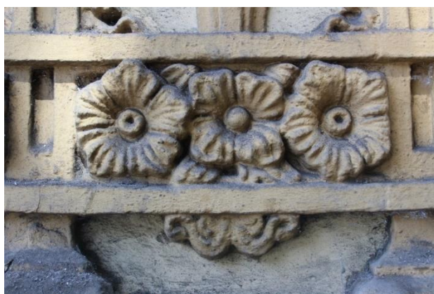
Figura 19. Deposición de suciedad en elementos decorativos.
