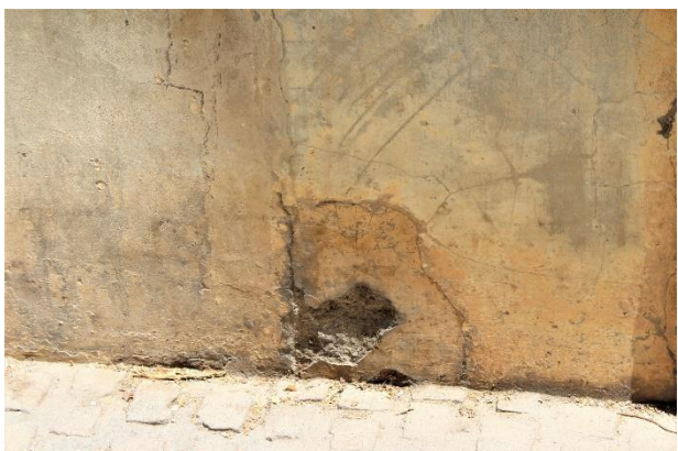
Figura 72. Falta volumétrica en planta.
