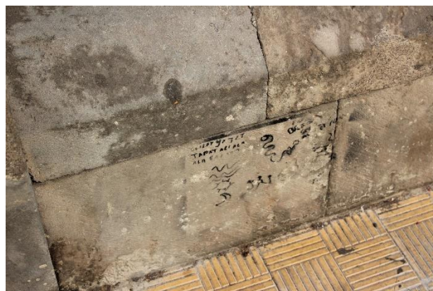
Figura 130. Daño de tipo vandálico en zócalo.
