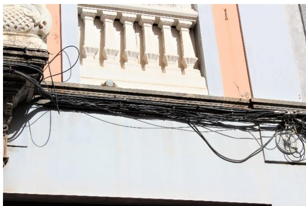
Figura 139. Tendido eléctrico abundante.
