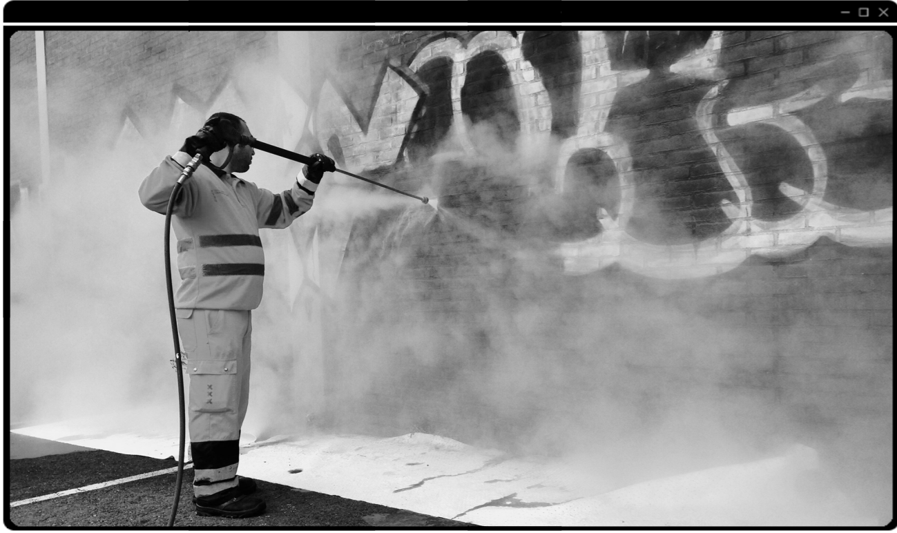
Fig.26 Eliminación de graffiti. Autoría desconocida
