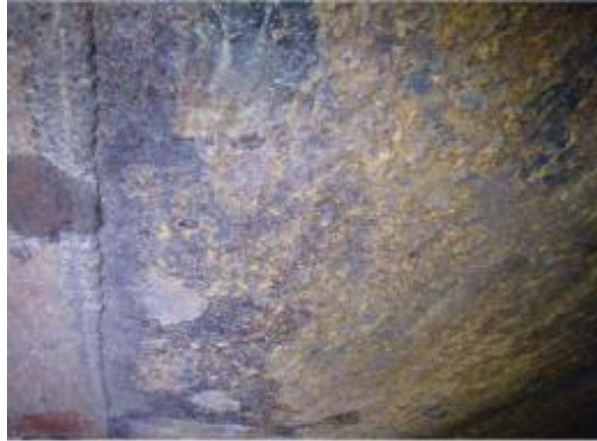
Ilustración 17. Estado de oxidación del compartimento donde ocurrió el suceso (CIAIM, 2012).
