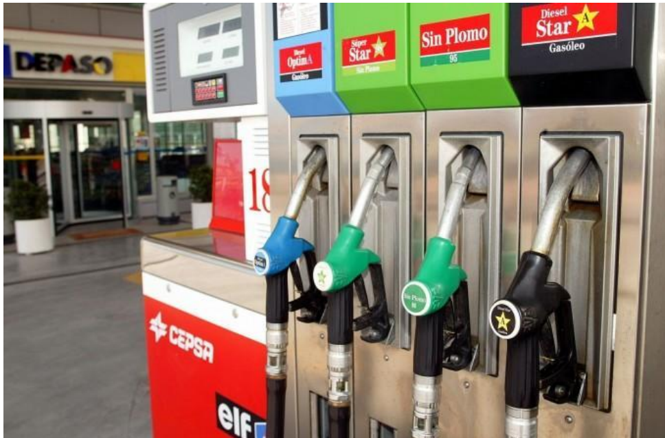
Figura 4.4. Dispensadores de una estación de servicios.
