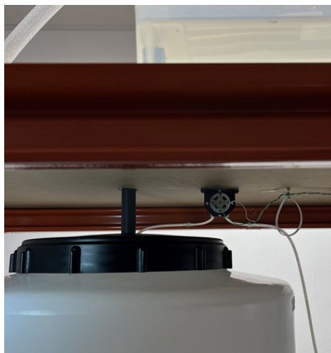
Figura 10.5. Colocación de la bomba peristáltica
