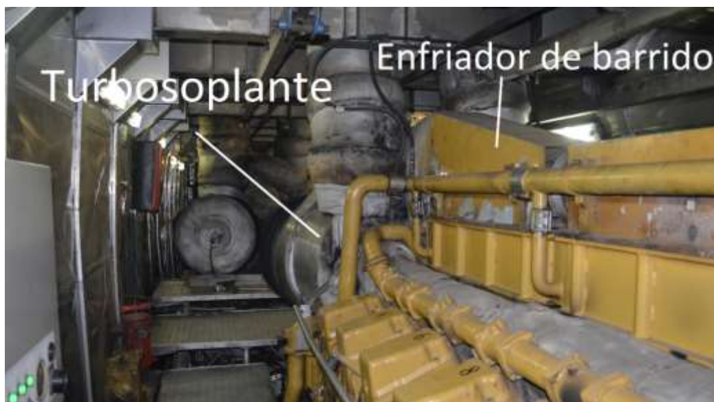
Ilustración 41. Turbosoplante y enfriador de barrido. Fuente: Trabajo de campo
