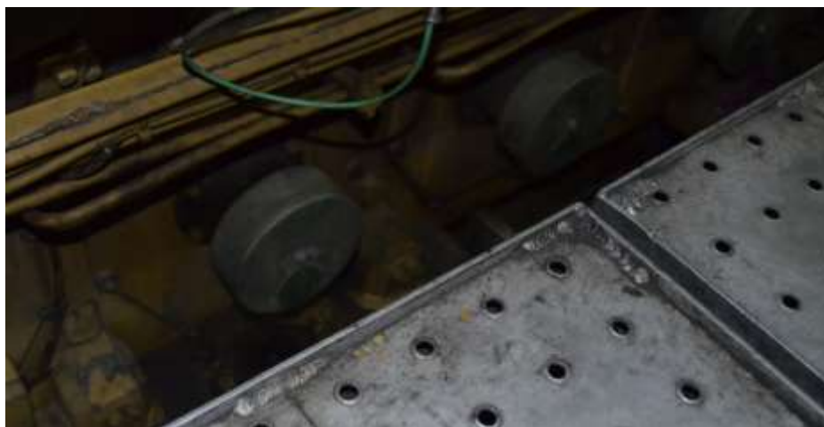
Ilustración 20. Válvulas de alivio. Fuente: Trabajo de Campo
