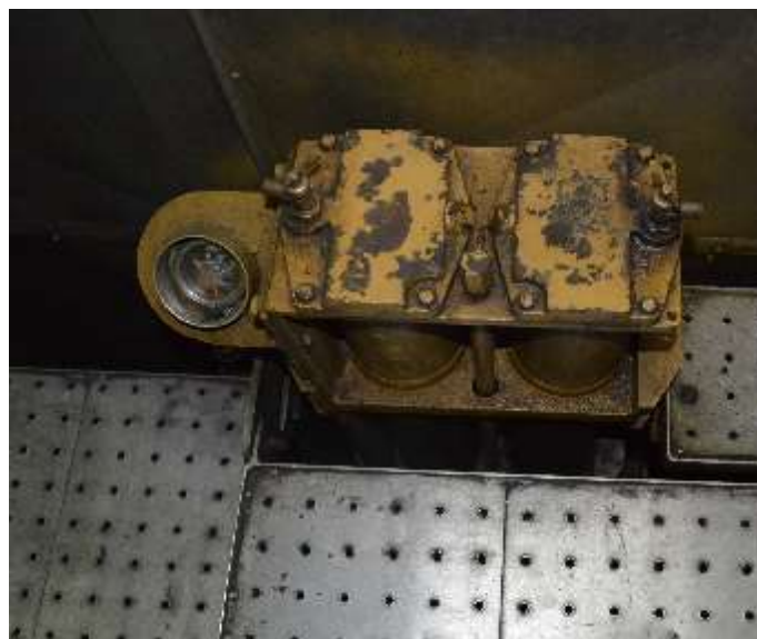
Ilustración 55. Filtros de combustible. Fuente: Trabajo de campo
