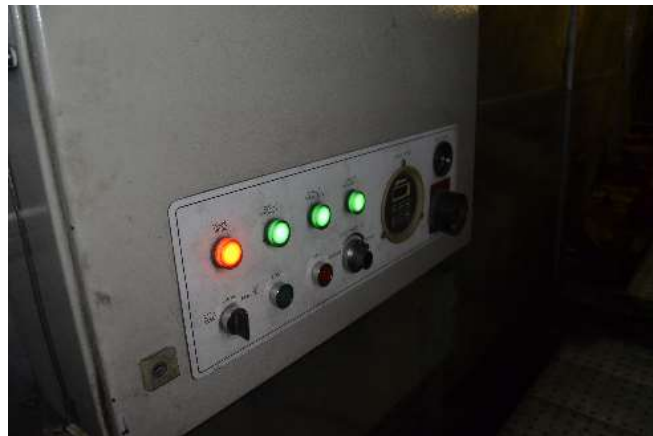
Ilustración 59. Panel de control local. Fuente: Trabajo de campo
