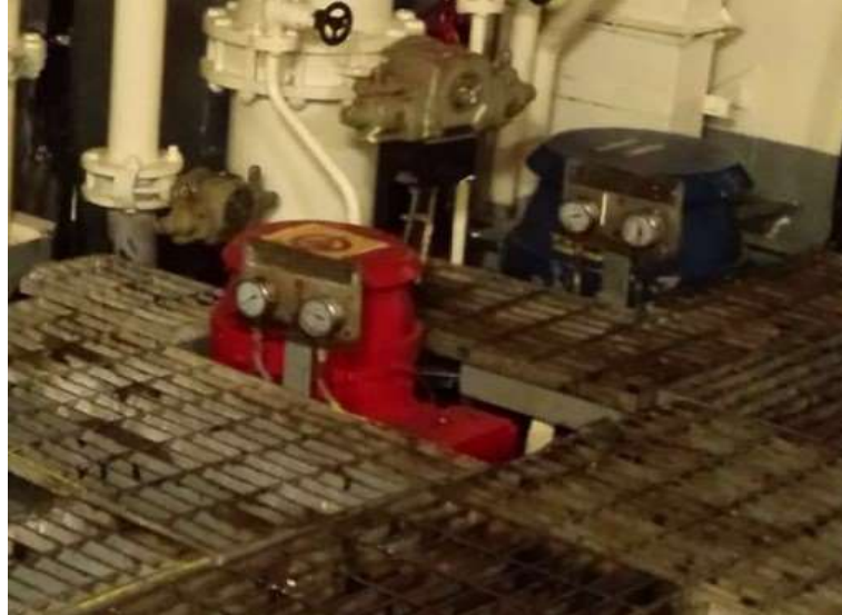
Ilustración 19. Bomba CI de emergencia. Fuente: Fotografía cedida por Luis Díaz Arbelo. .
