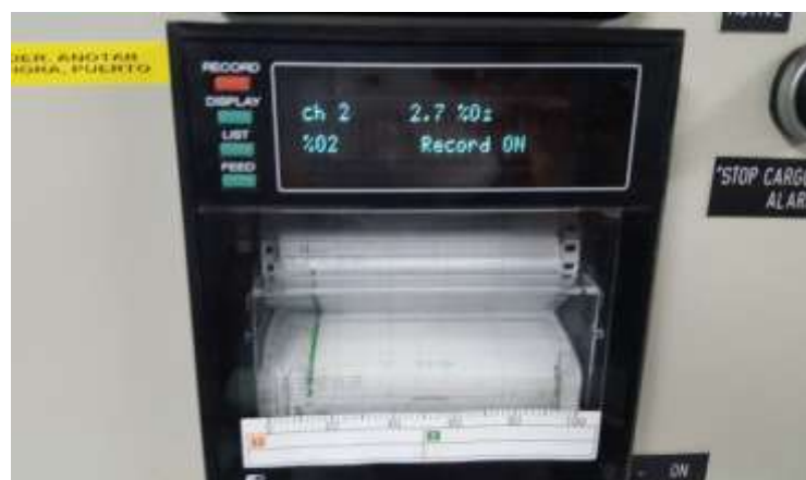
Ilustración 43. Monitores de control y registro del gas inerte instalados en el control de carga. Fuente: Elaboración propia.
