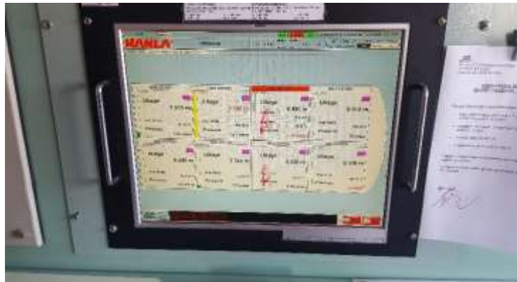
Ilustración 51. Panel de control del sistema de carga y lastre. Fuente: Elaboración propia.
