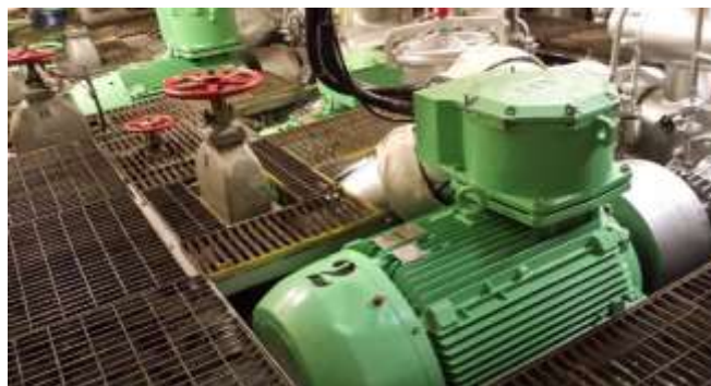
Ilustración 13. Bombas de carga. Fuente: Fotografía cedida por Luis Díaz Arbelo.
