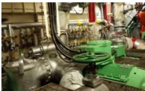
Ilustración 47. Líneas de aceite térmico en el cuarto de bombas. Fuente: Elaboración propia.
