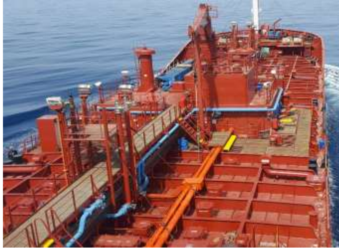
Ilustración 41. Líneas de gas inerte en cubierta, azules. Fuente: Elaboración Propia.
