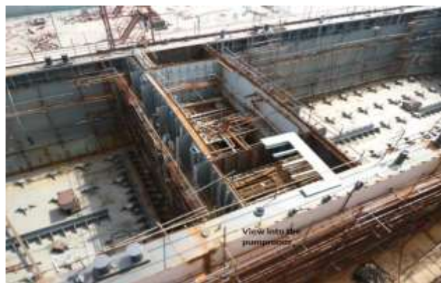
Ilustración 11. Equipamiento del cuarto de bombas en el astillero. Fuente: Archivos fotográficos cedidos por el buque.
