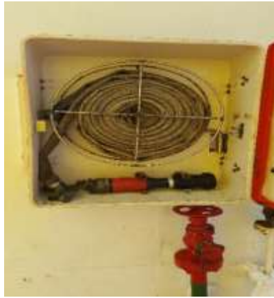
Ilustración 21. Caja CI e hidrante situada a popa de cubierta del puente. Fuente: Elaboración propia.
