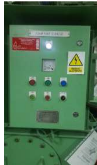
Ilustración 18. Panel de control de la bomba. Fuente: Elaboración propia.
