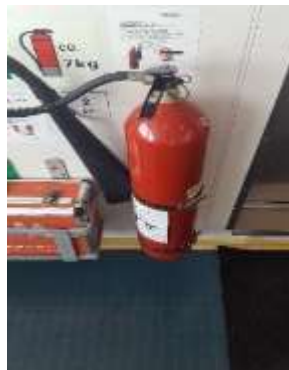
Ilustración 20. Extintor de CO 2 del puente. Fuente: Elaboración propia.
