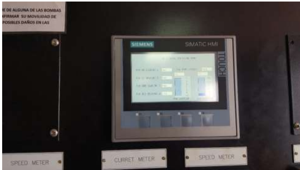
Ilustración 65. Monitor de control de la temperatura de los rodamientos y las carcasas, y de la presión en las bombas de descarga Fuente: Elaboración propia.
