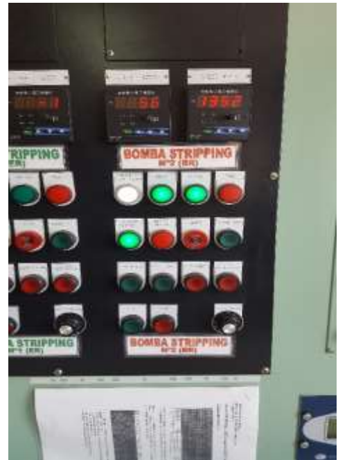
Ilustración 62. Panel de control de la bomba de Stripping 2. Fuente: Elaboración propia.
