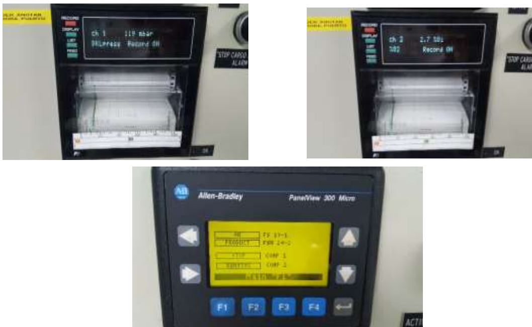
Ilustración 60. Monitores de control y registro del gas inerte instalados en el control de carga. Fuente: Elaboración propia.
