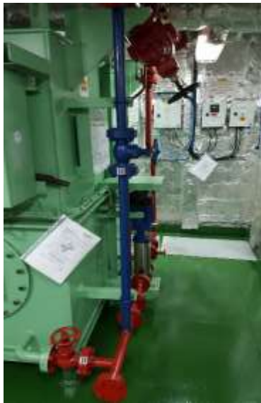
Ilustración 17. Local del sistema fijo de espuma. Fuente: Elaboración propia.
