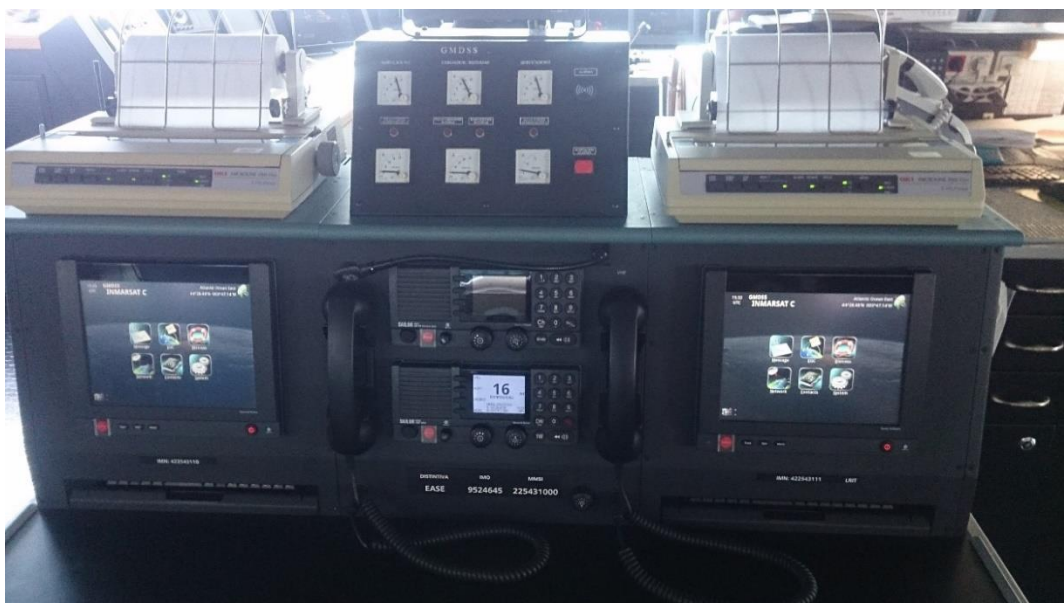
Fig. 29: Consola telecomunicaciones. Fuente: Elaboración Propia
