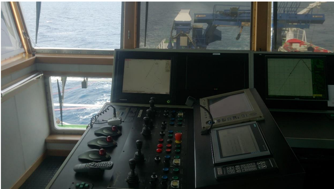
Fig. 35: Vista lateral Consola de control de Maquinillas. Fuente: Elaboración propia
