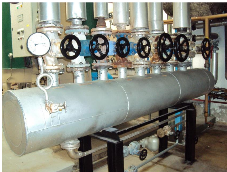
Figura XI. Colector de vapor situado en la sala de calderas
