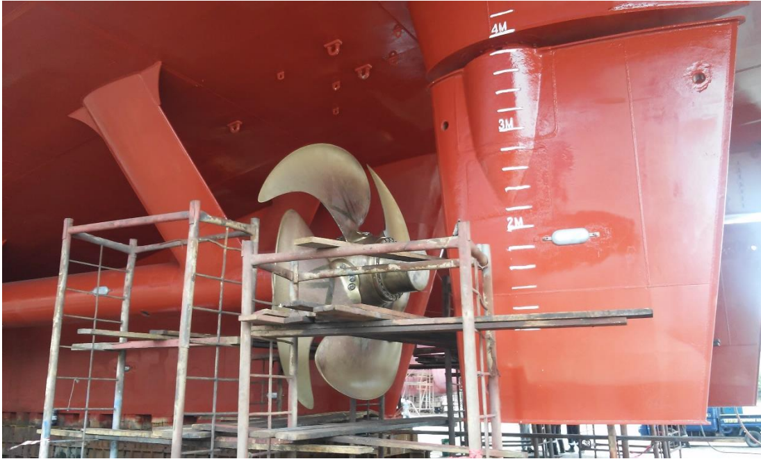
Imagen 4: Ánodo de sacrificio recién sustituido en pala de timón. B/F “Volcán de Taburiente”. Fuente propia.
