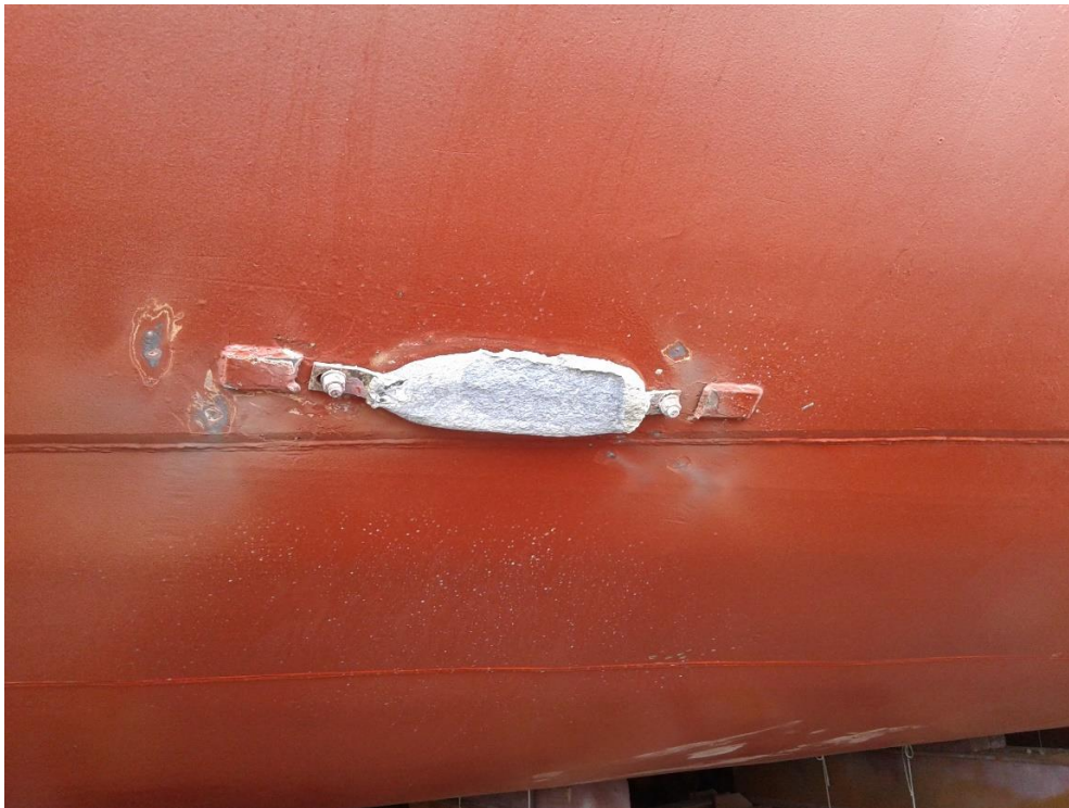
Imagen 3: Ánodo de sacrificio tras dos años de corrosión. B/F “Volcán de Taburiente”. Fuente: Asbel Luis
