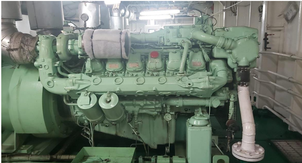
Ilustración 5: Motores Auxiliares. Fuente: Elaboración propia.
