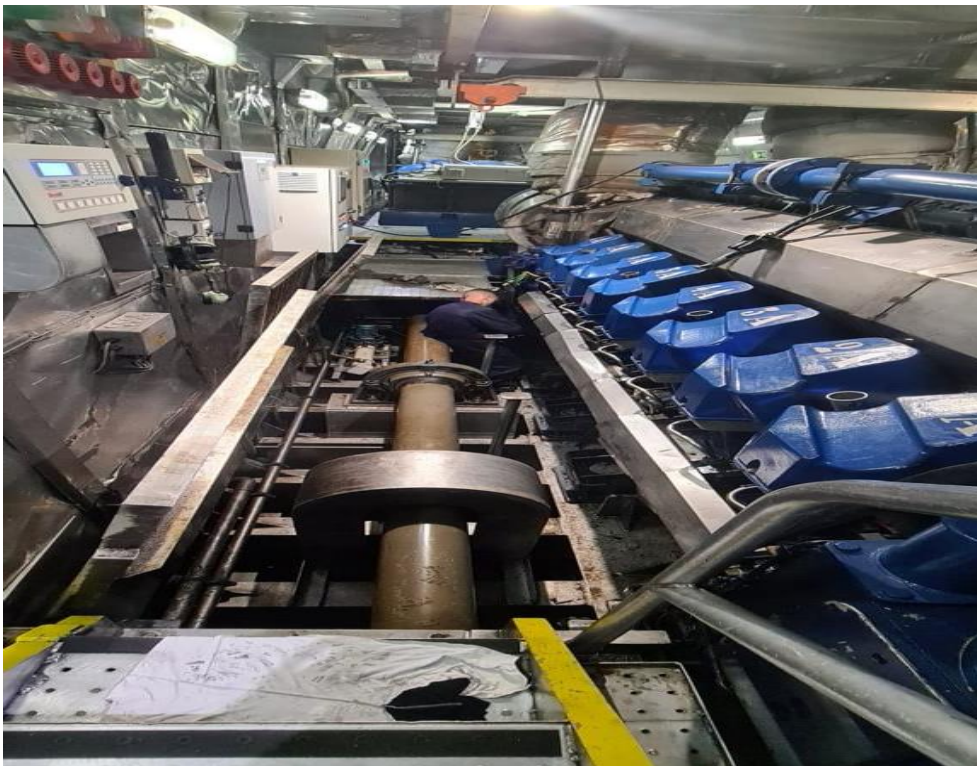
Ilustración 73: Motor Estribor Exterior. Fuente: Elaboración propia.
