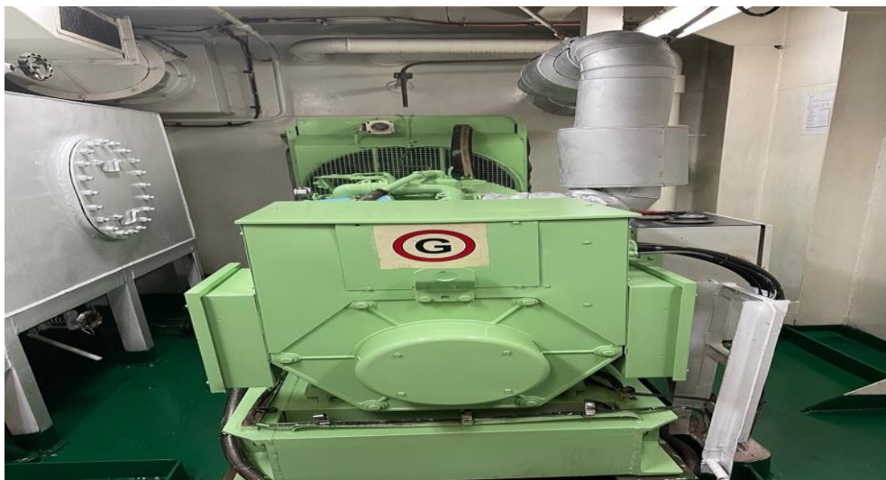
Ilustración 10: Generador de emergencia. Fuente: Elaboración propia.
