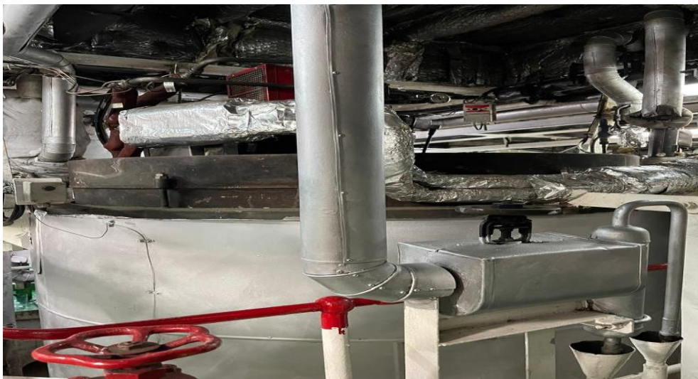
Ilustración 6: Caldera. Fuente: Elaboración propia.
