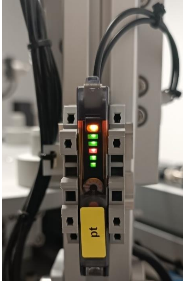
Figura 31: Amplificador de sensor pt de la estación FAS-209.
