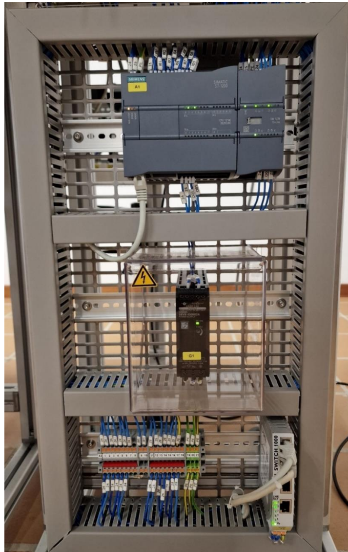
Figura 18: Panel eléctrico de la estación FAS-209.
