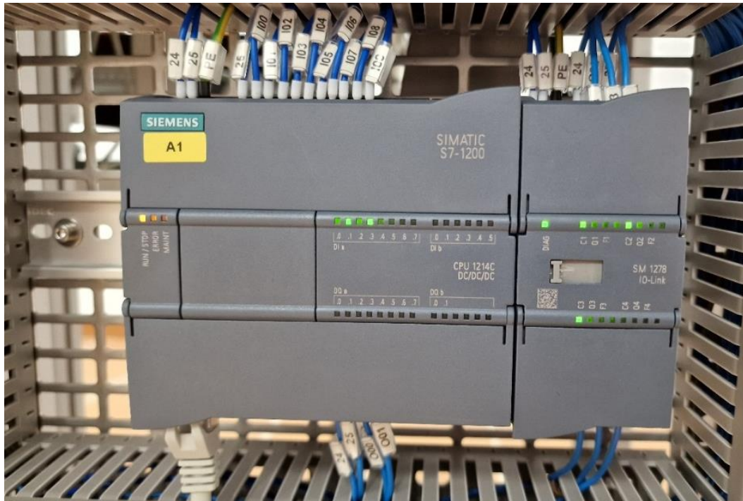
Figura 47: PLC S7-1200 utilizado para la estación FAS-209 y módulo IO-Link.
