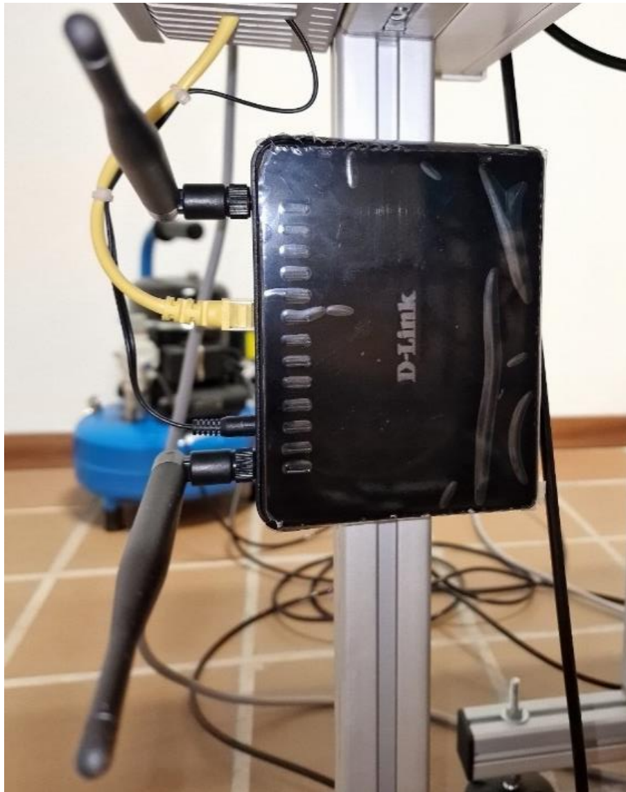
Figura 21: Router de la planta FAS-200.
