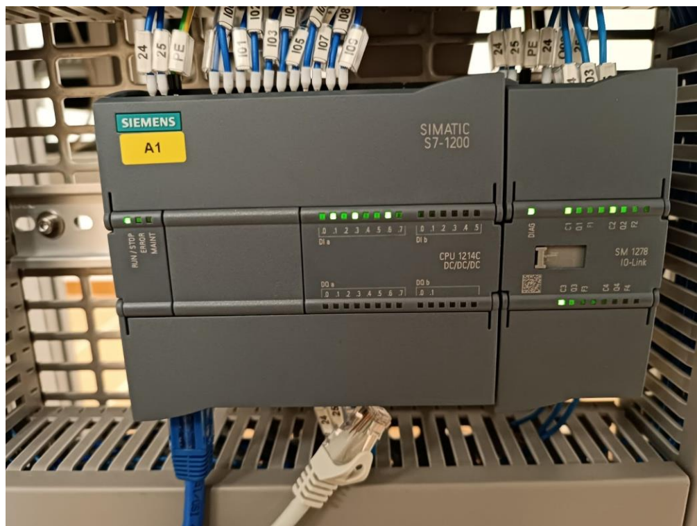
Figura 67: Autómata S7-1200 y Módulo IO-Link de la estación FAS-209.
