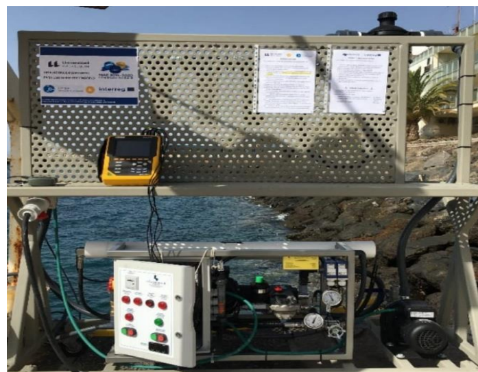
Foto 13: Desaladora de agua de mar por ósmosis inversa de pequeña escala (OSMOMAR OM-02.01)
