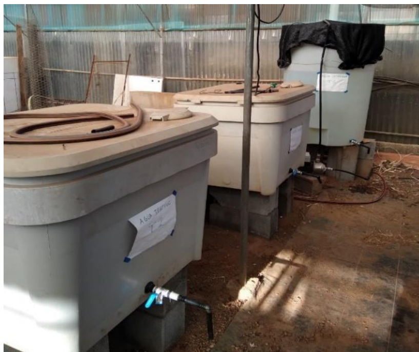
Foto 18: Depósitos de almacenamiento de tratamientos
