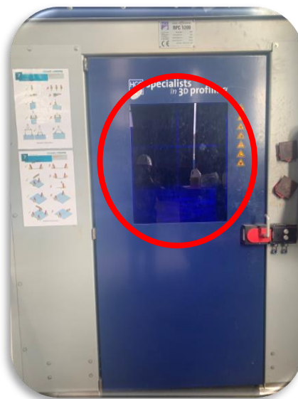
Ilustración n°23: Puerta de la celda de corte
