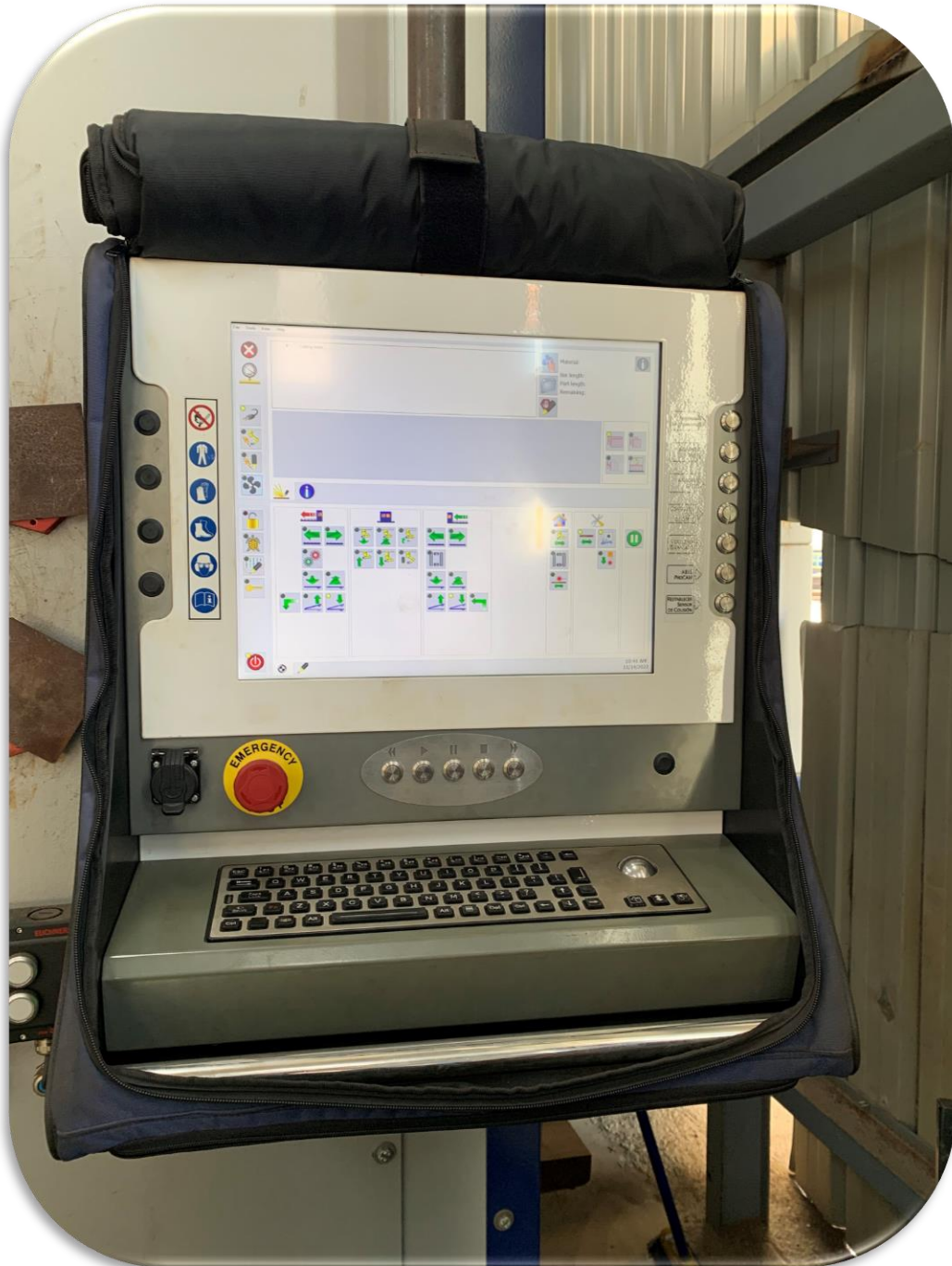
Ilustración n°27: Panel de control
