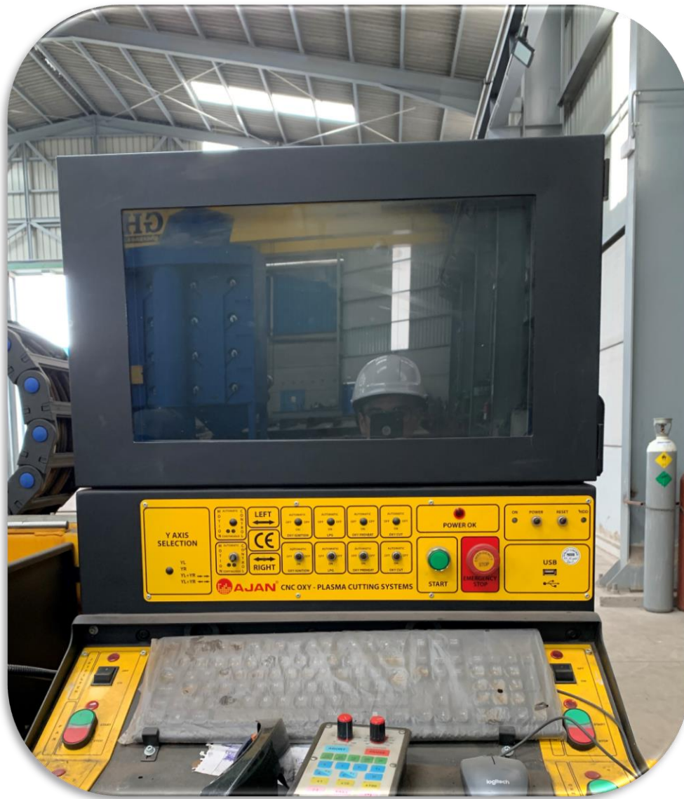
Ilustración n°19: Panel de control
