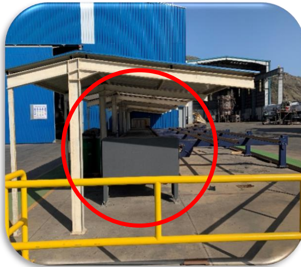
Ilustración n°25: Disposición de los rodillos de entrada Fuente: Trabajo de campo
