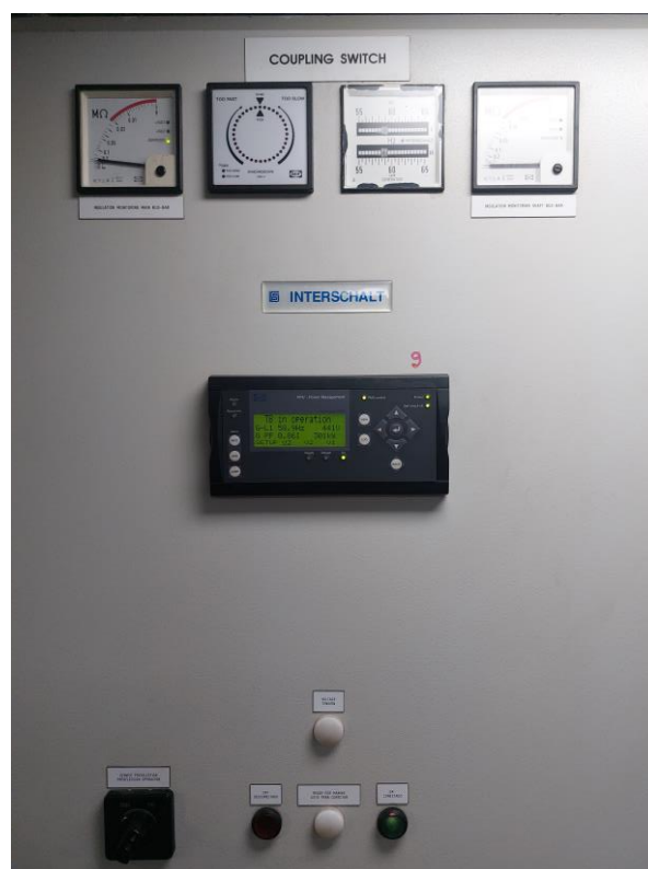
Ilustración 14. Cuadro eléctrico, coupling switch. Elaboración propia.
