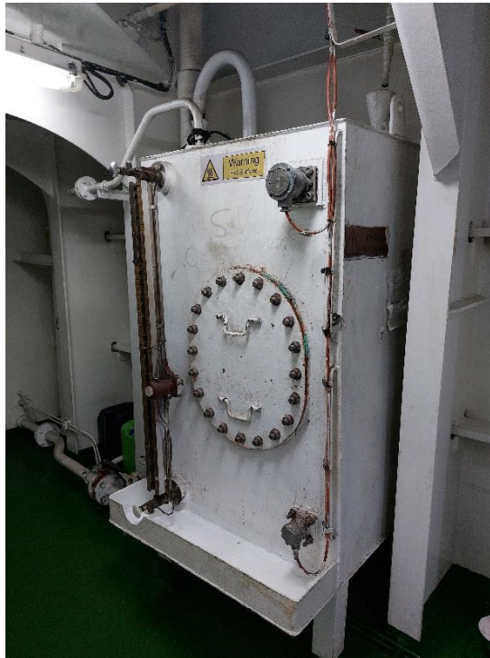
Ilustración 148. Tanque de expansión de HT. Elaboración propia.
