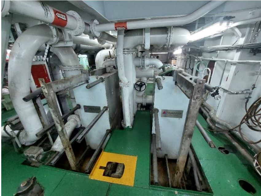
Ilustración 167. Enfriadores del sistema de baja temperatura. Elaboración propia.
