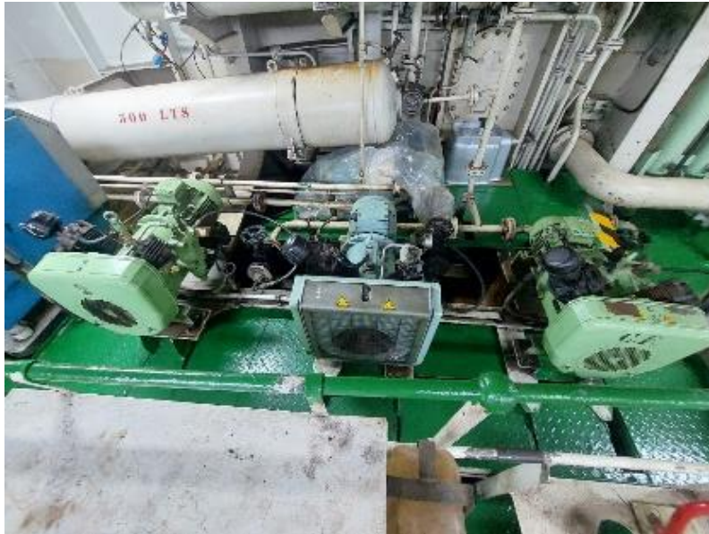
Ilustración 173. Compresores. Elaboración propia.
