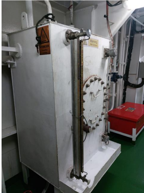
Ilustración 66. Tanque de compensación de agua de alta temperatura del motor principal. Elaboración propia.
