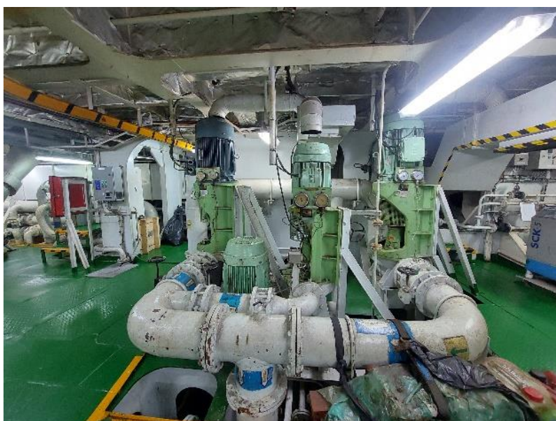
Ilustración 164. Bombas del sistema de baja temperatura. Elaboración propia.
