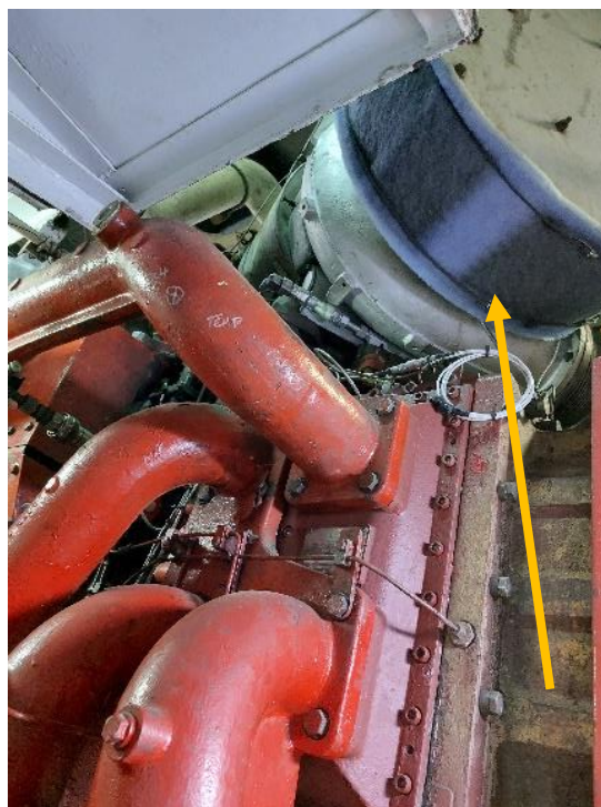
Ilustración 200. Cambio de filtrinas motor principal. Elaboración propia.
