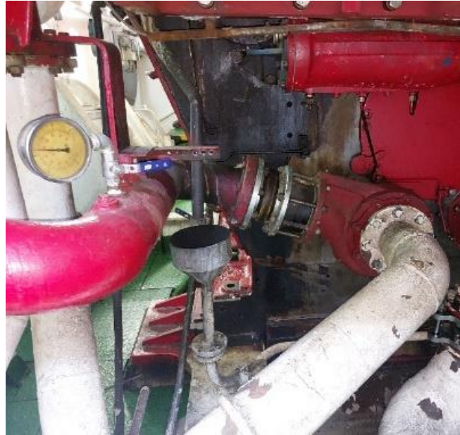
Ilustración 151. Bomba de engranajes acoplada al motor. Elaboración propia.
