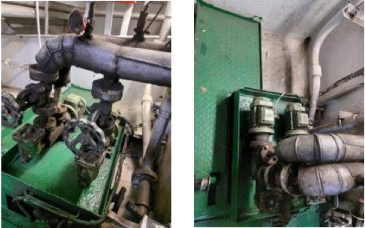
Ilustración 39. Bombas de combustible de la caldera. Elaboración propia.
