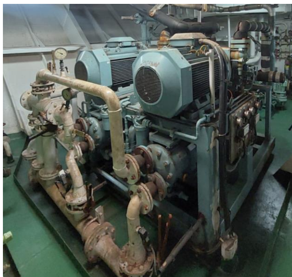
Ilustración 62. Compresores A/A. Elaboración propia.
