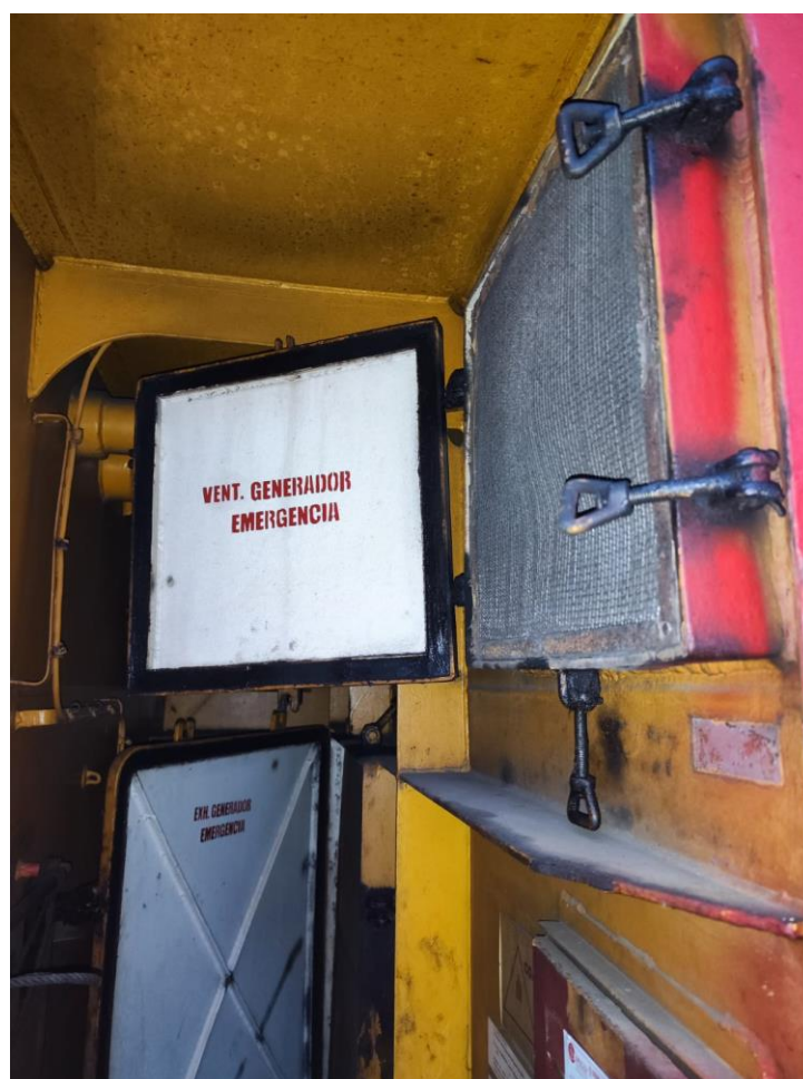
Ilustración 46. Ventilación local del generador de emergencia. Elaboración propia.
