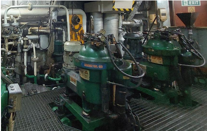
Ilustración 107. Depuradoras de combustible. Diesel / Fuel oil. Elaboración propia.
