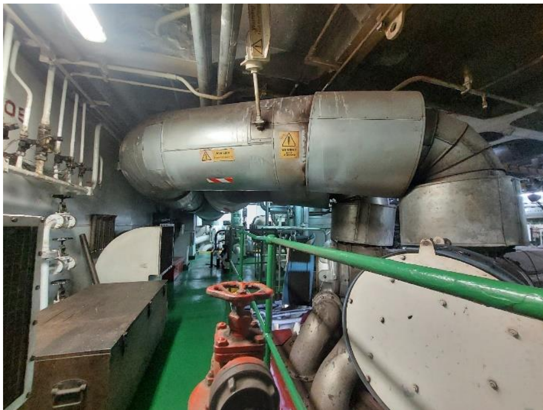
Ilustración 185. Salida de los gases de escape. Elaboración propia.
