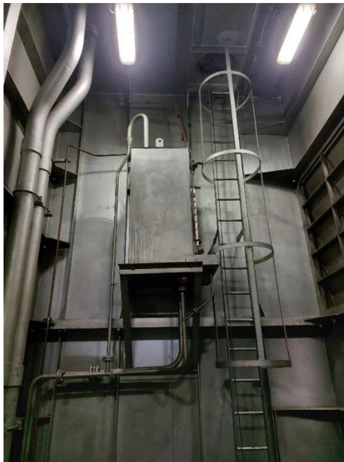
Ilustración 163. Tanque de expansión de LT. Elaboración propia.
