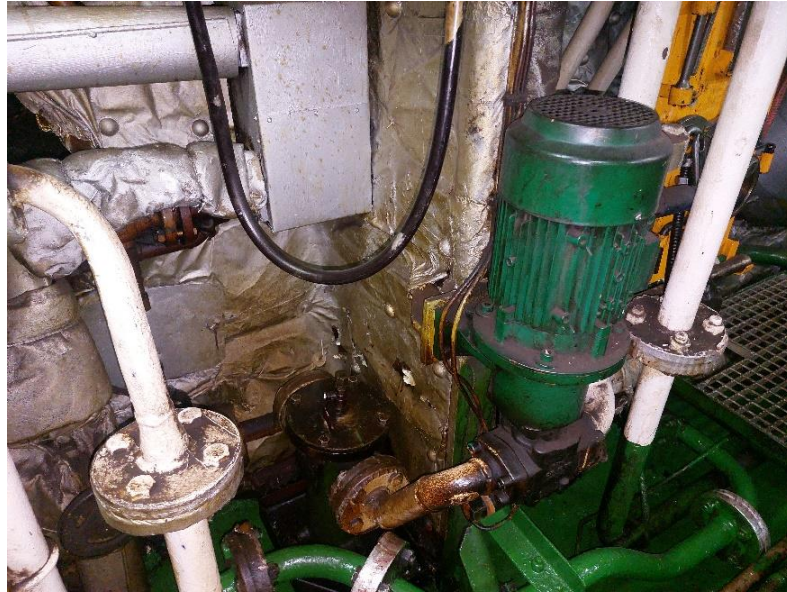
Ilustración 109. Bomba y filtro de la depuradora de GO. Elaboración propia.
