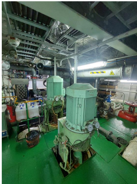
Ilustración 20. Planta de lastre y bombas de agua salada. Elaboración propia.
