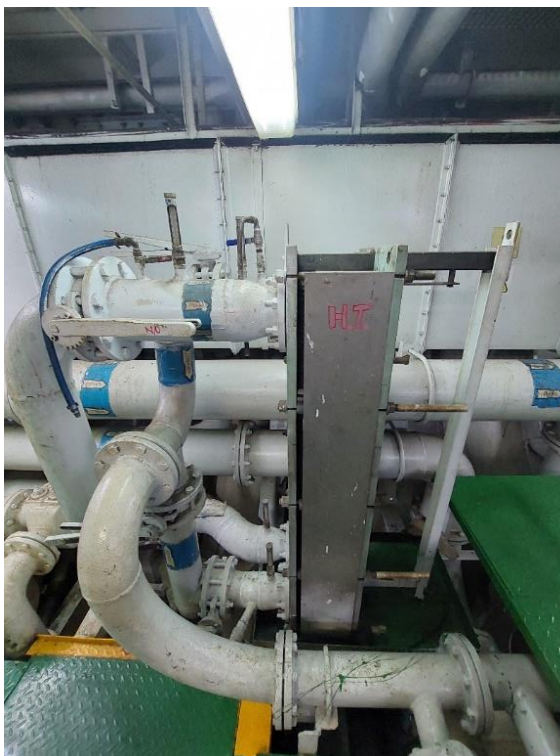
Ilustración 159. Enfriador de HT. Elaboración propia.
