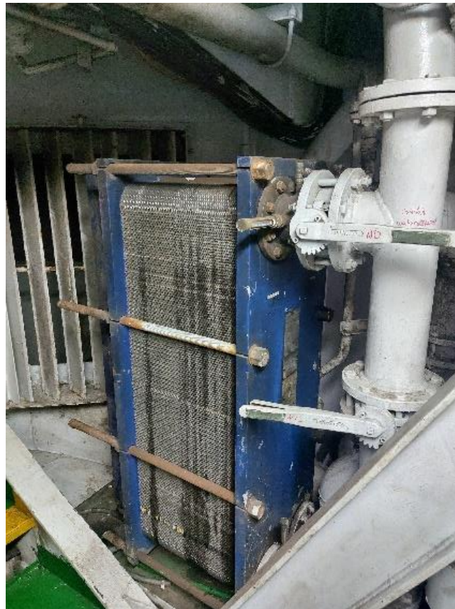
Ilustración 142. Enfriador de aceite. Elaboración propia.
