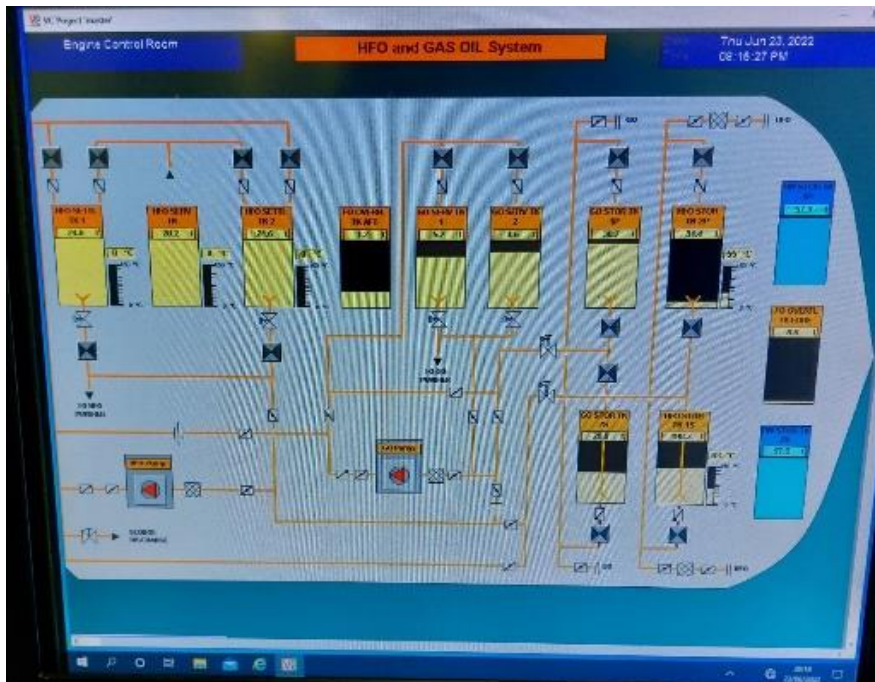
Ilustración 86. Niveles de los tanques de combustible. Elaboración propia.
