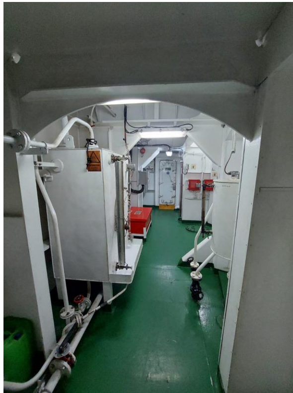
Ilustración 64. Local técnico de popa. Elaboración propia.
