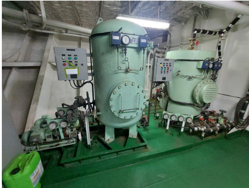
Ilustración 63. Hidróforo sanitario y calentador de agua. Elaboración propia.
