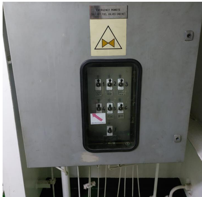
Ilustración 68. Grupo de accionamiento sobre válvulas de disparo rápido. Elaboración propia.
