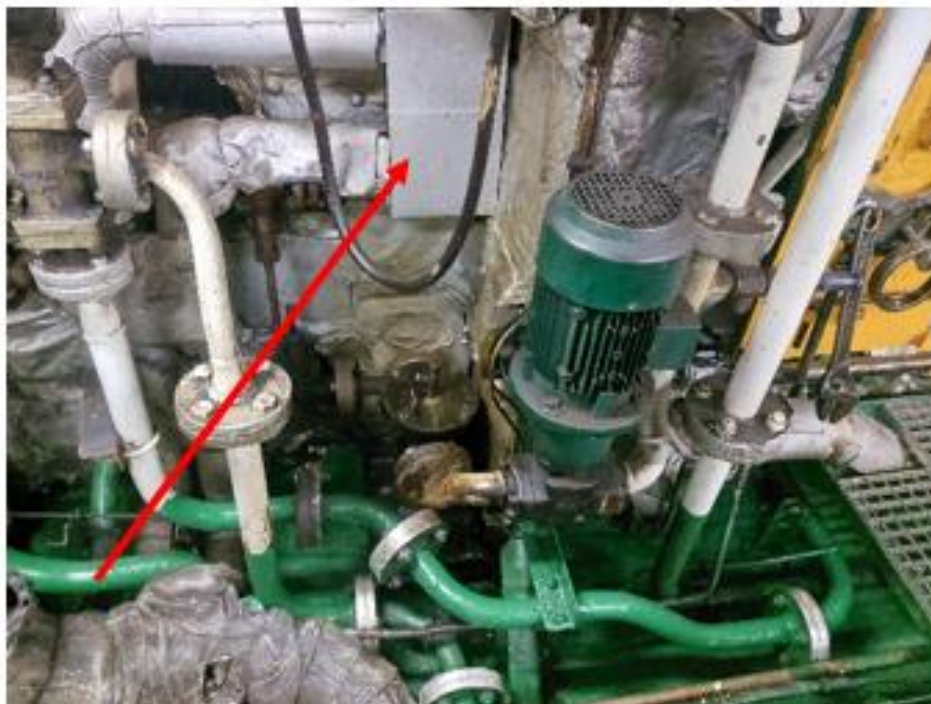
Ilustración 110. Calentador de la depuradora de GO. Elaboración propia.
