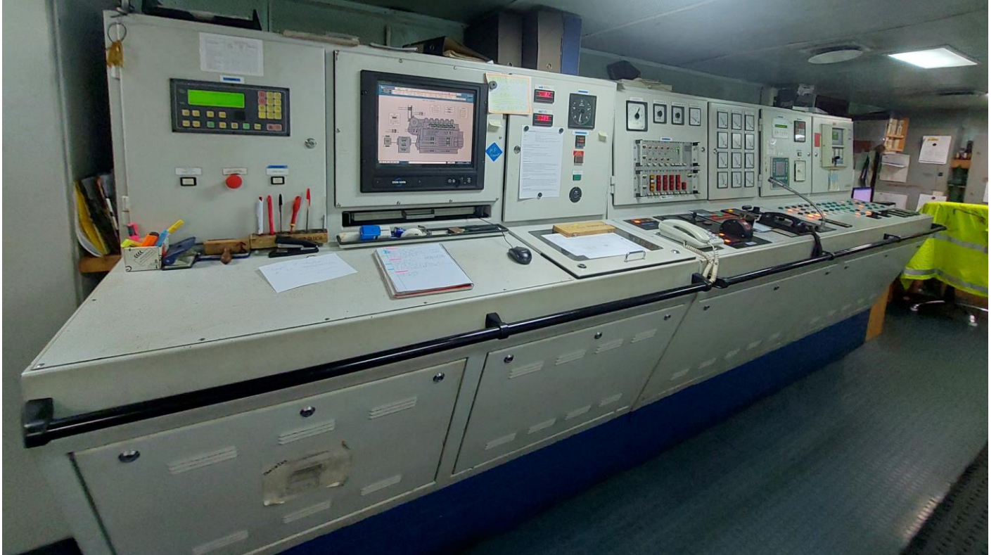
Ilustración 11. Panel de control general. Elaboración propia.
