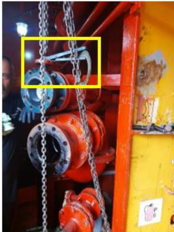
Ilustración 89. Válvula FT-15. Elaboración propia.
