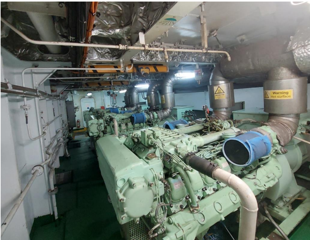
Ilustración 23. Local de motores auxiliares. Elaboración propia.
