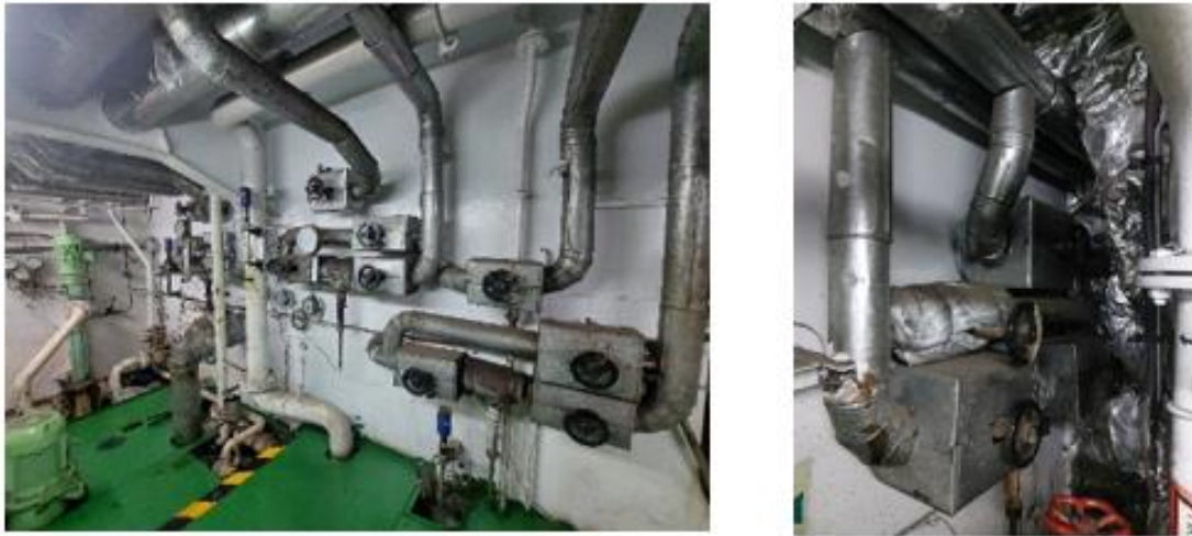
Ilustración 104. Sistema de calefacción por aceite térmico de los tanques de sedimentación. Elaboración propia.
