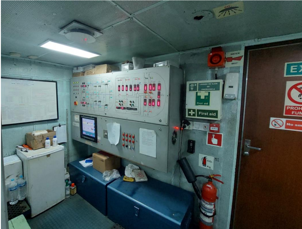
Ilustración 15. Control de máquinas. Elaboración propia.
