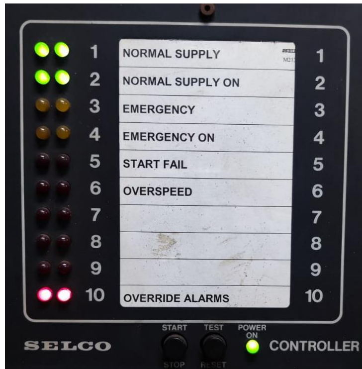
Ilustración 49. Alarmas generador de emergencia. Elaboración propia.
