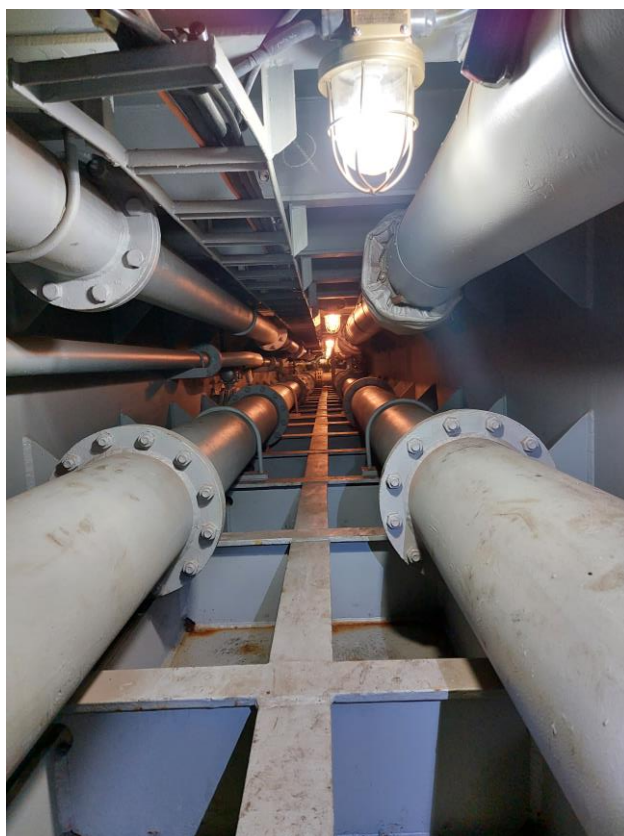
Ilustración 70. Interior del túnel de válvulas. Elaboración propia.
