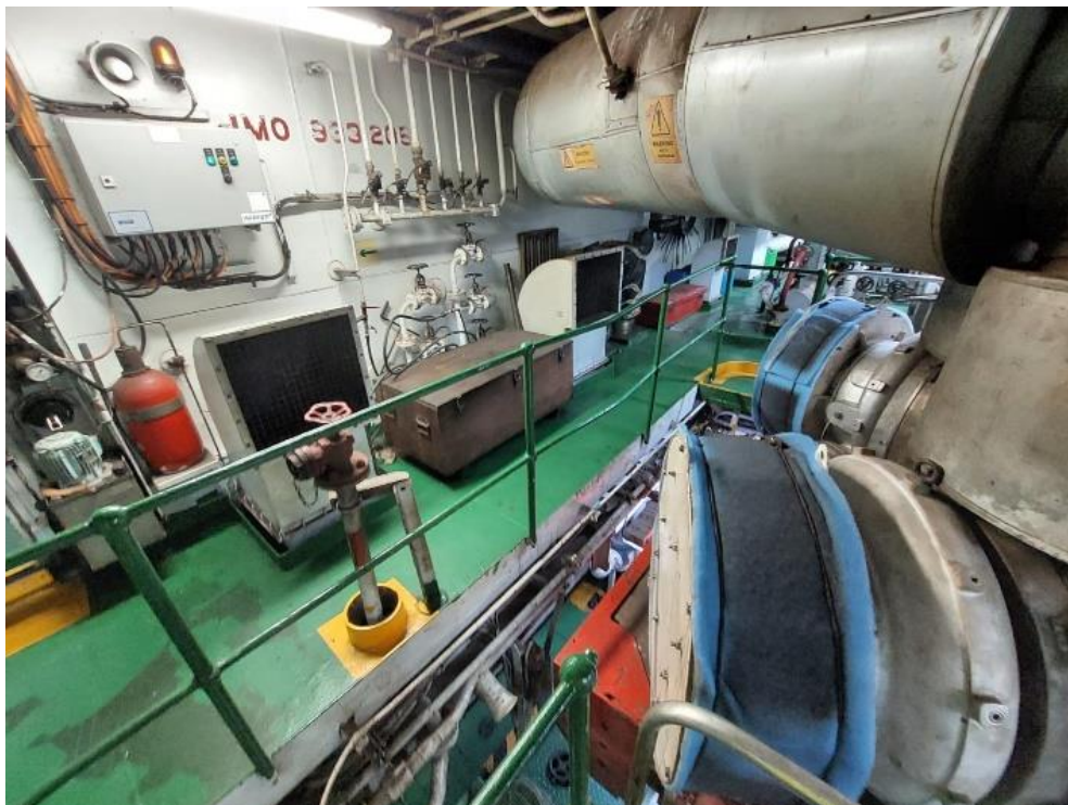
Ilustración 184. Ventilación directa hacia los turbocompresores. Elaboración propia.
