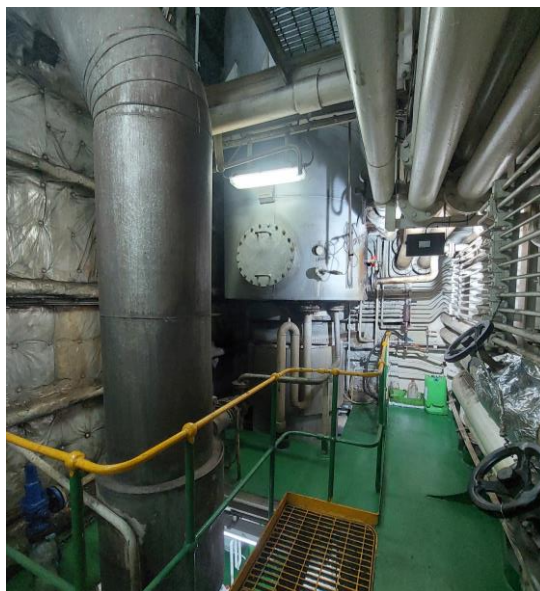
Ilustración 32. Zona caldera de recuperación. Elaboración propia.
