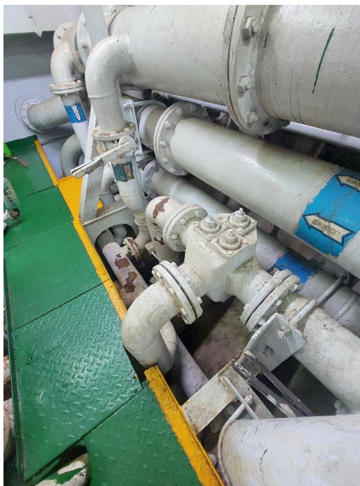
Ilustración 160. Termostática a la salida del enfriador. Elaboración propia.
