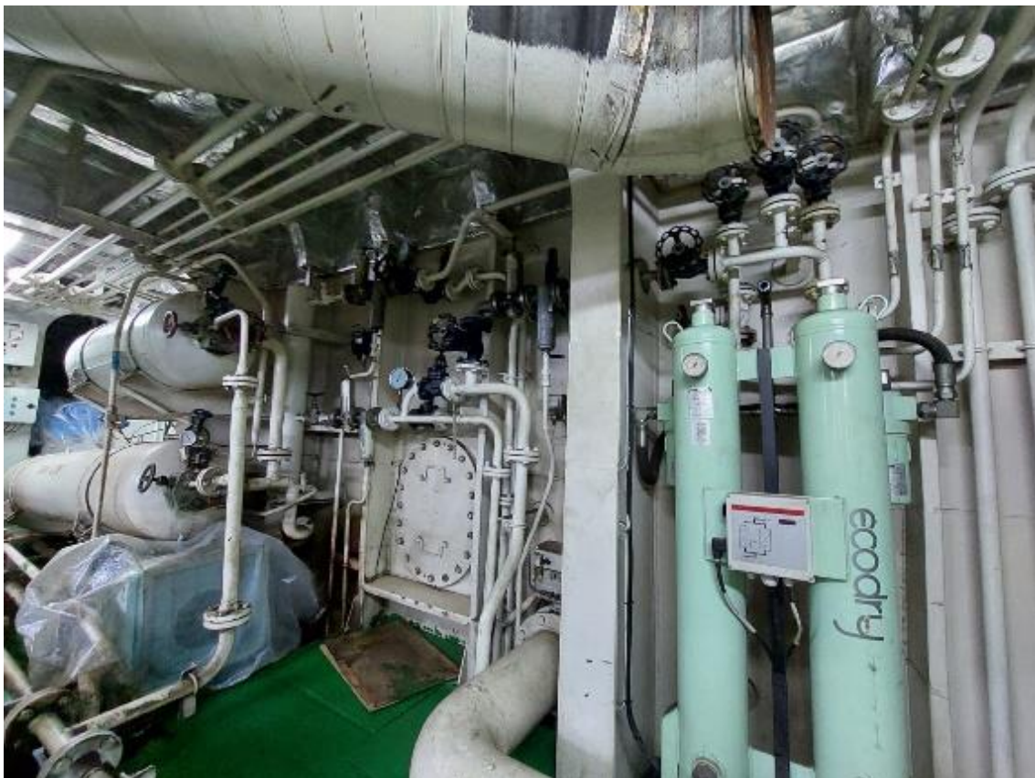
Ilustración 180. Vista de varios elementos del sistema de aire. Elaboración propia.
