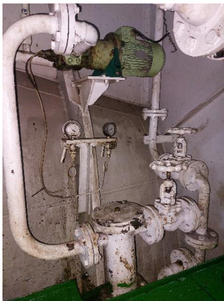
Ilustración 134. Bomba y filtro de la depuradora de aceite. Elaboración propia.
