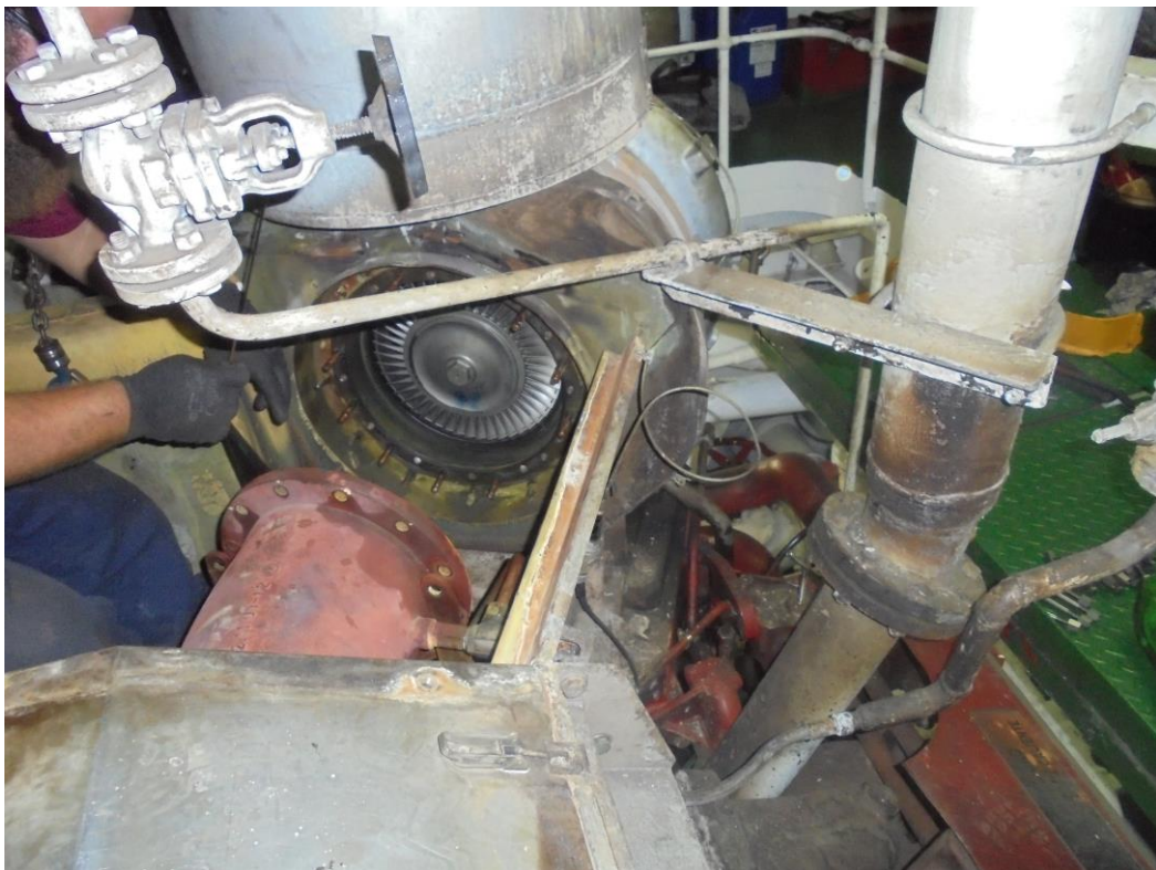
Ilustración 187. Turbocompresor lado de gases. Elaboración propia.
