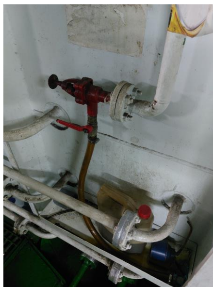
Ilustración 22. Toma de aceite de motores auxiliares. Elaboración propia.
