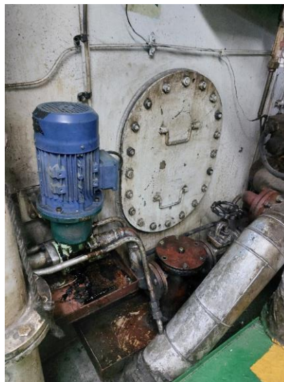
Ilustración 108. Bomba y filtro de la depuradora de FO. Elaboración propia.
