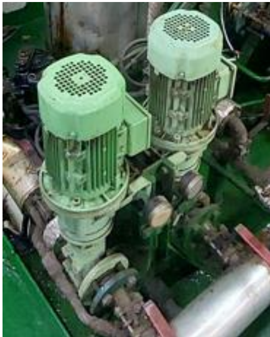
Ilustración 118. Bombas de alimentación. Elaboración propia.
