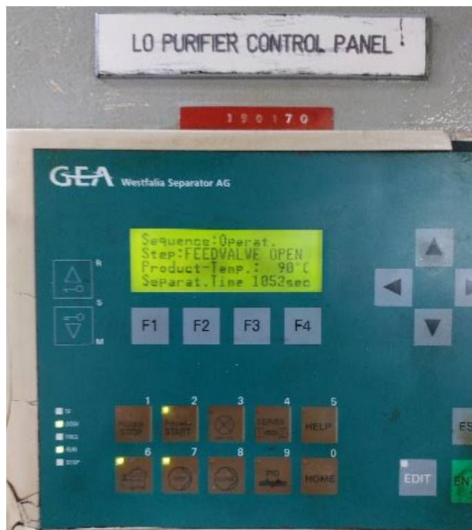
Ilustración 136. Display de la depuradora de aceite. Elaboración propia.
