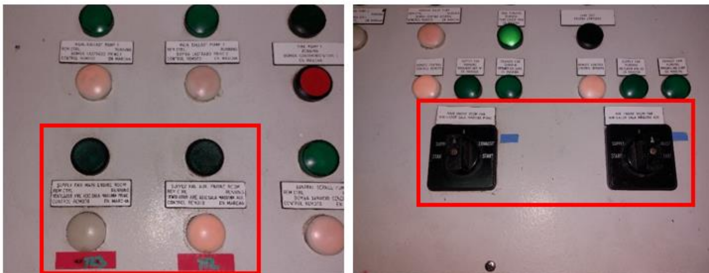
Ilustración 183. Selectores para actuar sobre los ventiladores de la sala de máquinas. Elaboración propia.
