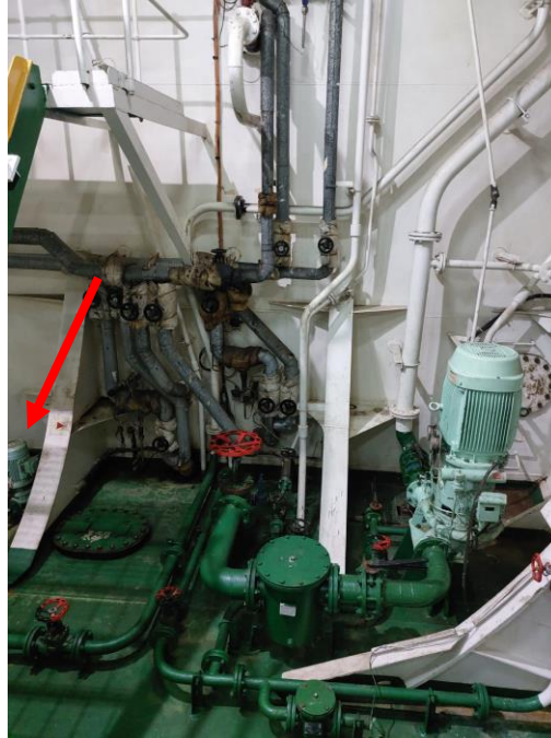
Ilustración 59. Bomba C/I de emergencia. Elaboración propia.
