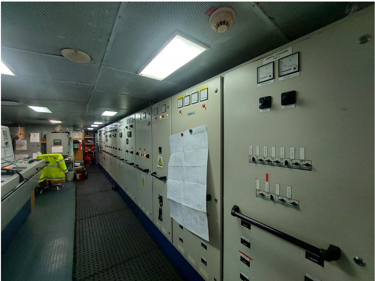
Ilustración 12. Cuadros eléctricos. Elaboración propia.
