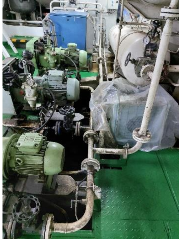
Ilustración 176. Conducto de aire desde los compresores hacia las botellas. Elaboración propia.
