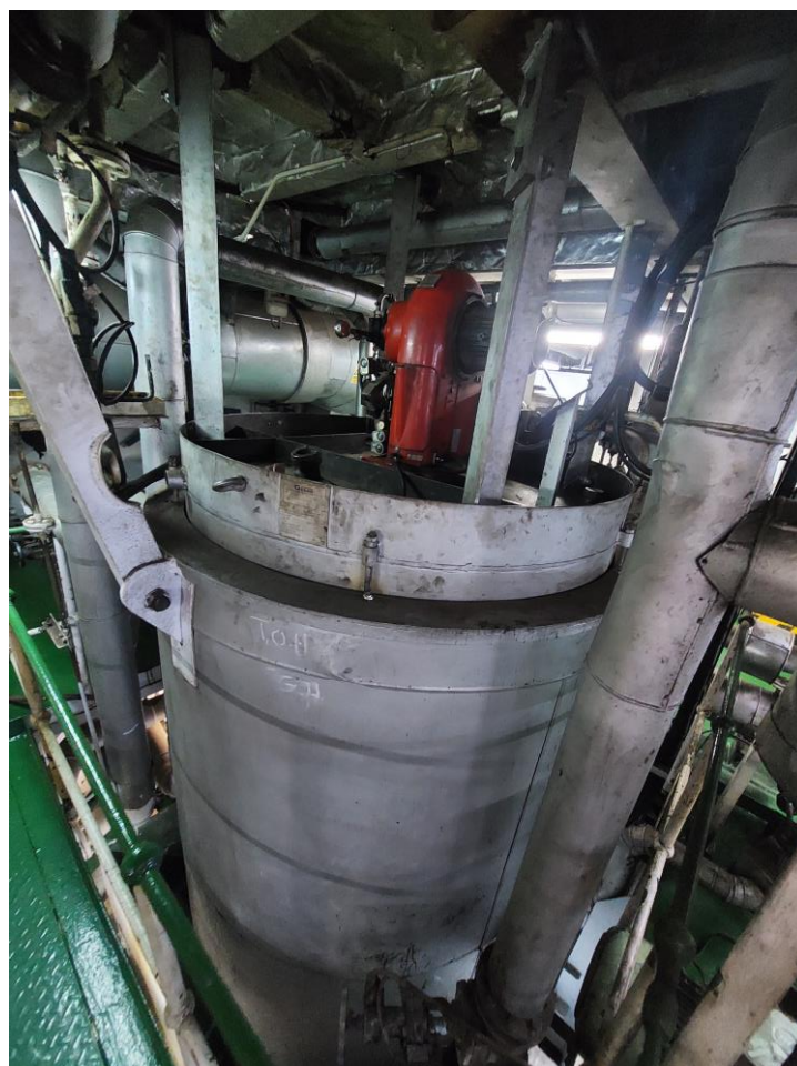
Ilustración 34. Caldera de aceite térmico. Elaboración propia.
