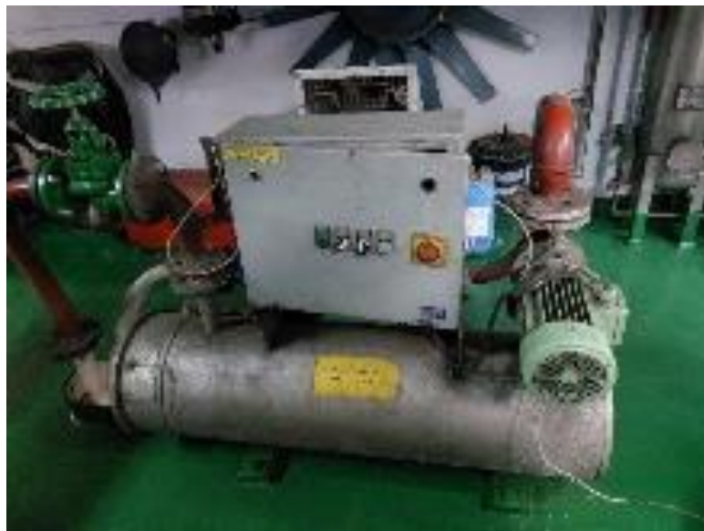
Ilustración 149. Unidad de precalentamiento. Elaboración propia.
