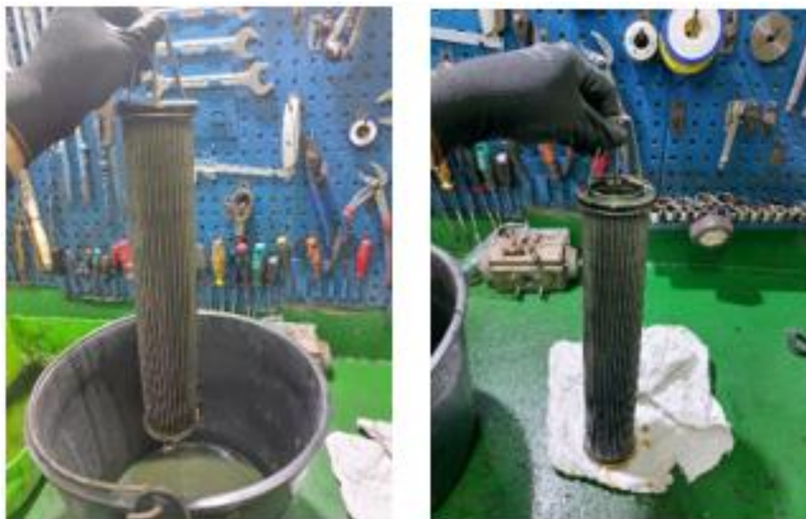
Ilustración 215. Limpieza filtro aceite de reductora. Elaboración propia.
