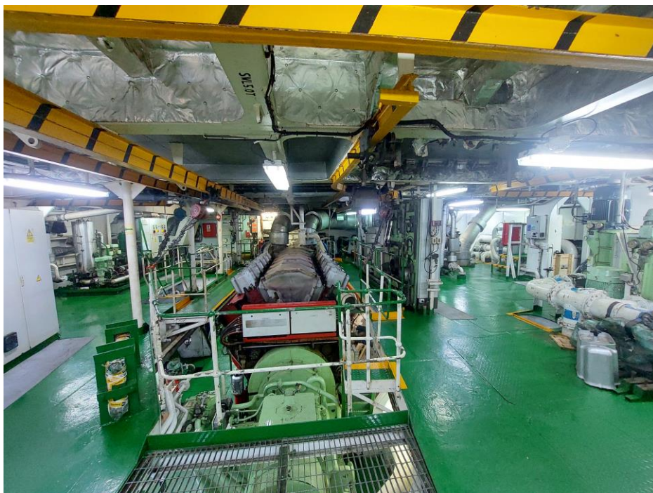
Ilustración 35. Vista general sala de motor principal, tecla superior. Elaboración propia.
