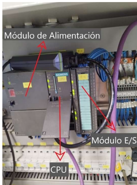
Figura 3.3: CPU y módulos instalados.
