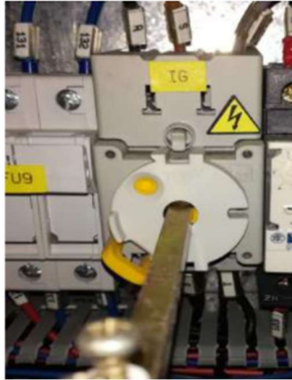
Figura 3.10: Interruptor General de Alimentación.
