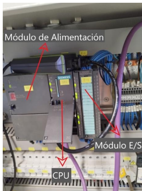
Figura 3.3: CPU y módulos instalados.
