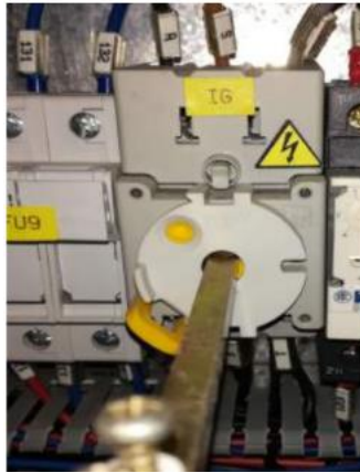
Figura 3.10: Interruptor General de Alimentación.
