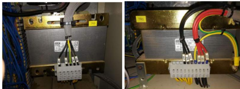
Figura 3.9: A la izqda. Transformador de 400/230 V. A la dcha. Transformador de 400/120V.
