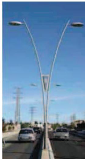
Ilustración 8. Soporte luminaria vía 2.
