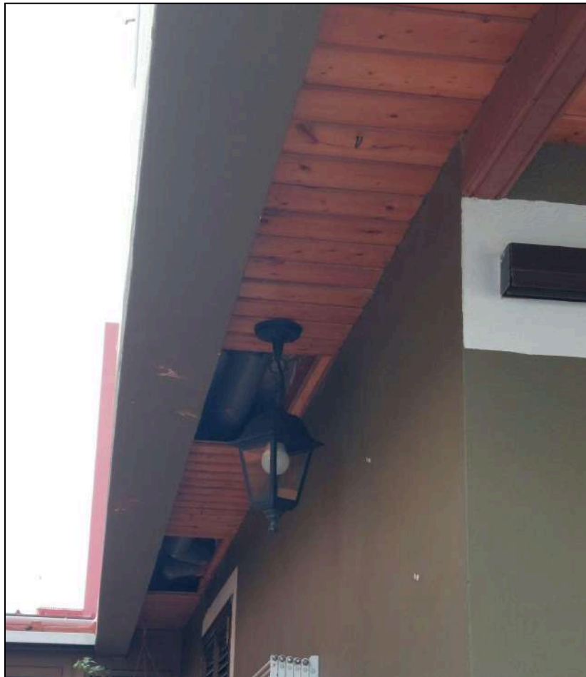
Imágen 5. Falso Techo Exterior en vivienda de la urbanización
