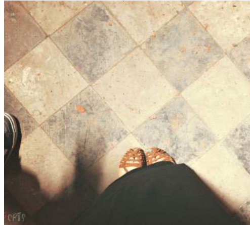
Estado del suelo ajedrezado (Abril, 2015) - Fuente: propia
