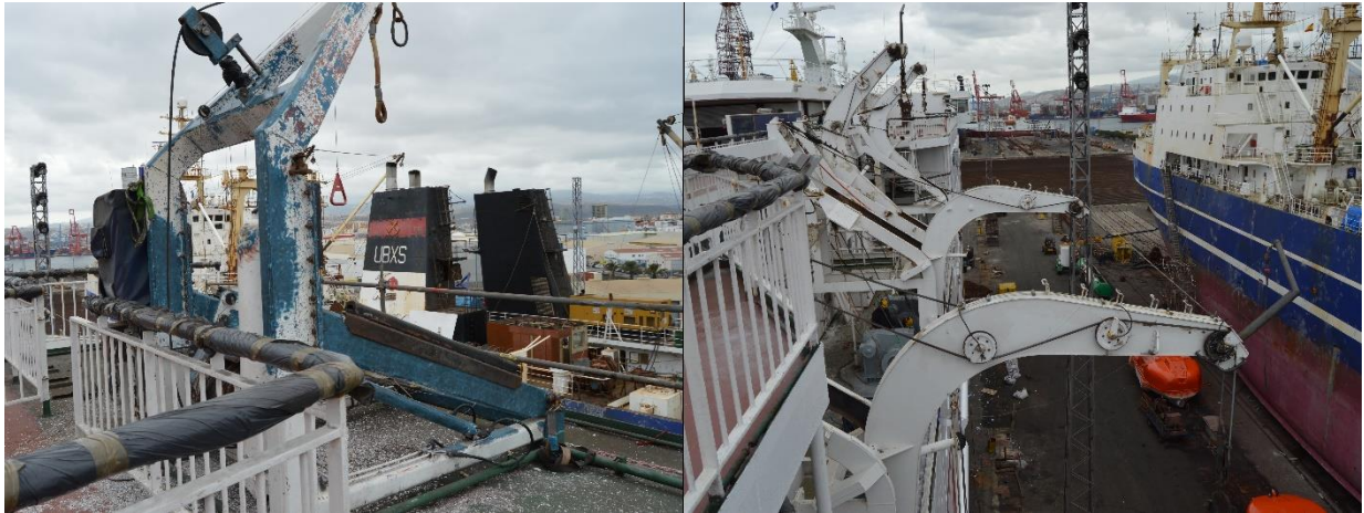
30. A la izquierda, trabajos de saneamiento en el pescante del bote de rescate rápido. A la derecha, mantenimiento a los pescantes y maquinillas de los botes salvavidas.
