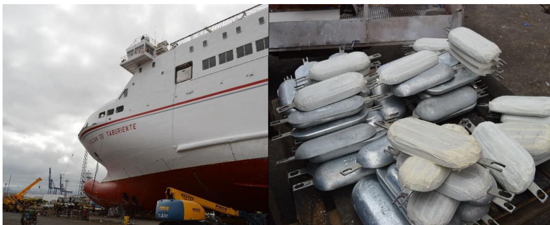
37. A la izquierda, pintado del casco sección de proa. A la derecha, ánodos de sacrificio nuevos para renovar.
