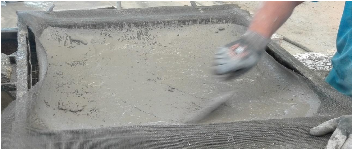
Figura 6.6. Malla de protección [Fuente propia].
