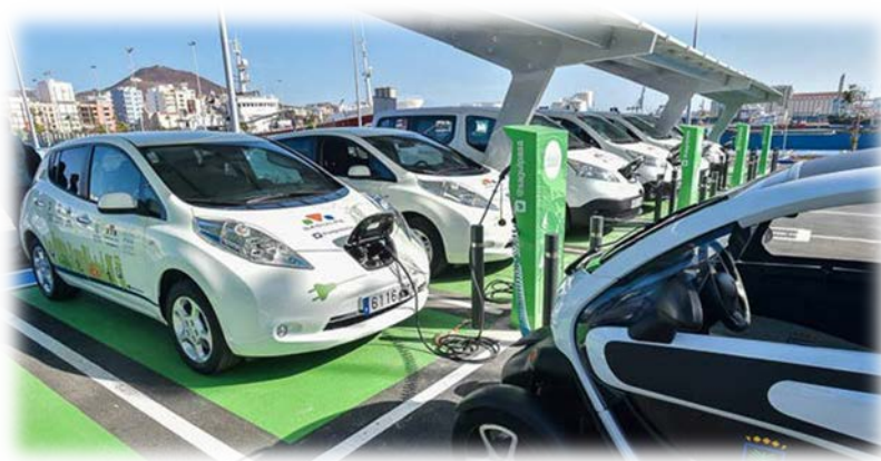
Ilustración 7. Estación de carga fotovoltaica para vehículos en Gran Canaria.
