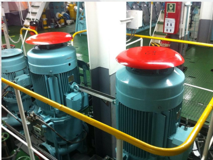
Imagen de las bombas contraincendios ubicadas en el doble fondo de la Sala de Máquinas (Archivo: Alfonso Fortuny).
