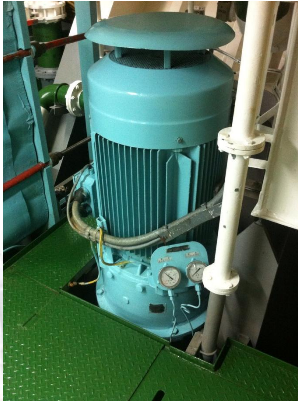
Imagen de la bomba de limpieza situada junto a las bombas contraincendios en la cubierta más baja de la cámara de Máquinas (Archivo: Alfonso Fortuny).
