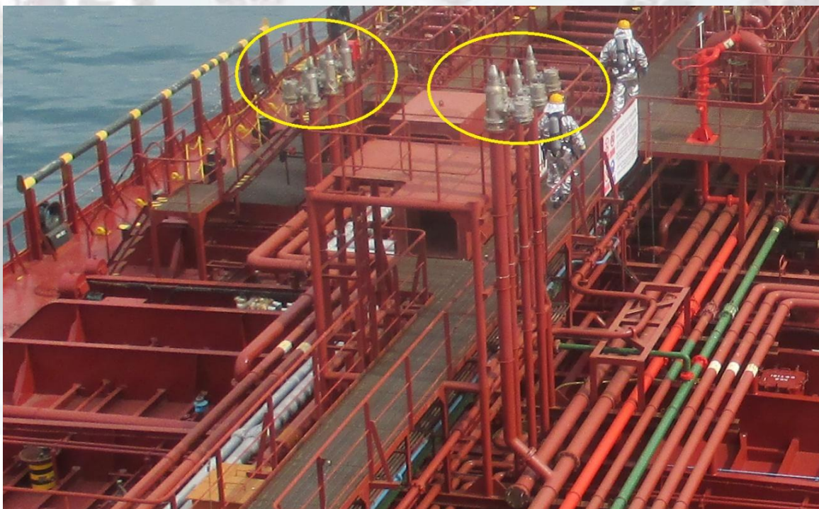
Imagen de la torreta de válvulas presión / vacío de popa, que tiene las válvulas de los tanques TC6BE, TC7BE, TC8E, TSLOPBR y N 2 (Archivo: Alfonso Fortuny).
