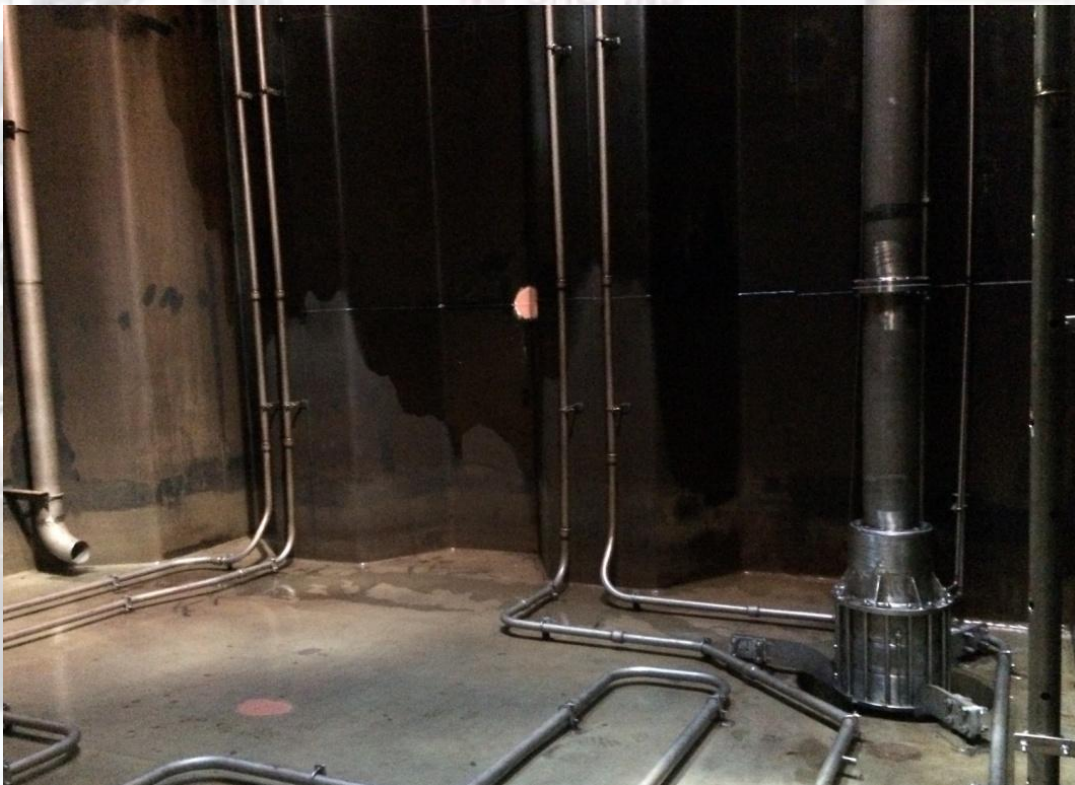
Imagen de la estructura interna de un tanque. (Archivo Alfonso Fortuny)
