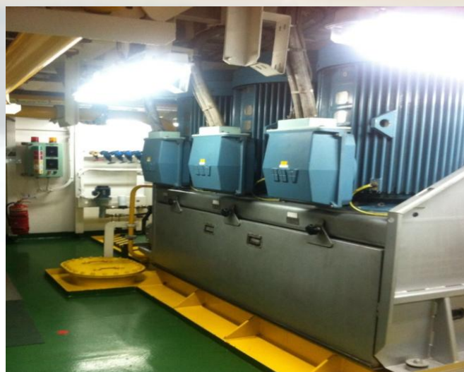
Imagen de las bombas de FRAMO en el local del FRAMO, en la Sala de Máquinas (Archivo: Alfonso Fortuny)
