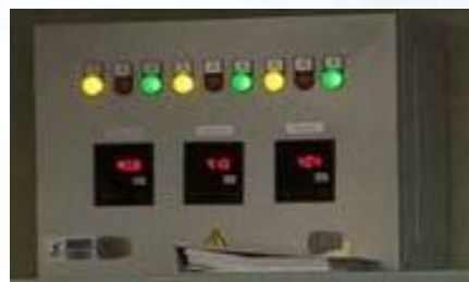
Imagen de los indicadores de amperaje de los motores auxiliares (Archivo Alfonso Fortuny)
