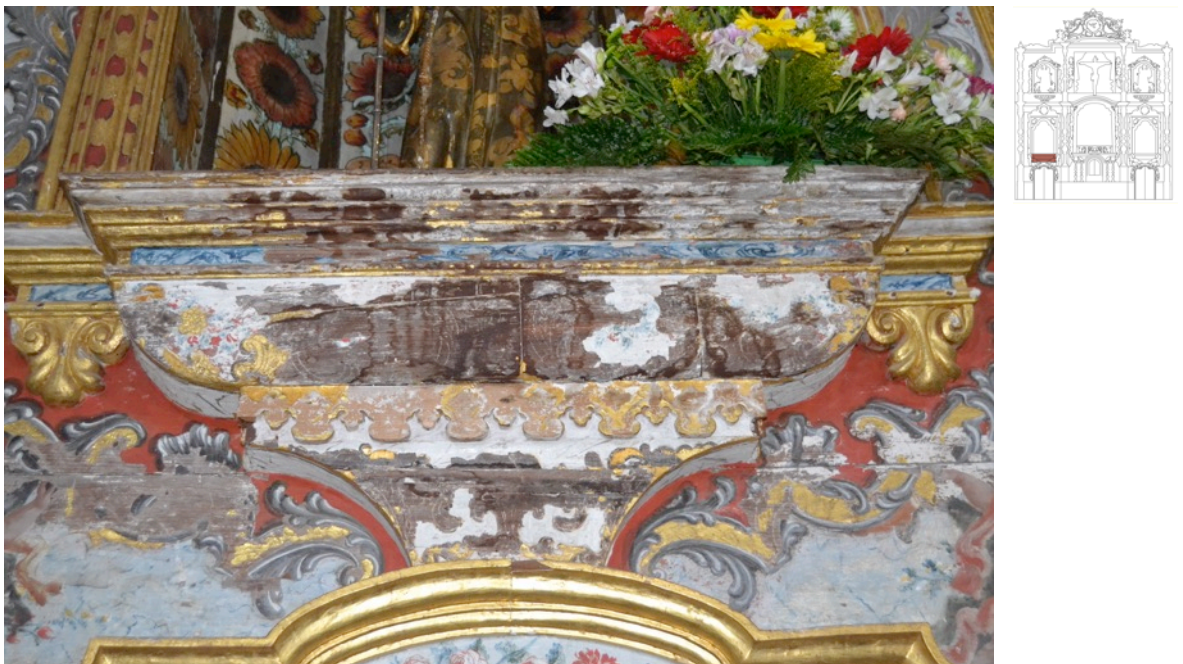
Imagen 53. Estado de conservación de la peana del lado del Evangelio. Lagunas que dejan a la vista la capa de preparación y el soporte. Fuente: de la autora.
