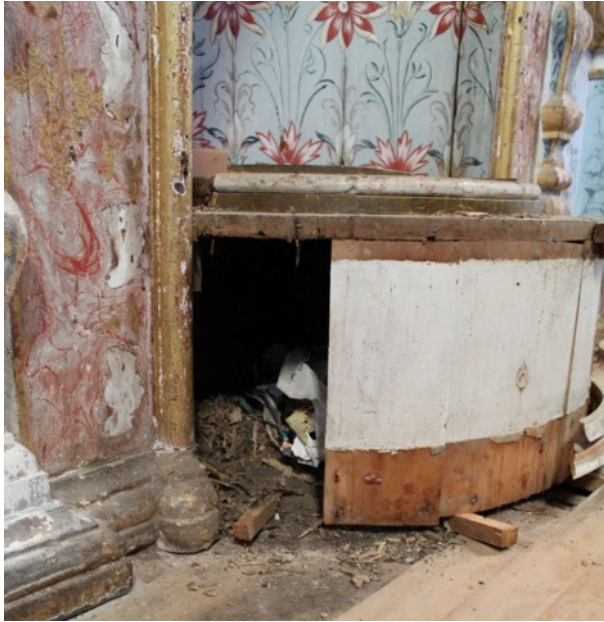
Imagen 47. Acumulación de residuos y restos de roedores en el interior del tambor. Fuente: Pablo Torres Luis.
