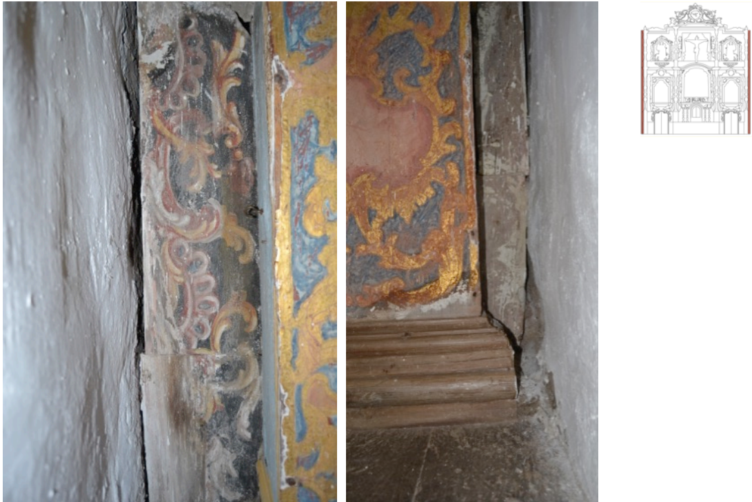
Imagen 51 y 52. Estado de conservación de los guardapolvos. Lagunas que dejan a la vista la capa de preparación y el soporte, suciedad superficial y pérdida de sección de soporte. Fuente: de la autora.
