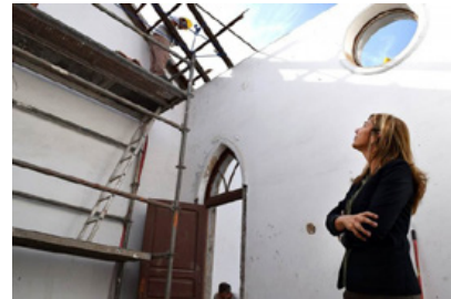
Img.4: La concejala de Patrimonio visita la rehabilitación de la capilla anglicana en el año 2015. Tomada del Diario de Avisos. www.diariodeavisos.com
