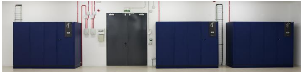
Figura 3: Armarios de los CRAC's
