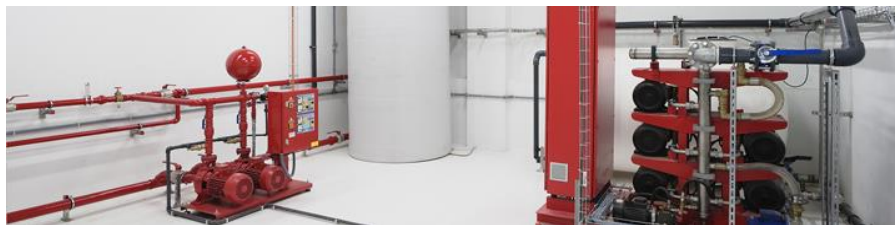
Figura 5: Sistemas de protección contra incendios
