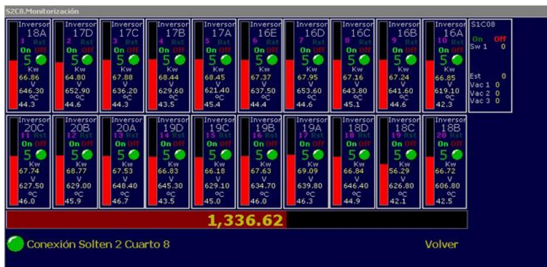
Figura 19: Pantalla de los Inversores de Solten 2 Cuarto 8
