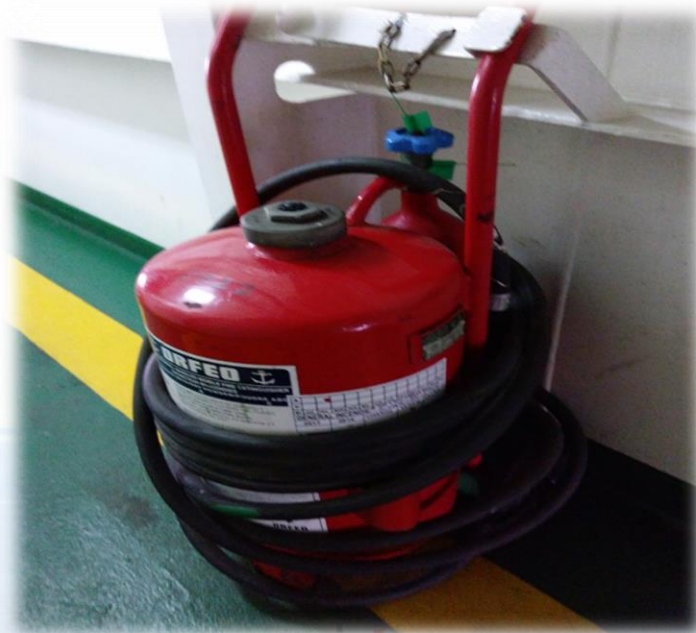
Ilustración 13. Extintor portátil de polvo seco del Super Fast Baleares situado cerca del generador de emergencia. Trabajo de campo.
