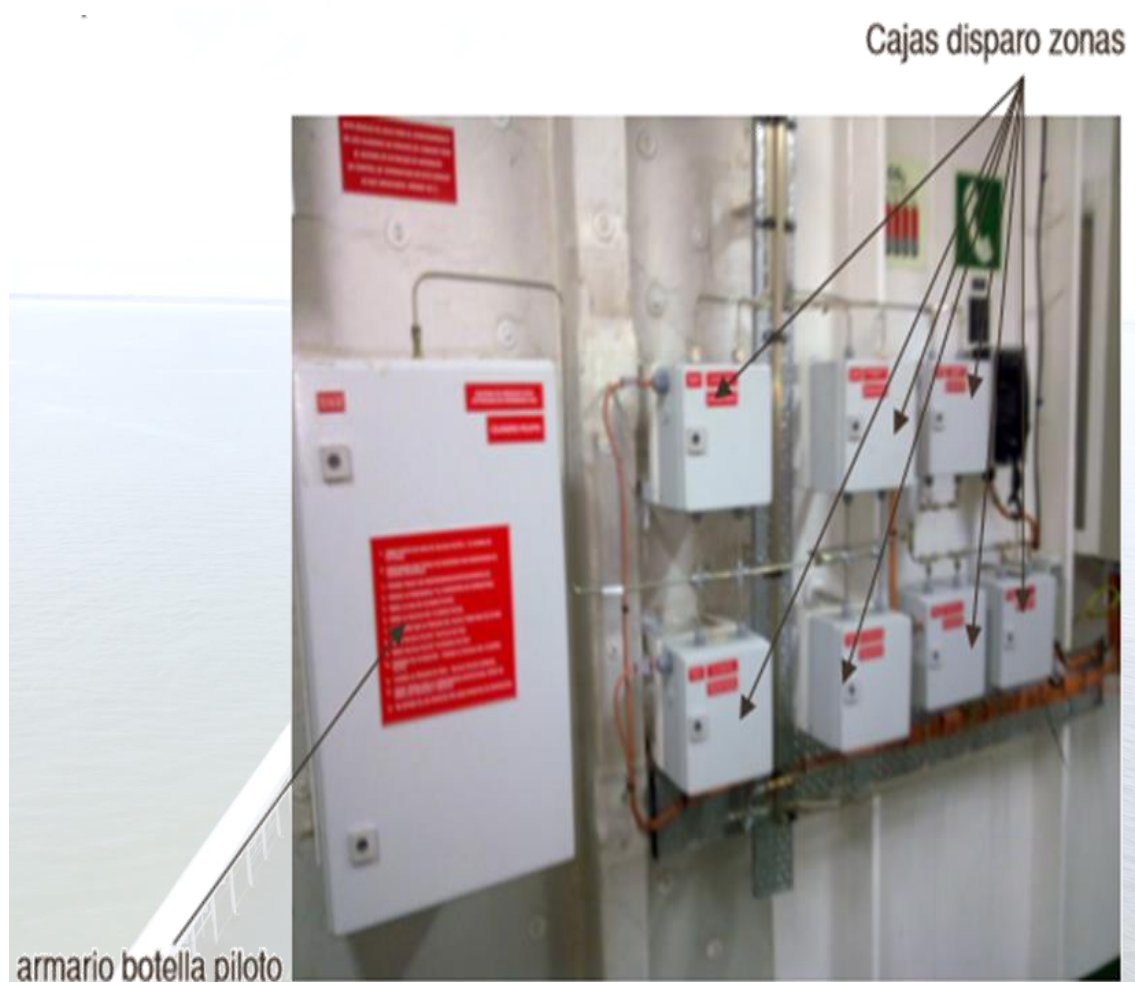
Ilustración 51. Caja (grande) armario botella piloto, para presurizar la línea. Cajas pequeñas diferentes módulos que pueden ser rociados. Fuente manual de procedimientos del SFB.
