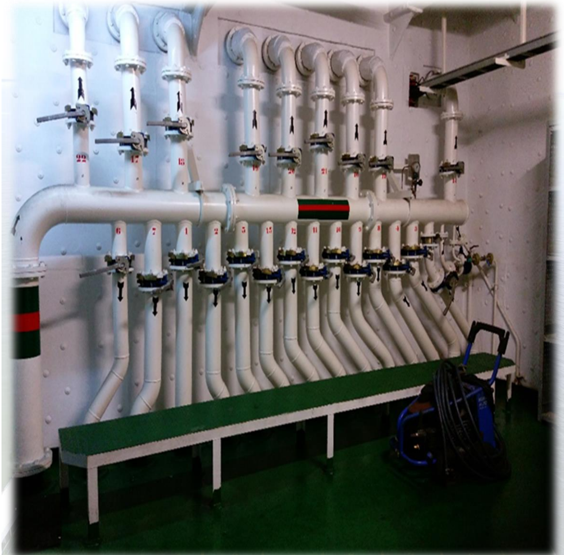
Ilustración 45. Cubierta nº 5, popa babor, local Drencher o rociadores de garaje. Trabajo de campo.
