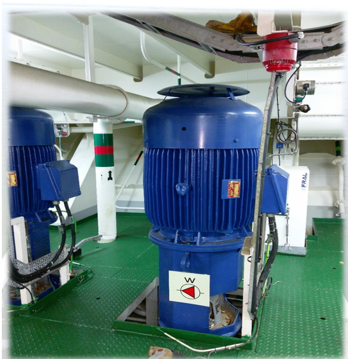
Ilustración 39. Bombas contraincendios situadas en la cubierta 1. Fuente: Trabajo de campo.
