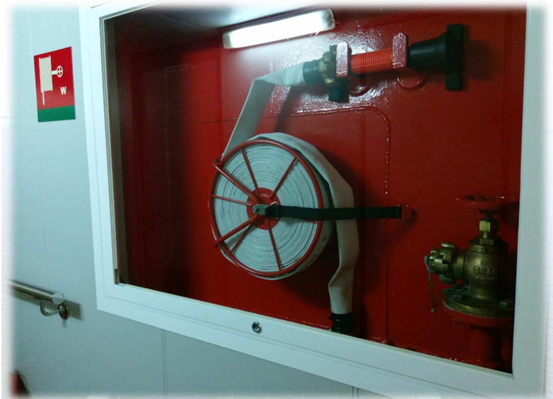
Ilustración 27. Manguera contraincendios situada en la cubierta 9, habitación de oficiales. Fuente: Trabajo de campo.
