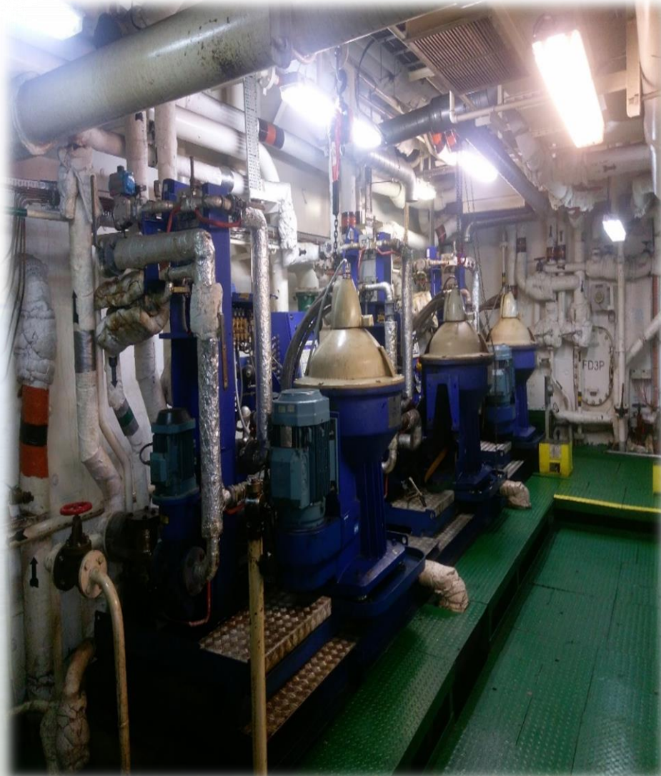
Ilustración 65. Depuradoras. Fuente: Trabajo de campo.
