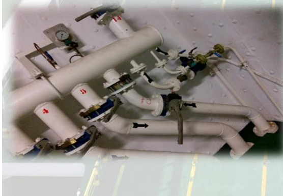
Ilustración 48. Tuberías locales drencher. Trabajo de campo.
