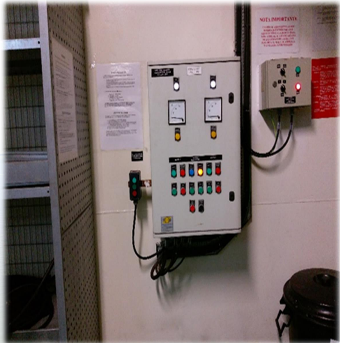
Ilustración 46. Cuadro de control local drencher. Fuente: Trabajo de campo.
