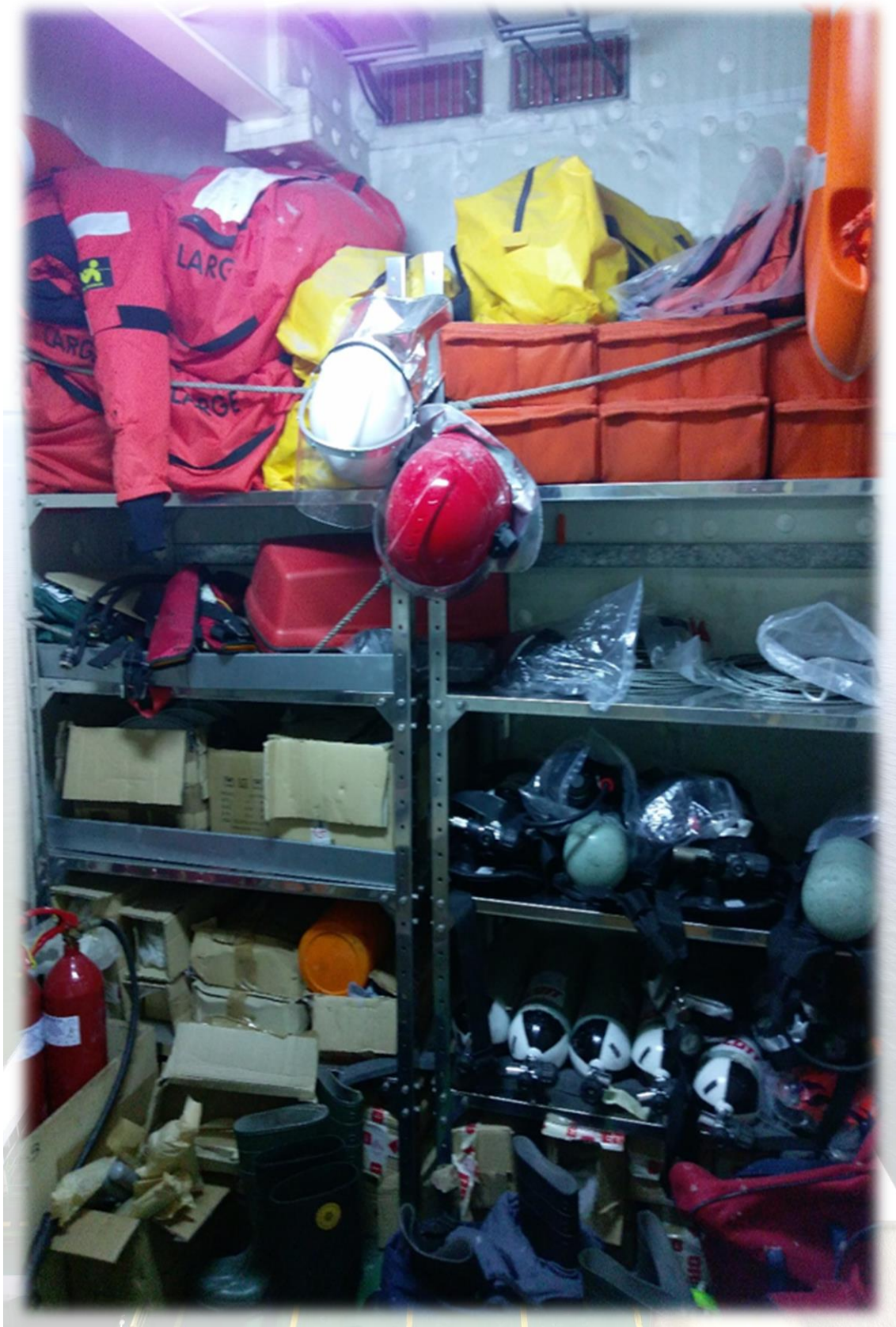
Ilustración 366. Estación contra incendios n°2 situada en la cubierta 8. Fuente: Trabajo de campo.
