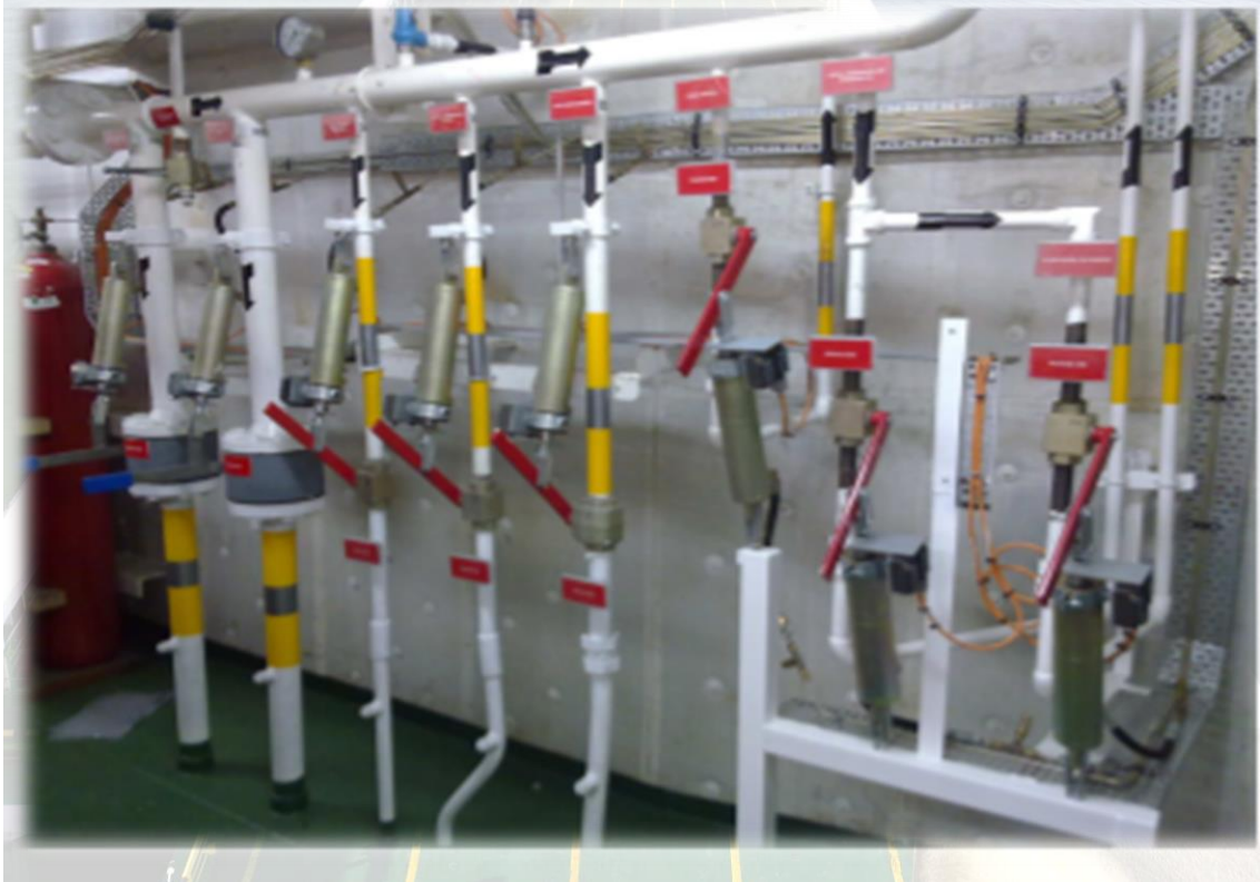
Ilustración 55. Accionamiento manual de las diferentes secciones. Fuente: Trabajo de campo.
