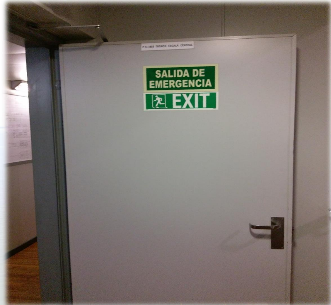
Ilustración 69. Puerta contraincendios clase A. Fuente: Trabajo de campo.
