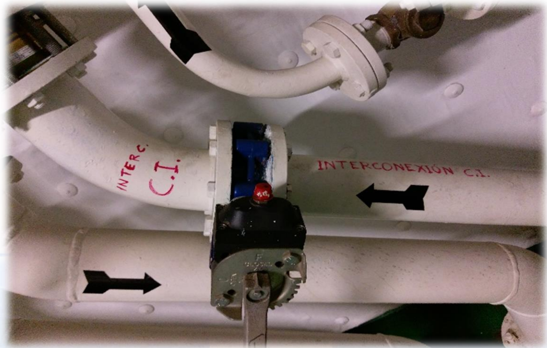
Ilustración 47. Tubería contraincendios del local drencher. (línea de alimentación extra). Fuente: Trabajo de campo.
