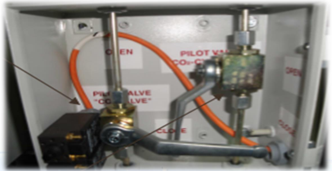
Ilustración 54. Válvula piloto (flecha izquierda) y válvula de apertura de la línea. Manual de procedimientos.
