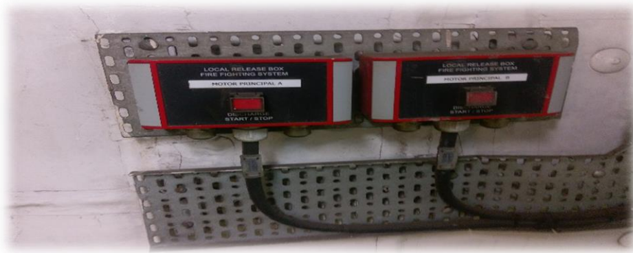
Ilustración 59. Pulsadores remotos de las bombas contraincendios situados en sala de máquinas. Trabajo de campo.
