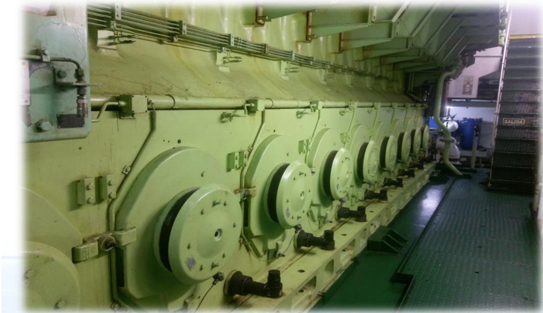
Ilustración 61. Base de uno de los cuatro motores principales. Fuente: Trabajo de campo.
