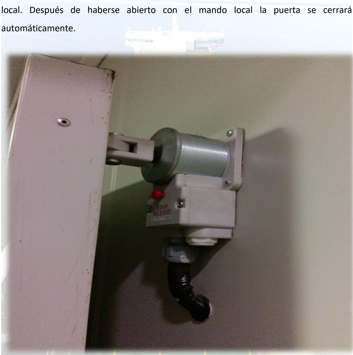
Ilustración 70. Electroimán de las puertas contraincendios, habilitados para cierre a distancia desde el puente. Trabajo de campo.
