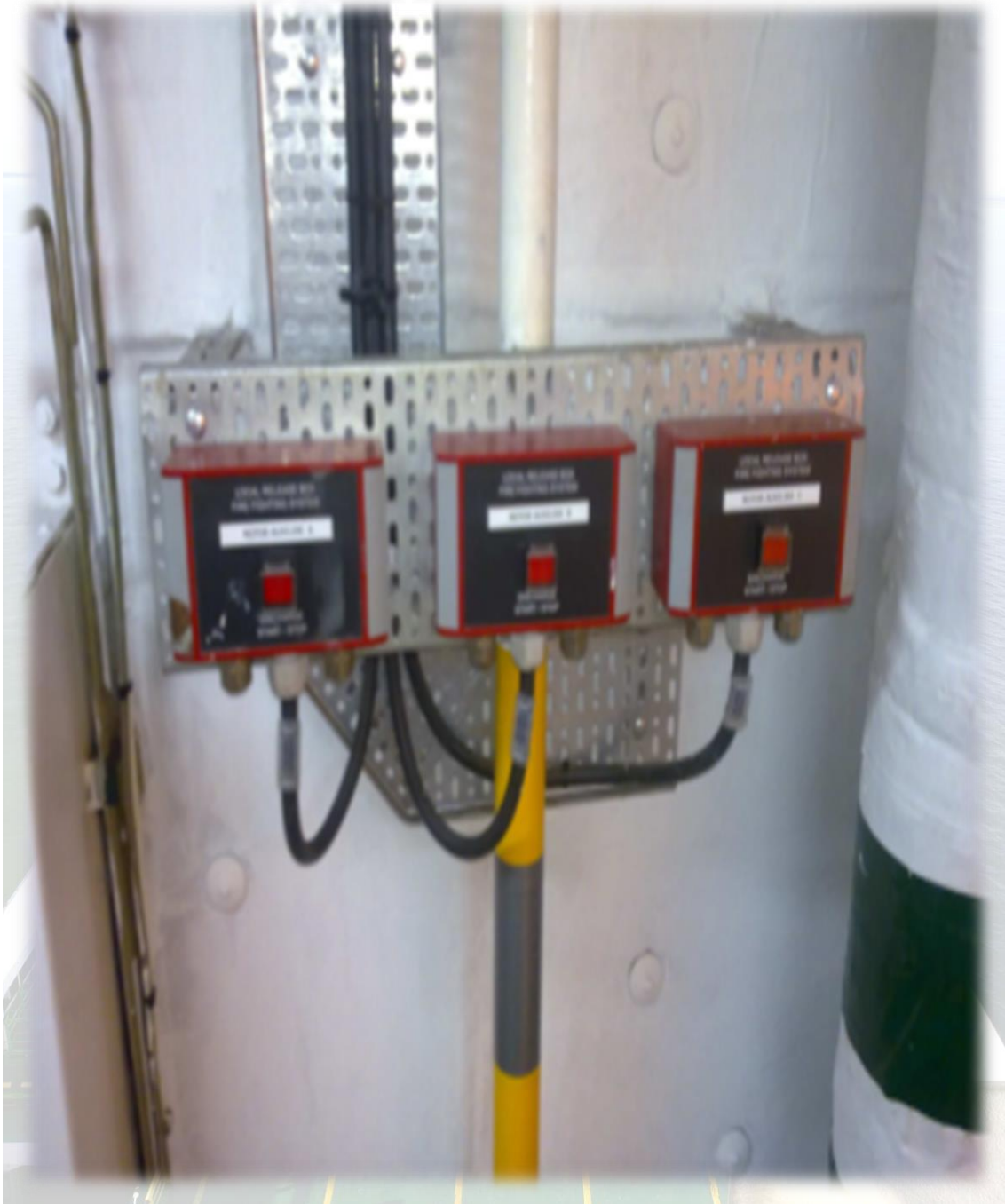
Ilustración 68. Botonera de arranque remoto de las bombas contraincendios. Fuente: Trabajo de campo.
