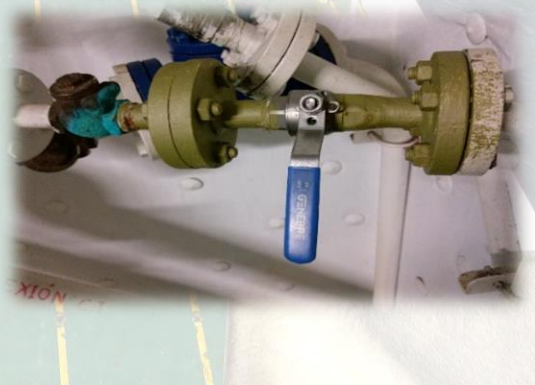
Ilustración 49. Línea de aire comprimido para limpieza de tubería tras su uso, previo paso de abertura de línea de agua dulce. Trabajo de campo.
