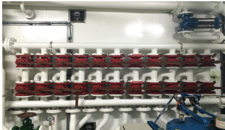
Ilustración 24. Piano de válvulas adaptadas para la operación de trasiego. Fuente propia
