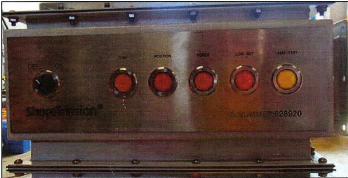
Figura 74: Luces de alarma en el sistema ShoreTension. Fuente [28]
