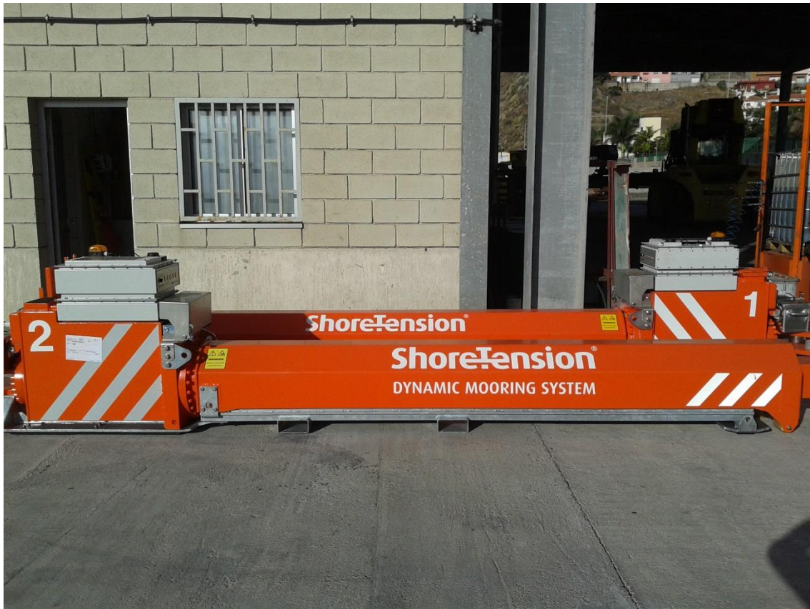
Figura 22: Sistema ShoreTension en la terminal TCT (Terminal de contenedores). Fuente: [28]
