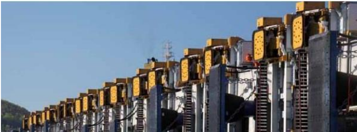
Figura 13: Instalación en puerto del sistema de vacío. Fuente: [4]
